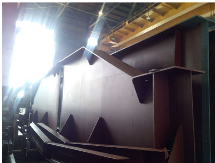
Рисунок 1.4 Подкрановая балка с переломом пояса
