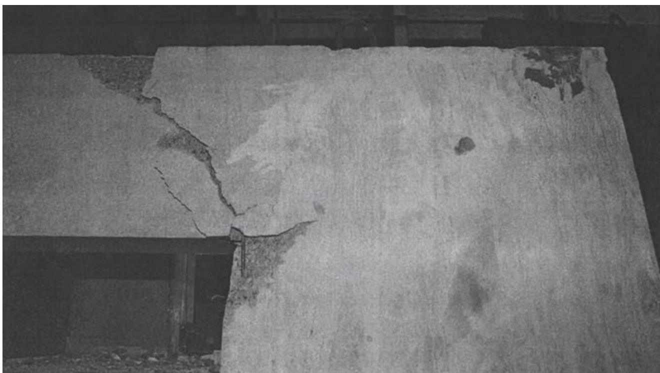
Рис.2.1.2.3. Вид разрушения фасадной стороны панели 1НС32.30-2 при нагружении №2 (пролет панели под силой Q_2 )
