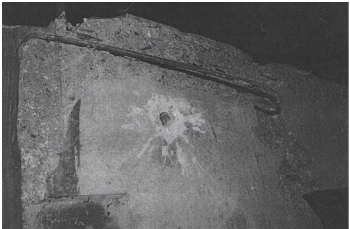
Рис.2.1.2.4. Вид разрушения несущей стороны панели 1НС32.30-2 при нагружении №2 (пролет панели под силой Q_2 )
