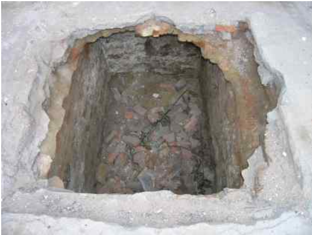
Фото 13. Разрушение конструкции пола в трапезной.
