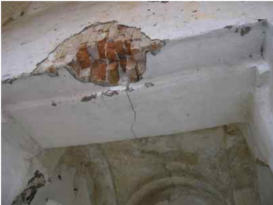
Фото 14. Выкрашивание раствора на глубину до 20 мм, высолы раствора, выпадение отдельных кирпичей, отсутствие/разрушение штукатурного слоя.
