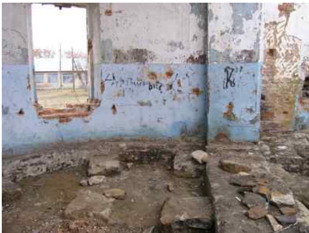
Фото 2. Отсутствие конструкции полов. Отсутствие/разрушение штукатурного слоя. Разрушение кирпичной кладки оконного проема.
