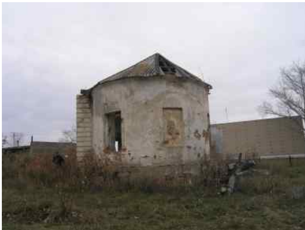
Фото 7. Выветривание кирпича, выкрашивание раствора на глубину до 20 мм, высолы раствора, отсутствие/разрушение штукатурного слоя. Разрушение оконного декора. Нарушение или отсутствие водослива у окон, разрыхление подоконных поясков. Заложен оконный проем.
