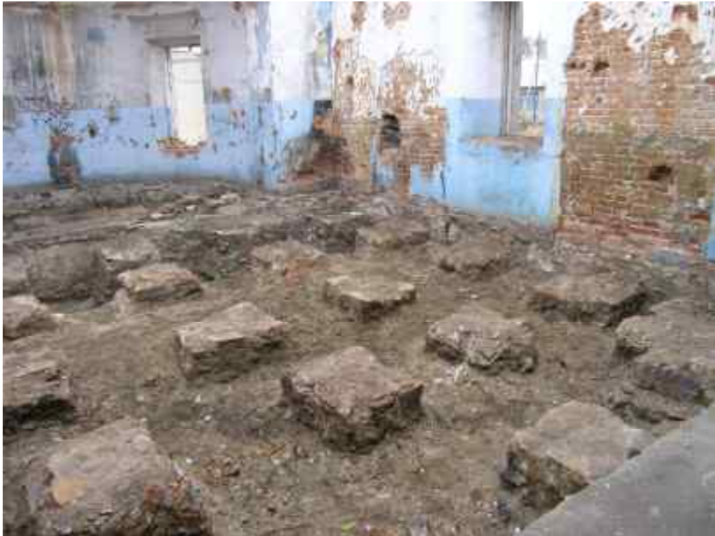
Фото 9. Выветривание кирпича, выкрашивание раствора на глубину до 20 мм, высолы раствора, выпадение отдельных кирпичей, отсутствие/разрушение штукатурного слоя. Отсутствие конструкции полов.
