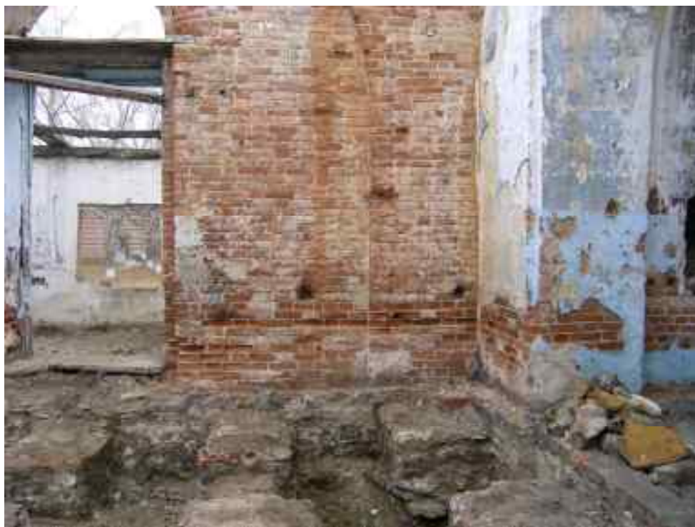
Фото 3. Отсутствие конструкции полов. Выветривание кирпича, выкрашивание раствора на глубину до 20 мм, высолы раствора. Отсутствие/разрушение штукатурного слоя. Разрушение кирпичной кладки.
