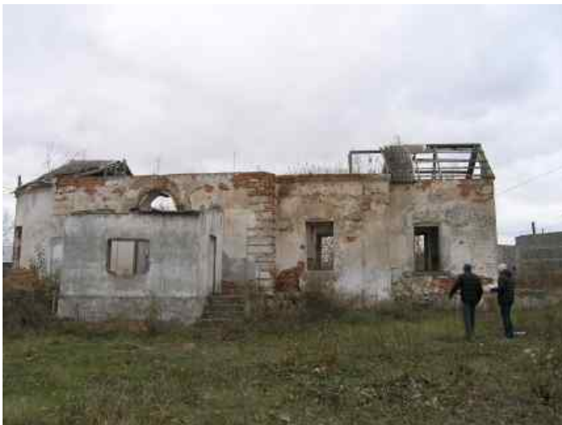
Фото 5. Отсутствие кровли, стропильной системы.
