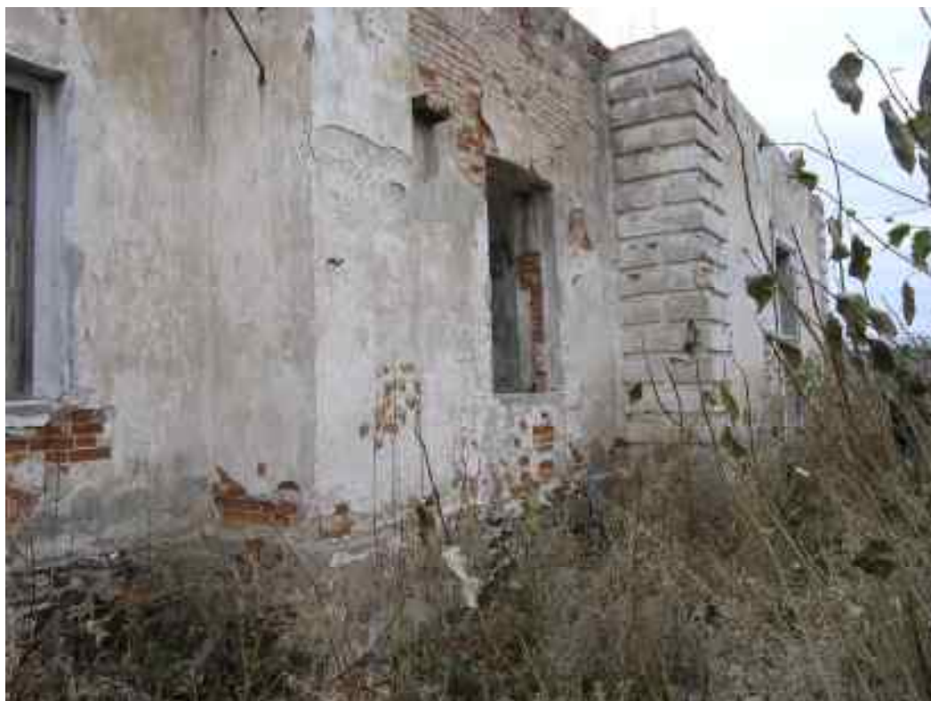
Фото 1. Отсутствие отмостки, отсутствие гидроизоляции. Выщелачивание солей из раствора. Выветривание кирпича. Отсутствие/разрушение штукатурного слоя.
