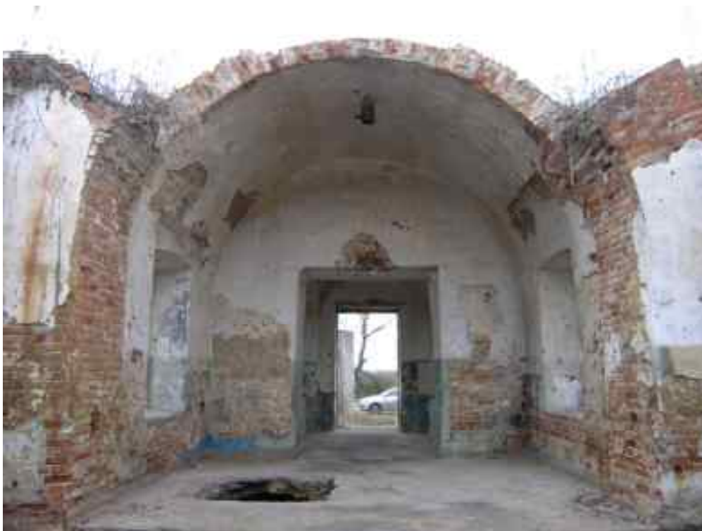
Фото 8. Выветривание кирпича, выкрашивание раствора на глубину до 20 мм, высолы раствора, выпадение отдельных кирпичей, отсутствие/разрушение штукатурного слоя. Отсутствие кровли, стропильной системы и перекрытия.
