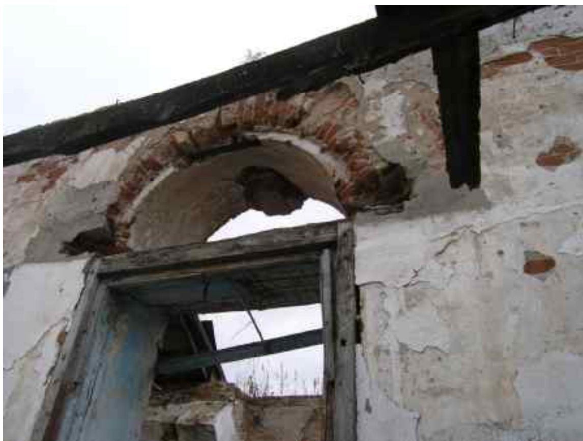
Фото 6. Выветривание кирпича, выкрашивание раствора на глубину до 20 мм, высолы раствора, выпадение отдельных кирпичей, отсутствие/разрушение штукатурного слоя.
