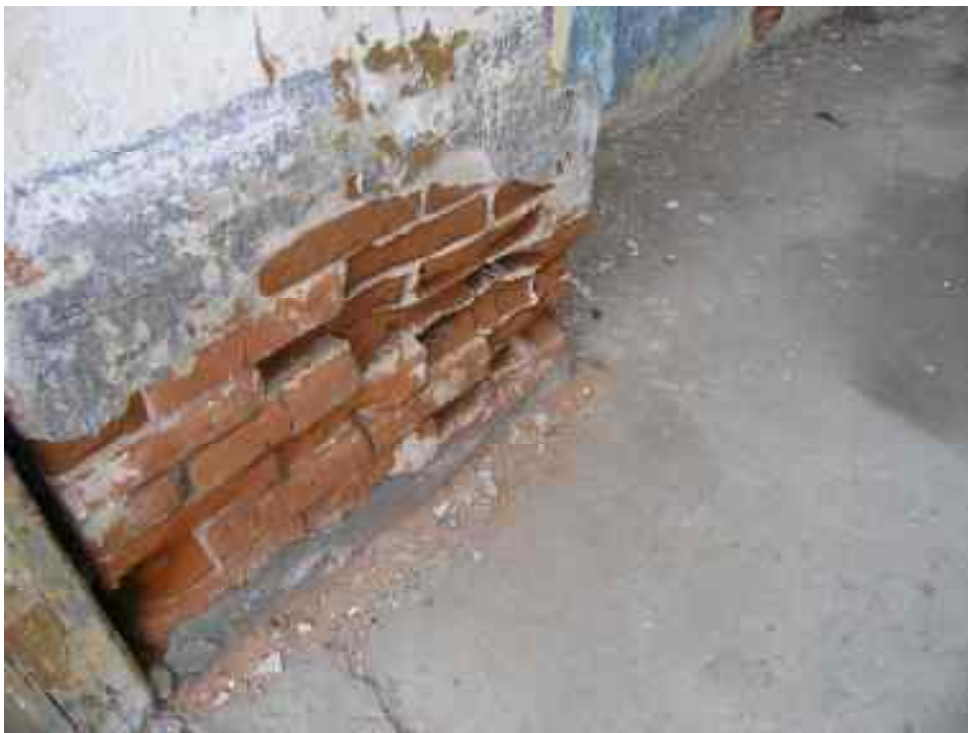
Фото 10. Выветривание кирпича, выкрашивание раствора на глубину до 20 мм, высолы раствора, выпадение отдельных кирпичей, отсутствие/разрушение штукатурного слоя.
