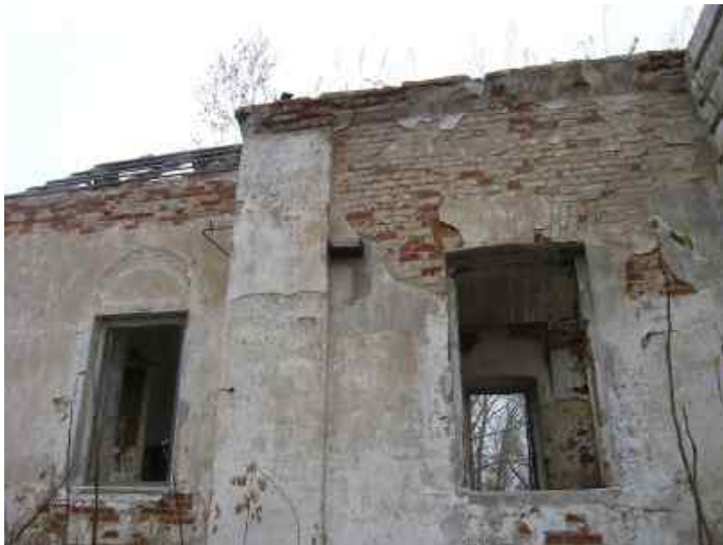
Фото 11. Выветривание кирпича, выкрашивание раствора на глубину до 20 мм, высолы раствора, выпадение отдельных кирпичей, отсутствие/разрушение штукатурного слоя. Разрушение/отсутствие карнизных плит. Разрушение оконного декора.
