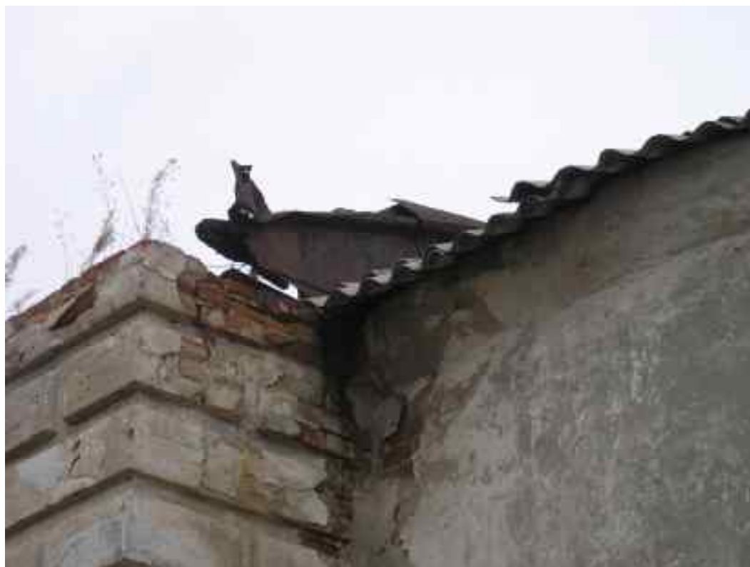
Фото 12. Выветривание кирпича, выкрашивание раствора на глубину до 20 мм, высолы раствора, выпадение отдельных кирпичей, отсутствие/разрушение штукатурного слоя. Разрушение/отсутствие карнизных плит.
