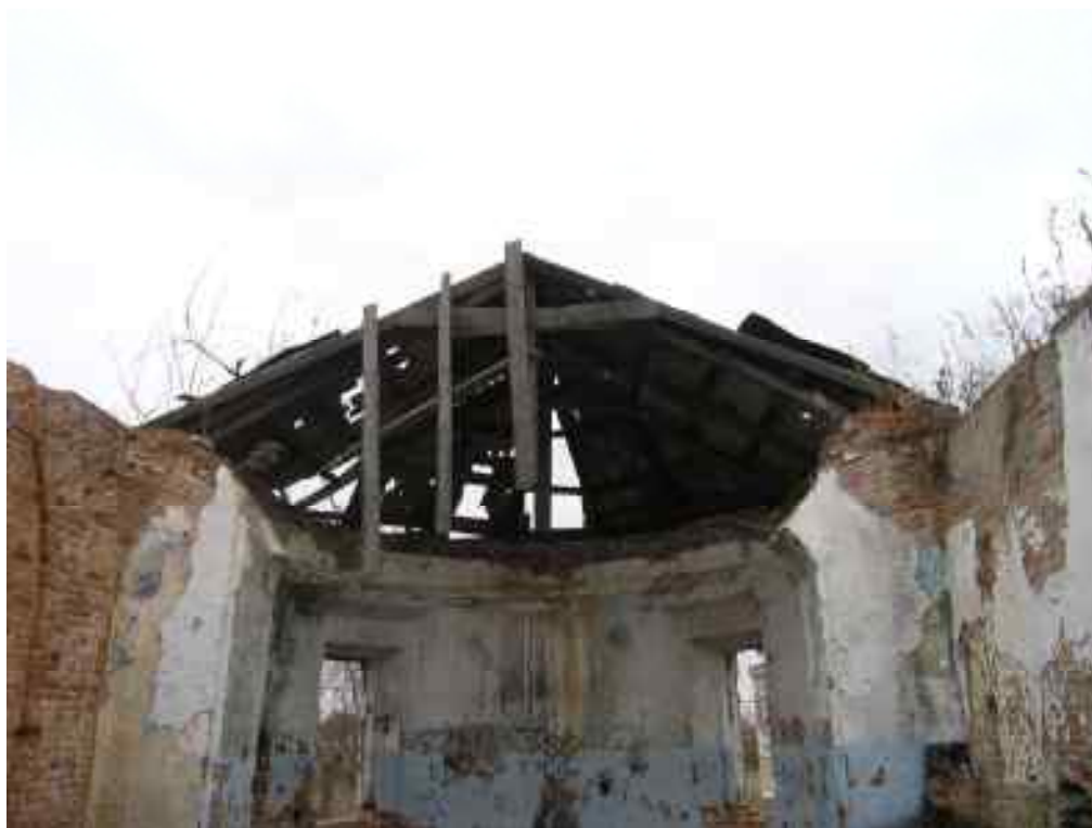
Фото 4. Отсутствие кровли, стропильной системы и перекрытий над храмовой и алтарной частями.
