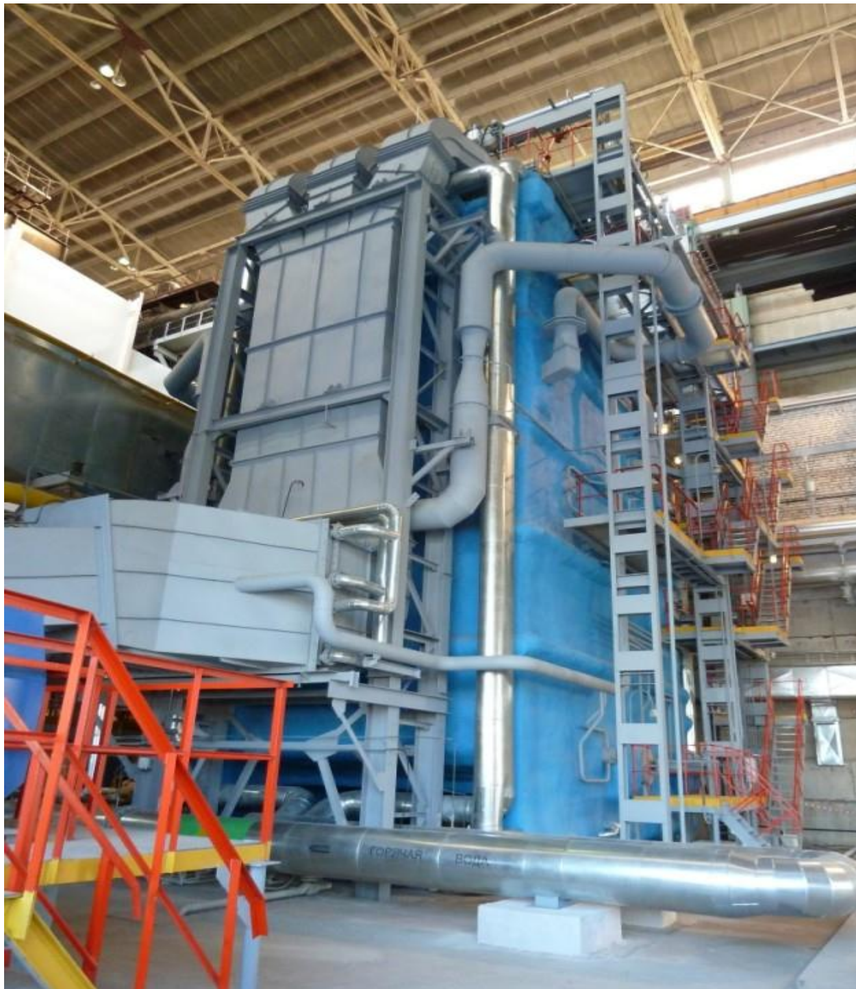
Рисунок 2.1 – Внешний вид котла КВГМ-30
