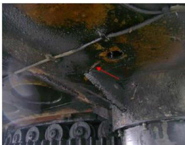
в) Трещины по основному металлу и по ремонтным сварным швам нижнего листа платформы, в районе ступиц поворотных шестерен
