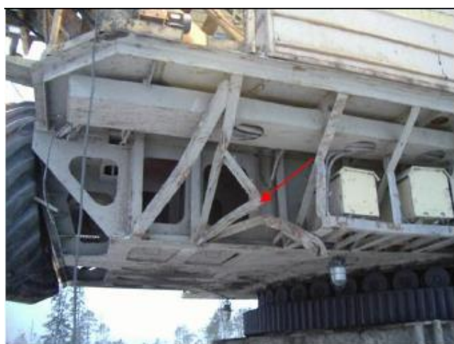
г) Трещины, деформации силовых элементов рабочих площадок
