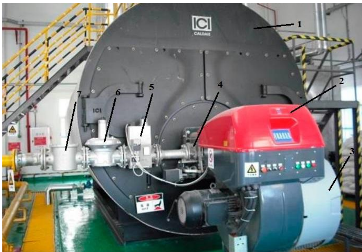
Рисунок 3 – Оборудование газовой котельной: 1 – газовый котел; 2 – пульт управления; 3 – нагнетатель воздуха газовой горелки; 4 – газовый дроссель; 5 – электромагнитный клапан; 6 – регулятор давления газа, 7 – фильтр газа.
