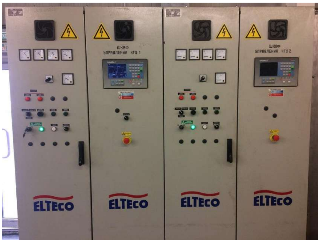
Рисунок 13 – Шкафы управления энергоцентром
