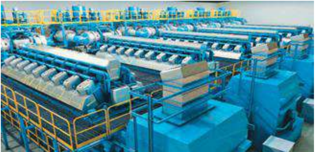
Рисунок 3 – Энергоблоки Wartsila 50SG
