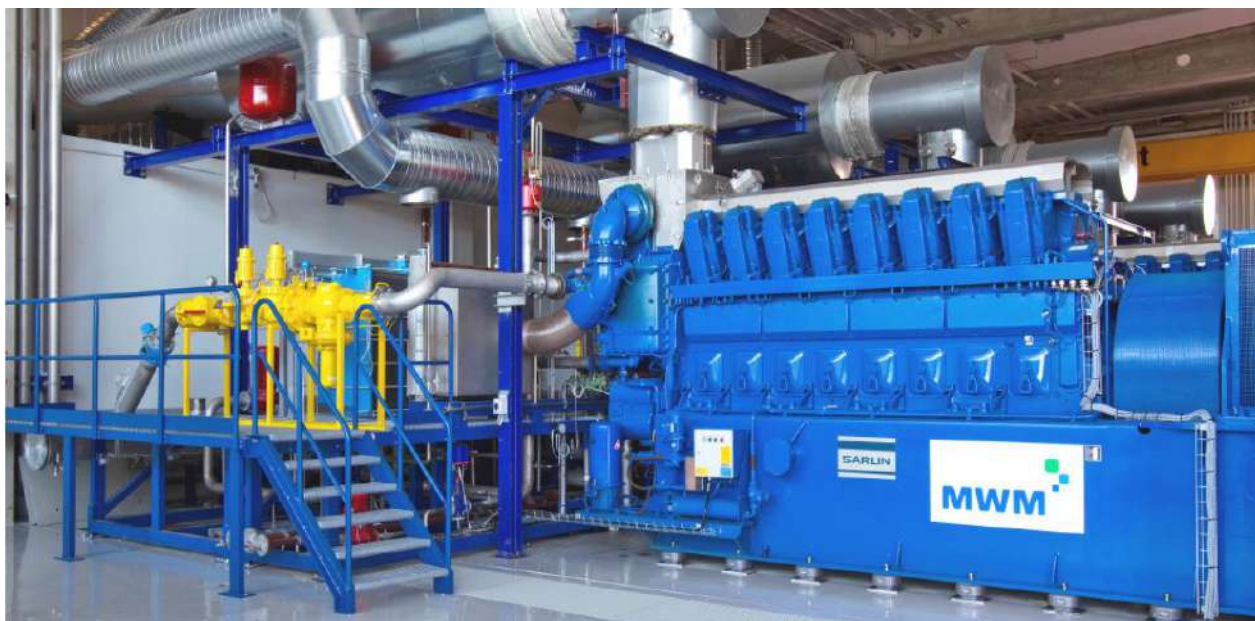
Рисунок 2 - Когенераторная установка фирмы MWM
