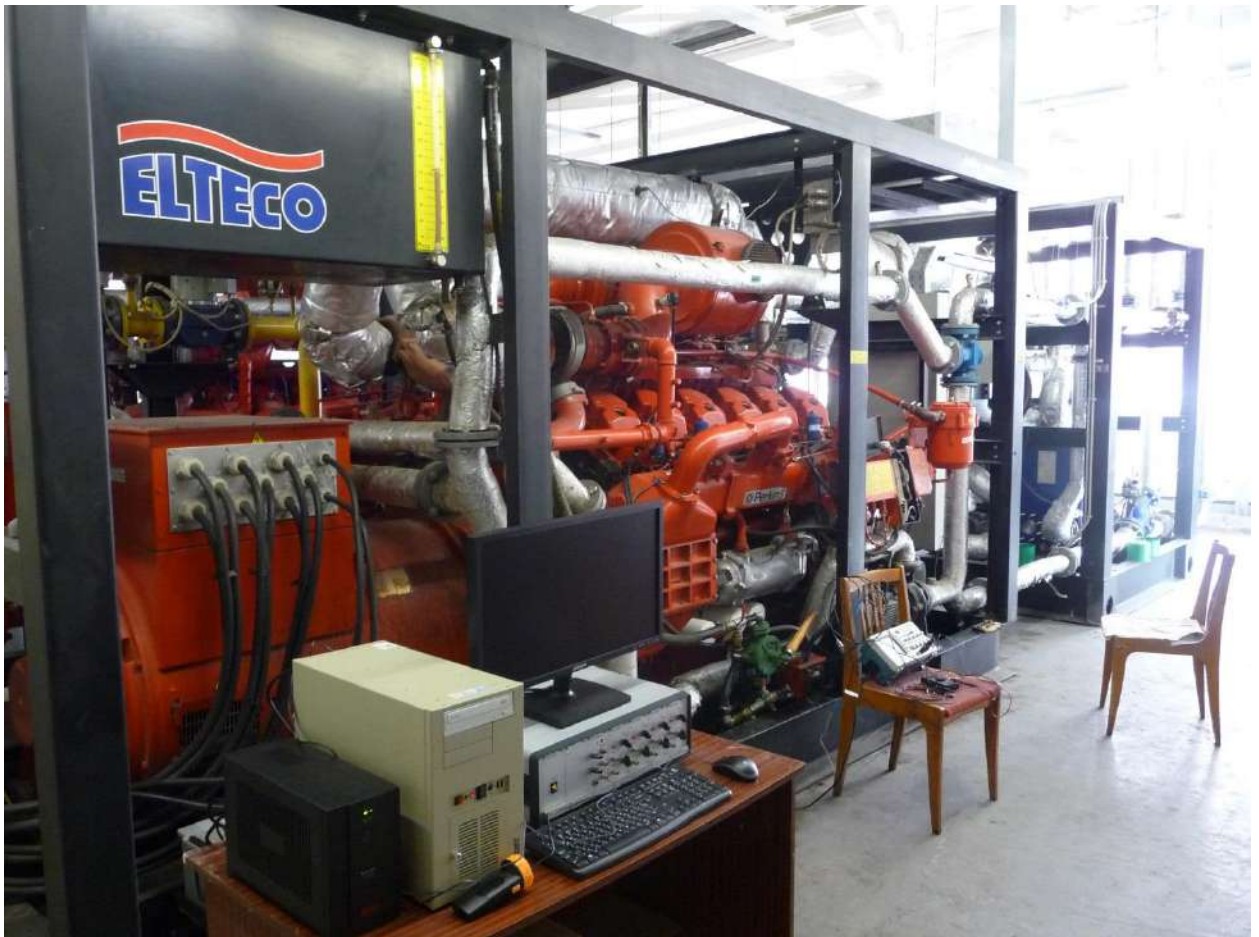
Рисунок 20 – Рабочее место оператора аппаратуры измерения давления «Нейва 10000» в энергоцентре ЮУрГУ
