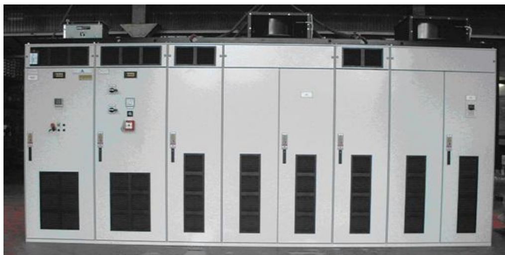
Рисунок Б.1 – Внешний вид шкафов тиристорного преобразователя (инвертора) и системы управления СТАТКОМ
