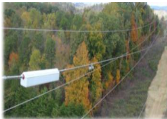
Рисунок Б.6 – Устройство технологии SmartWire, установленное на ЛЭП, США
