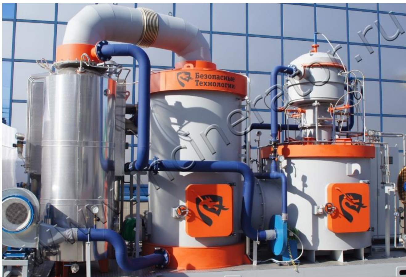
Рисунок 3.6 – Инсинераторная установка Shark
