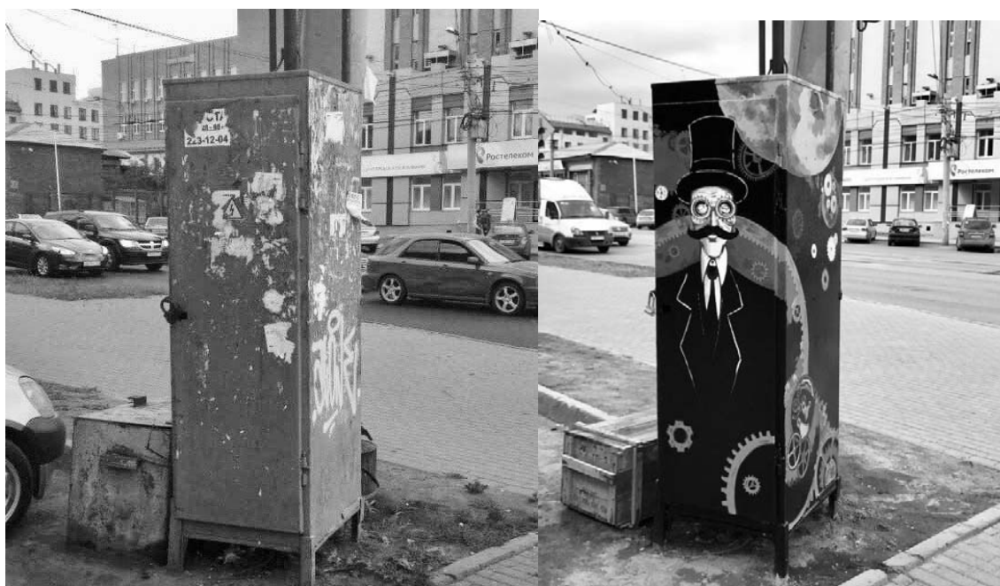
Рисунок 29 – Трансформаторный шкаф, Челябинск
