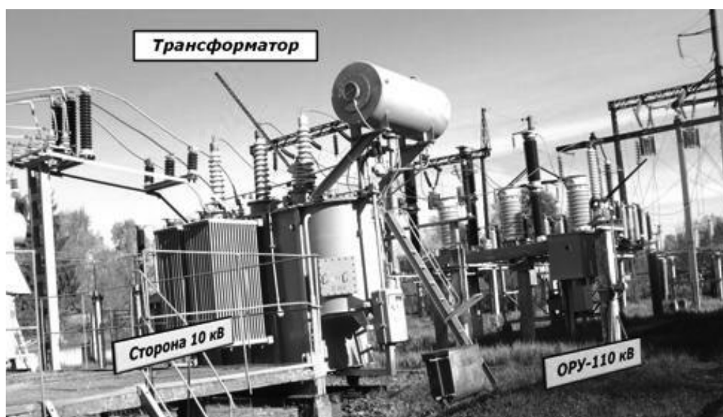
Рисунок 1.5 – Силовой трансформатор 110/10 кВ
