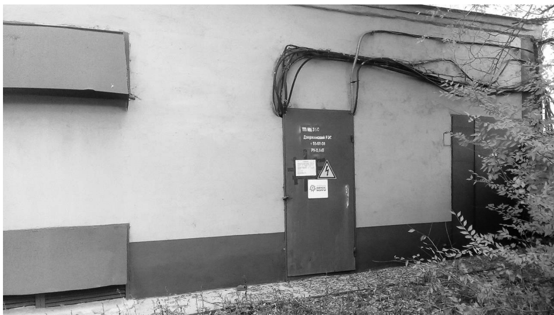
Рис. 1.2 ТП №350 в Дзержинском районе
