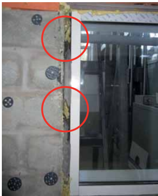
Рис.3.1.6. Изображение испытуемой модели (Расхождение граней в стыке между блоками, с разрушением связующего клеевого состава, прямоугольной формы, толщиной 10 мм, высота 140 мм, глубина 190 мм. Наличие в пенном шве пустот в количестве 2шт, габаритными размерами 80х30х140 мм) до помещения в камеру.
