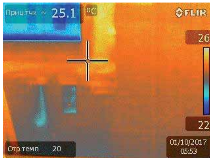
Рис.3.1.19. Показания с тепловизора (Фрагмент Рис.3.1.18.)
