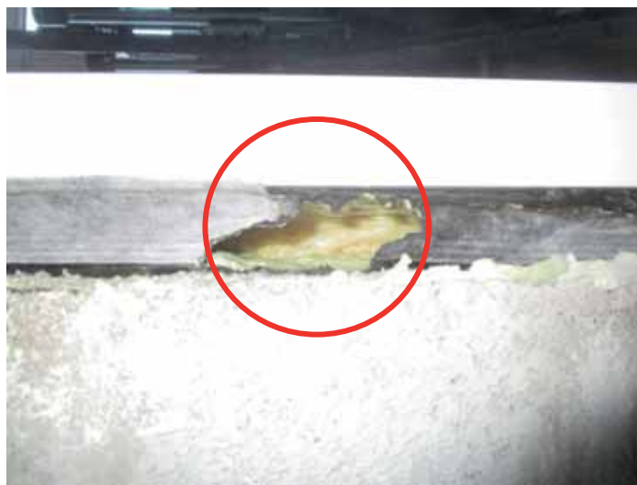
Рис.3.1.6. Дефект в пенном шве (Фрагмент Рис.3.1.5.)
