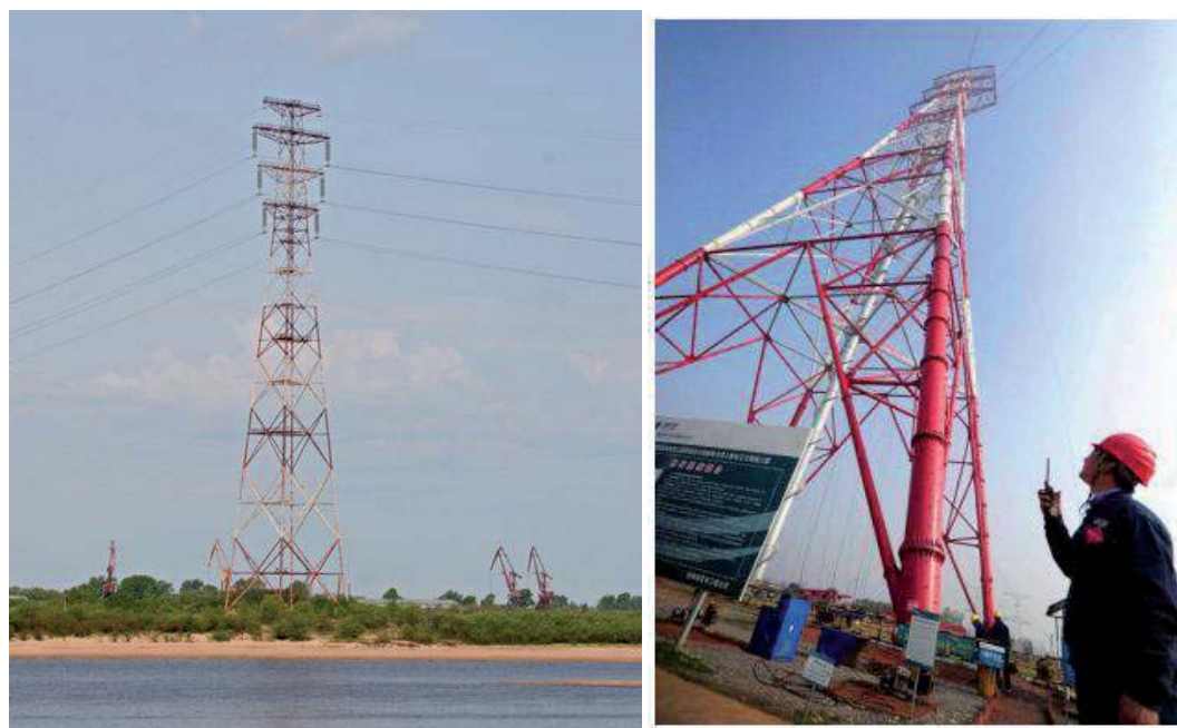
Рисунок 1.2 – опора ЛЭП 220 кВ на острове Дамао, Китай
