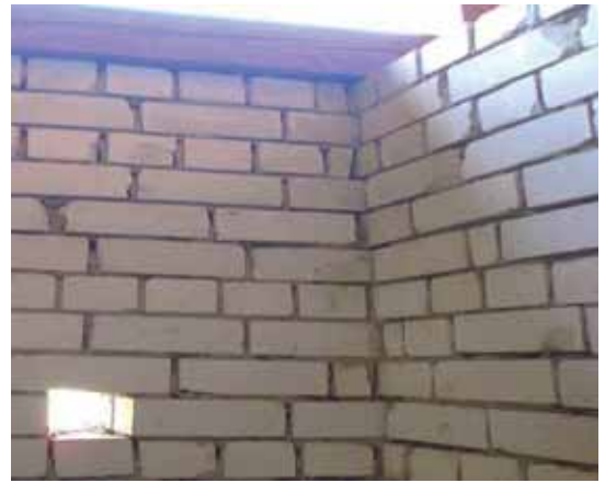
Рис.2.2.2 Отклонение от вертикали кирпичной стены
