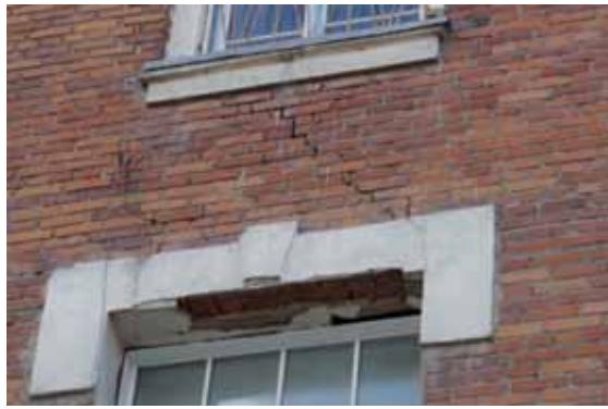
Рис.2.2.1. Трещины в стенах и перемычках кирпичных стен
