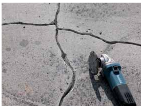
Рис.2.2.8. Трещины на поверхности железобетонных стеновых панелей
