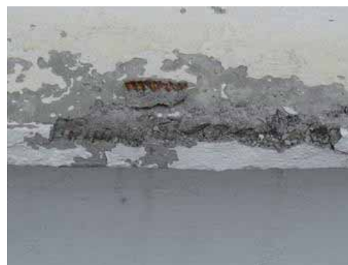
Рис.2.2.11. Разрушение защитного слоя железобетонных стен
