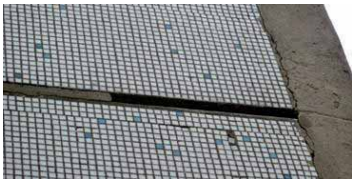
Рис.2.2.10. Разрушение стыков железобетонных стен
