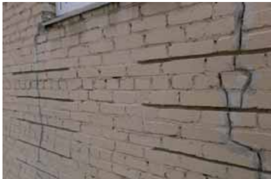
Рис.2.2.3. Перекосы в кирпичной кладки
