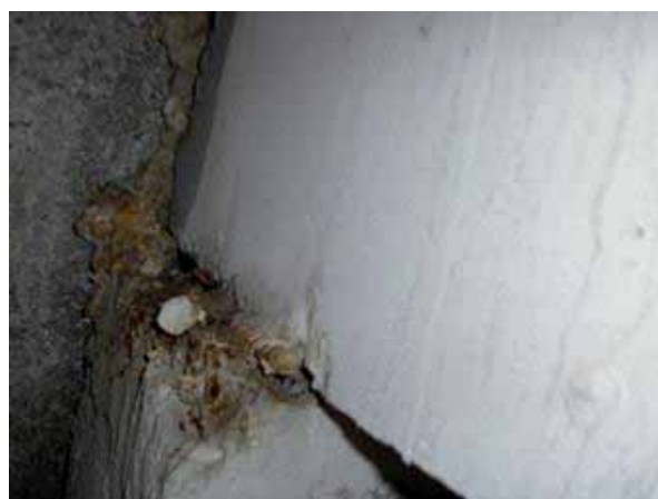
Рис.2.2.9. Коррозия закладных деталей в местах стыков
