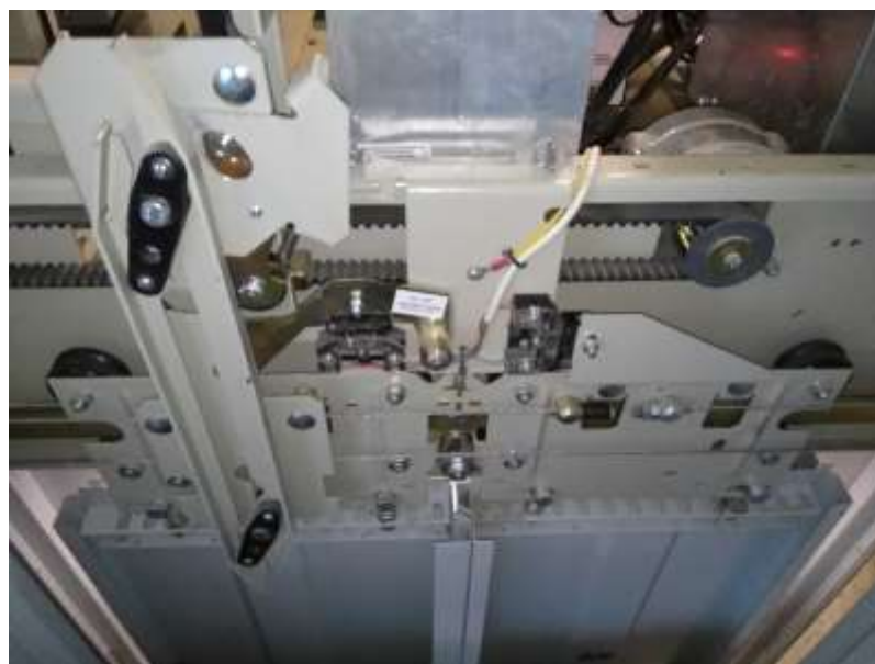
Рисунок 20 – Верхняя часть дверей кабины
