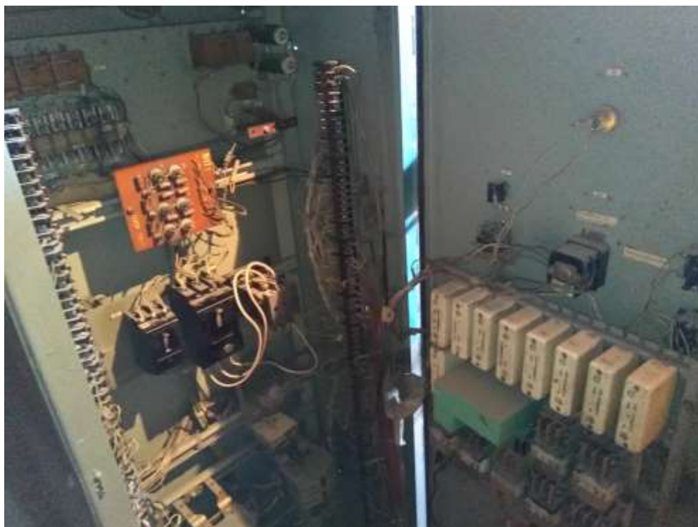
Рисунок 7 – Станция управления пассажирского лифта
