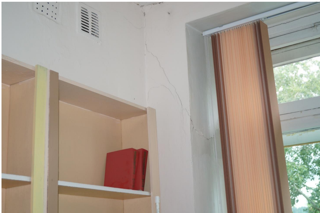
Рисунок 6 – Трещина внутри третий этаж.
