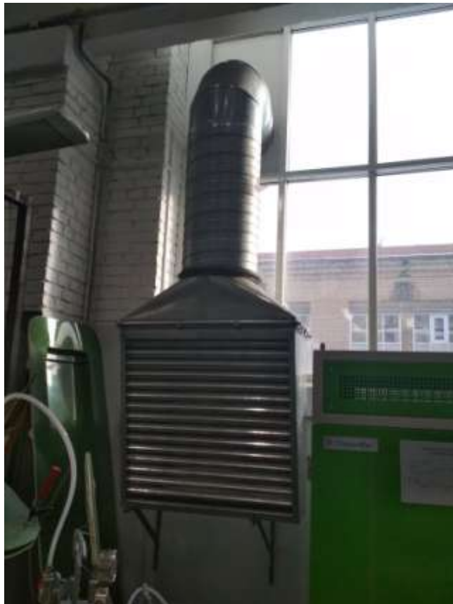
Рисунок 14 – Местная вытяжная вентиляция
