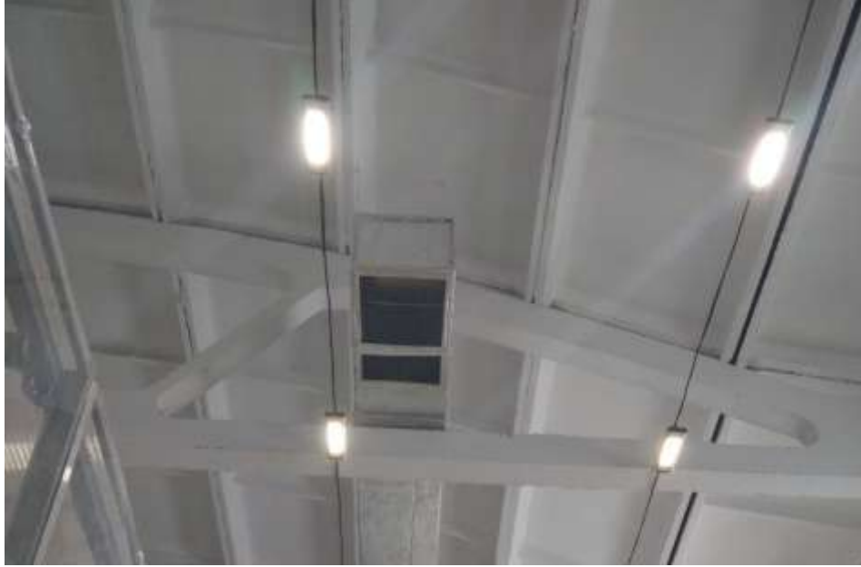
Рисунок 13 – Общеобменная вытяжная вентиляция
