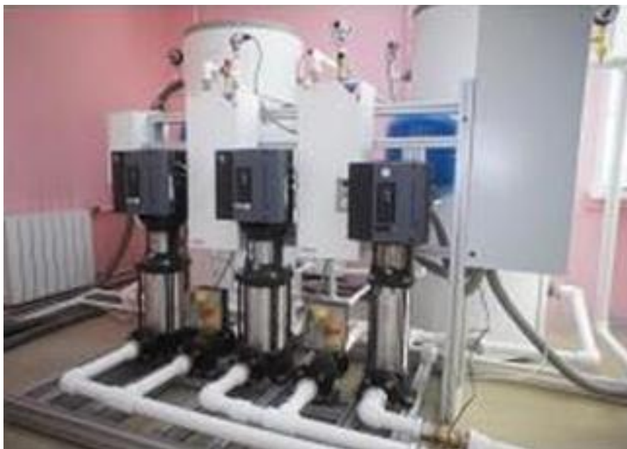
Рисунок 1.1 – Первая часть стенда гидропроливочных испытаний
