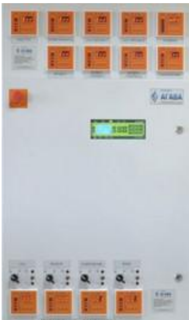
Рисунок 7.5 – Щит КИПиА котла ДЕ-10-14-225-ГМО
