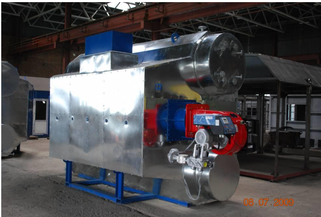
Рисунок 3.10 – Газовый водогрейный котел ГМ-50 с установленным частотно-регулируемым приводом электродвигателя вентилятора
