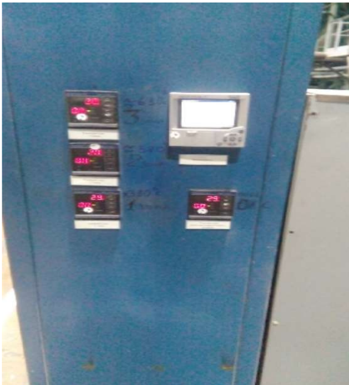
Рисунок 1.7 Щит КИПиА агрегата АИЭП № 1
