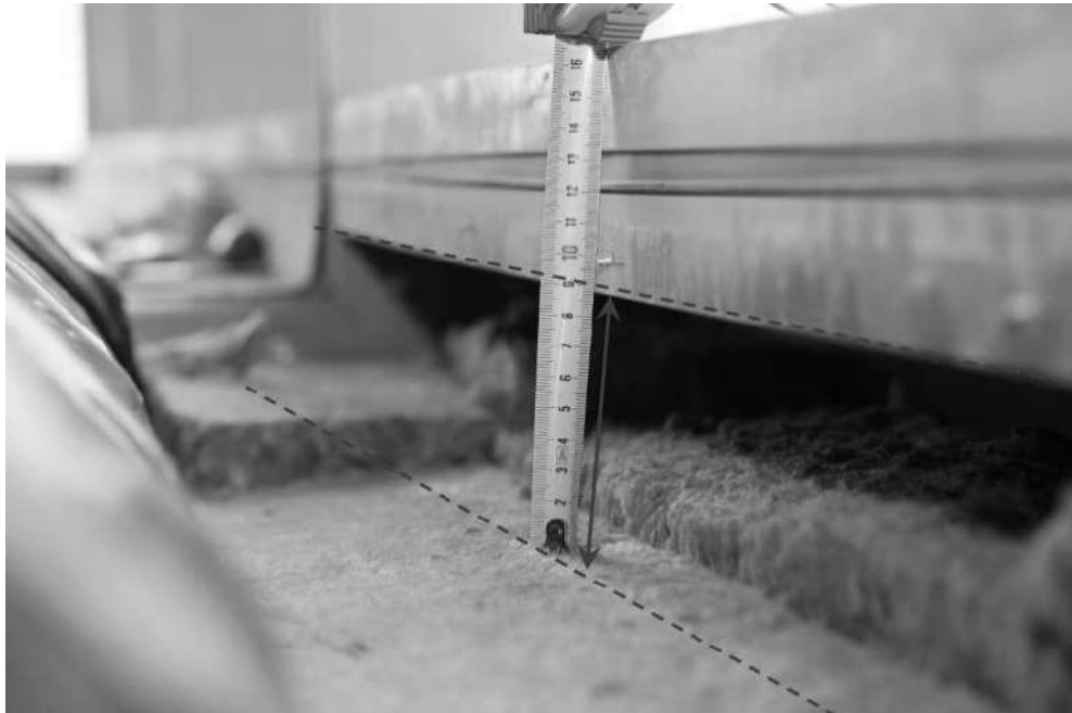
Рисунок Д.13 Непроектная установка утеплителя
