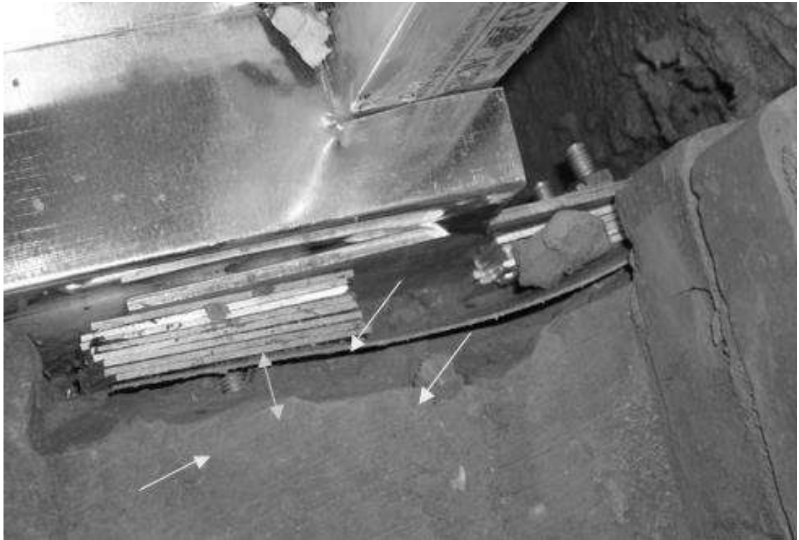
Рисунок Д.5 Установка кронштейна на основание, не обладающего достаточной прочностью
