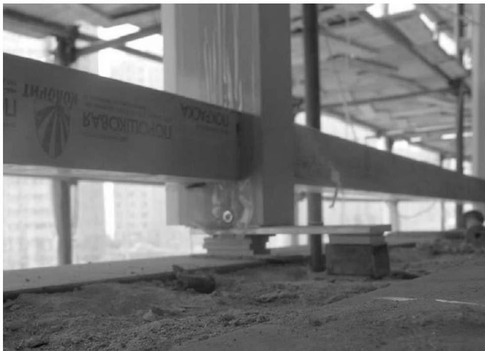
Рисунок Д.1 Отсутствие плотного прилегания пяток нижних кронштейнов витражей к стене-основе
