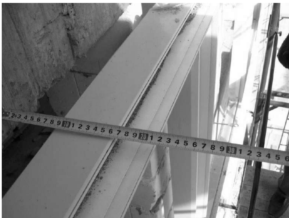
Рисунок Д.2 Непроектное расстояние между витражной стойкой и стеной основой
