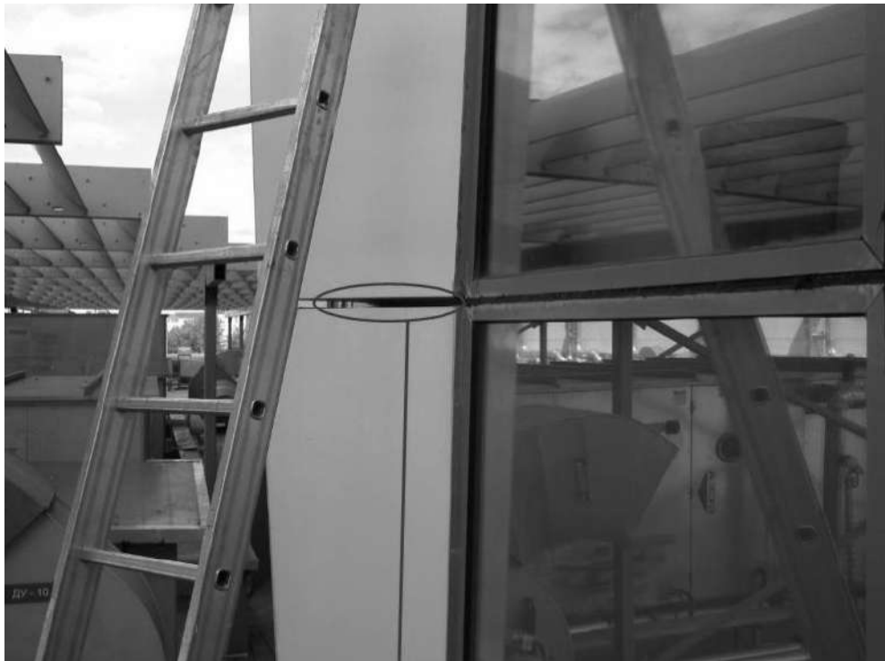
Рисунок Д.11 Некачественная установка уплотнителя
