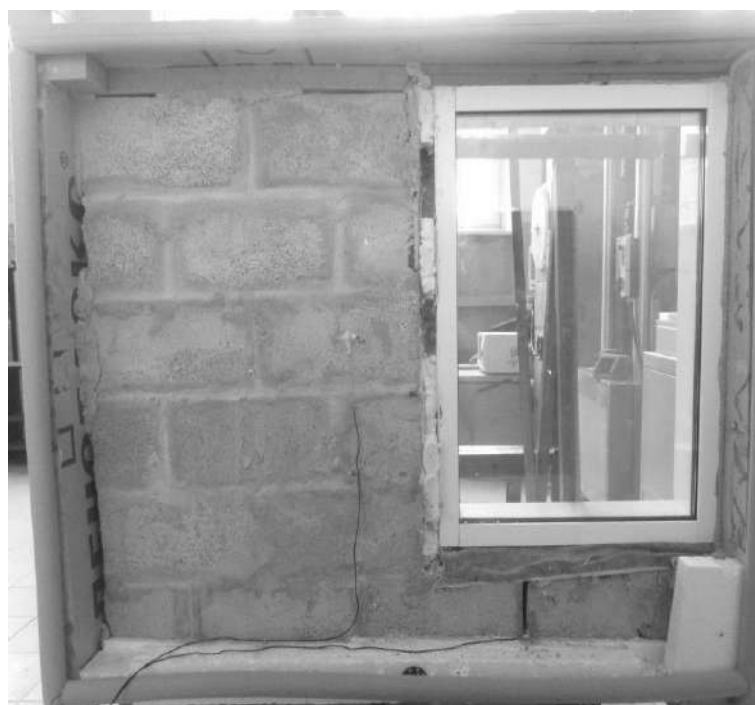
Рисунок 3.1.4.2 Исследуемый фрагмент без утепления с дефектами
