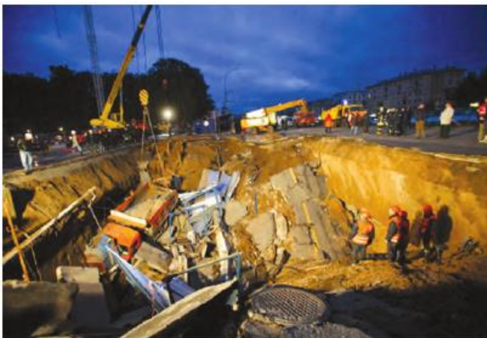
Рисунок 1 Провал грунта по адресу: г. Москва, Ленинградский проспект, д. 30 (фото Н.Н. Ракитиной)
