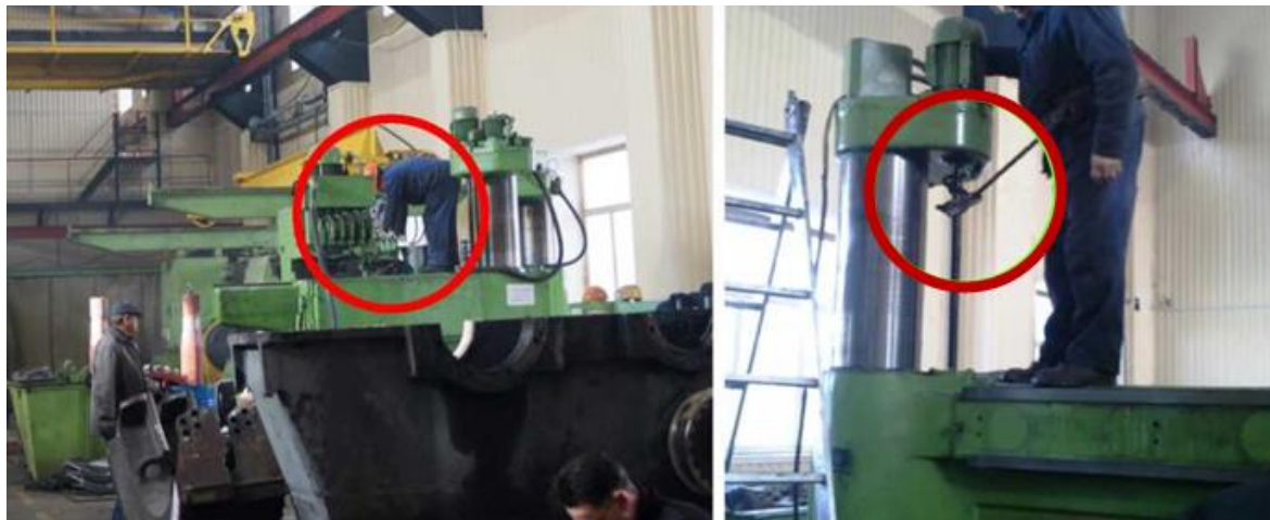
Рисунок 5.9 – Проведение работ на высоте при отсутствии специальных площадок и специальных страховочных приспособлений
