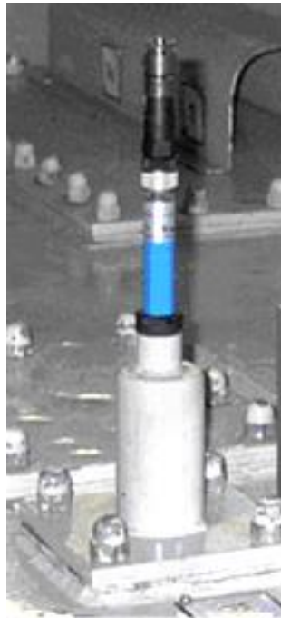
Рисунок 1.12 – Датчик уровня масла в расширителе трансформатора и РПН
