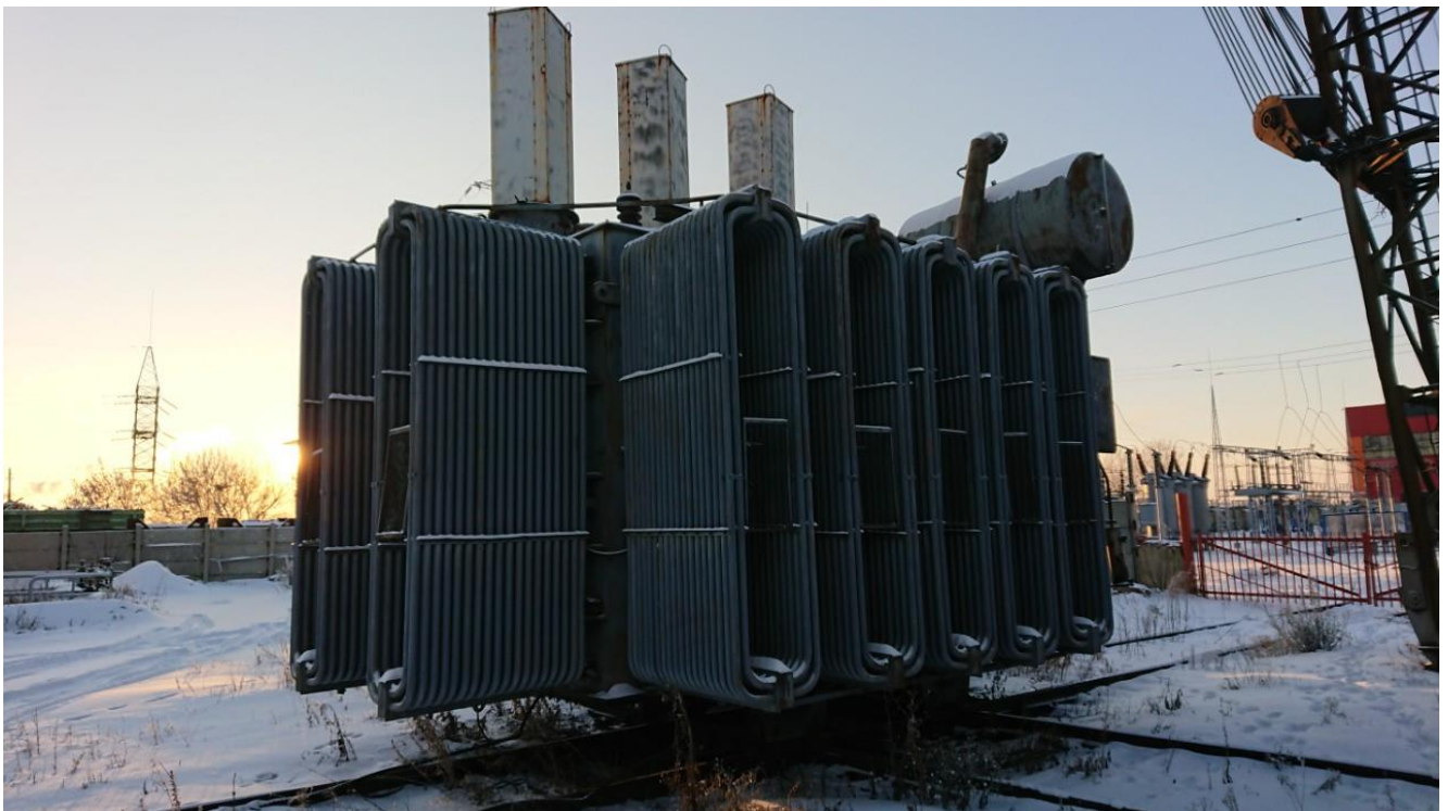
Рисунок 1 – Силовой трансформатор типа ТДТНГ-40500/110/35/6
