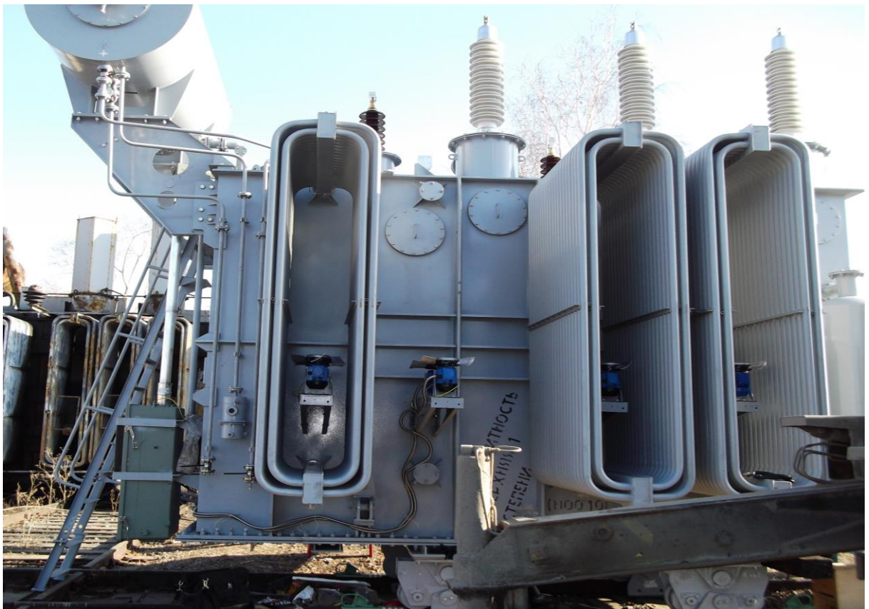
Рисунок 1 – Силовой трансформатор ТДТН-40000/110/35/6
