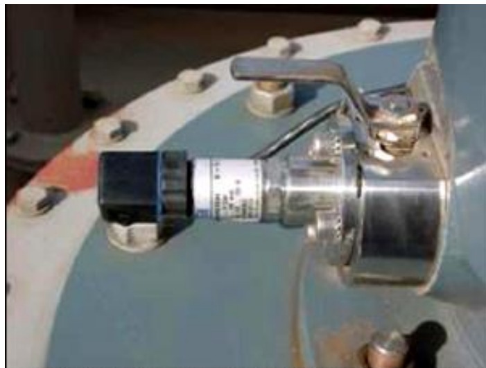
Рисунок 1.11 – Датчик давления масла во вводах трансформатора
