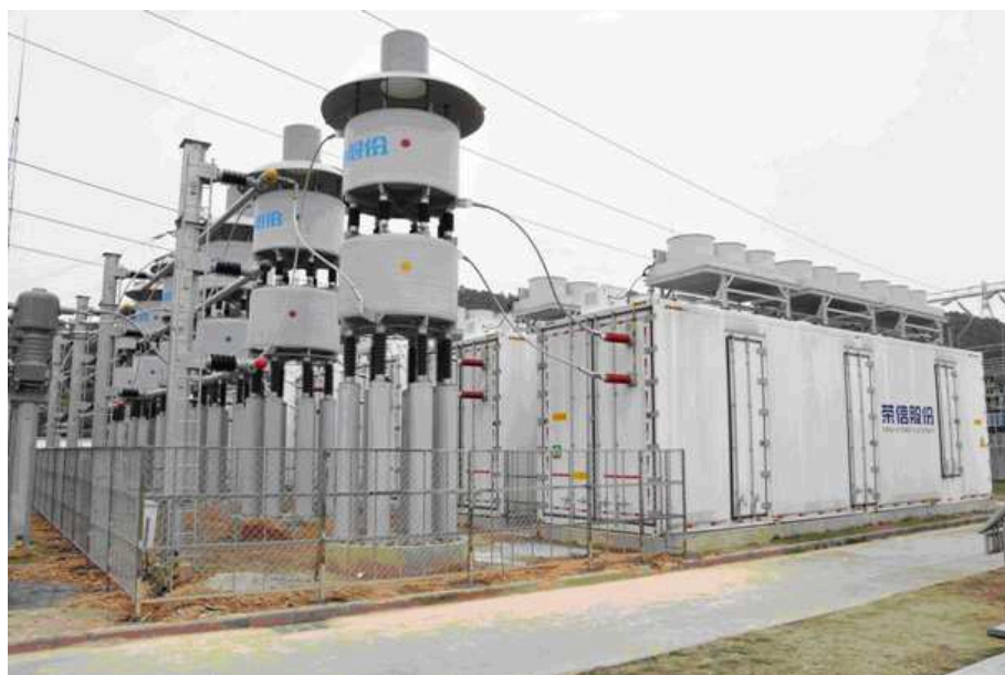
Рисунок 24 – Общий вид установки СТАТКОМ
