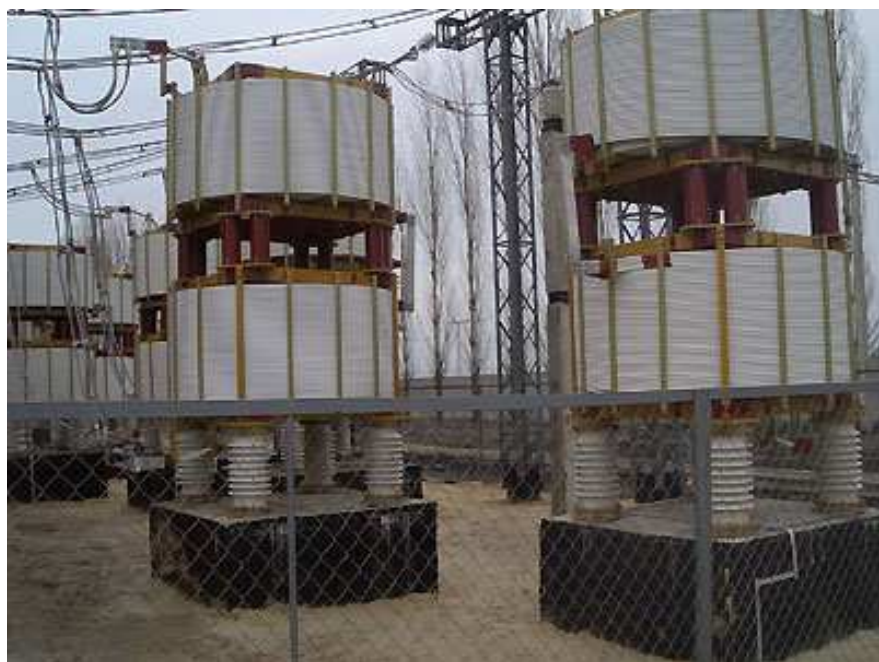
Рисунок 16 – Шунтирующие реакторы на подстанции
