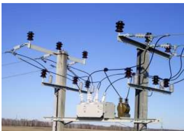
Рисунок 13 – Реклоузер на ВЛ 10 кВ
