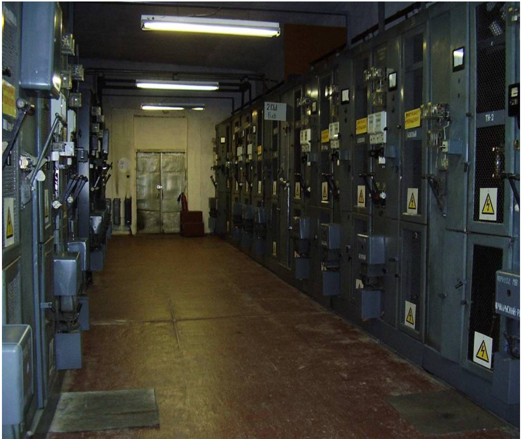
Рисунок 17 – Закрытое распределительное устройство
