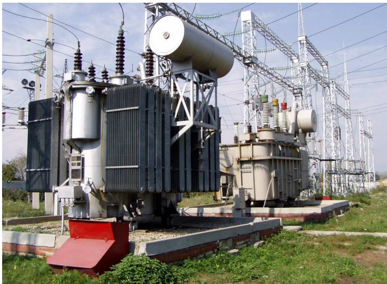
Рисунок 14 – Трансформаторы КТРН-10/110/35/6 и ТДТН-10/110/35/6
