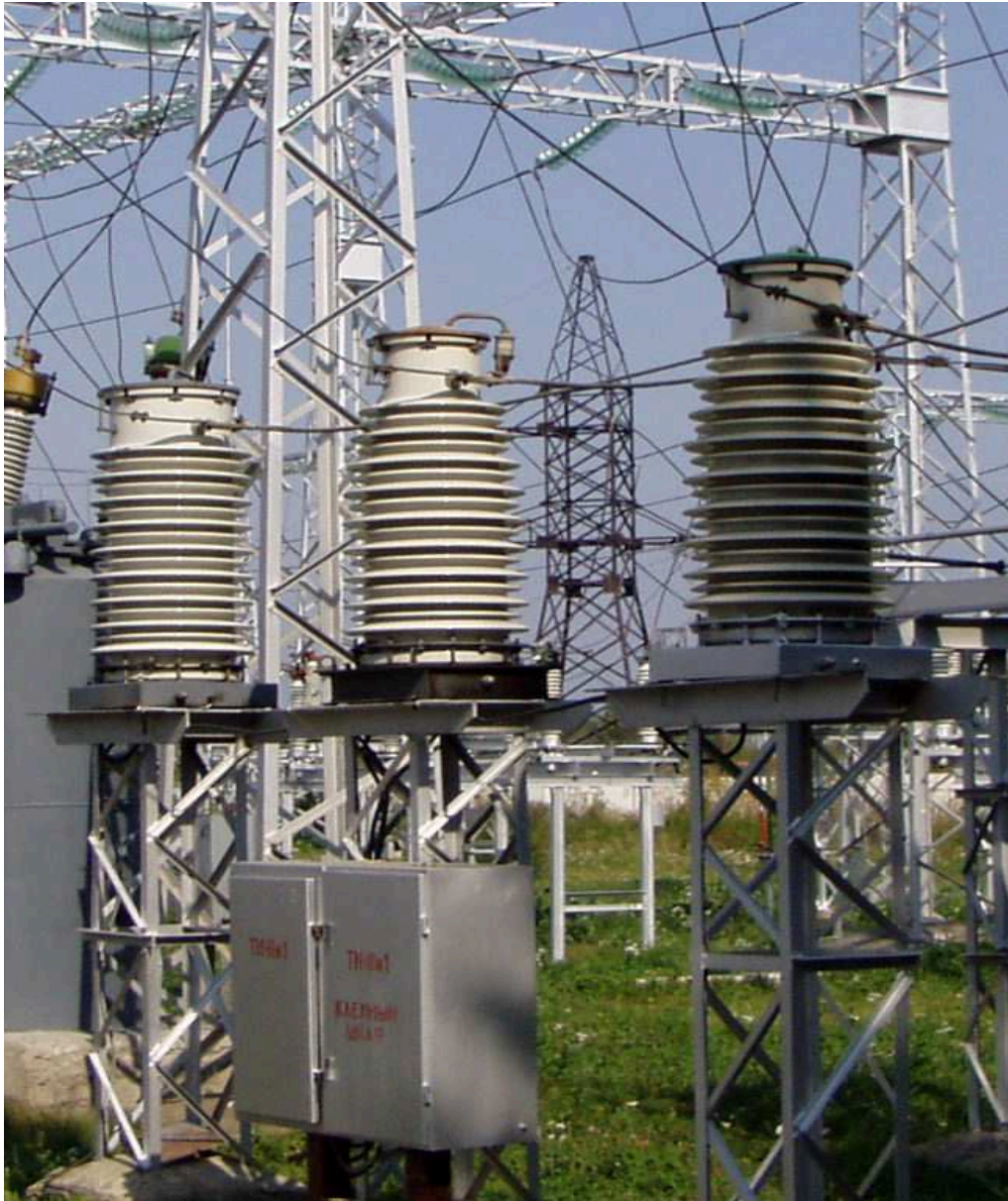
Рисунок 36 – Внешний вид трансформатора напряжения НКФ
