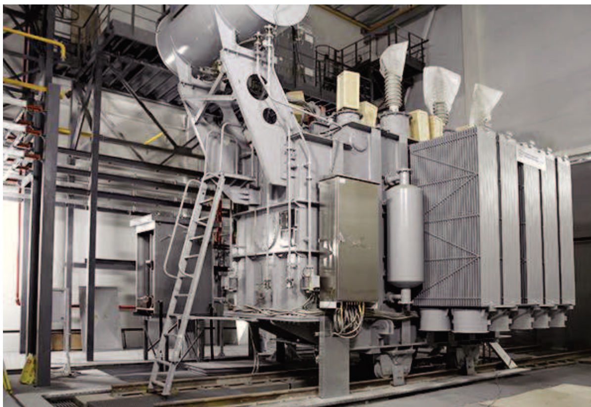
Рис 3.7 Трансформатор напряжения 110/20 кВ , расположенный внутри здания ПС
