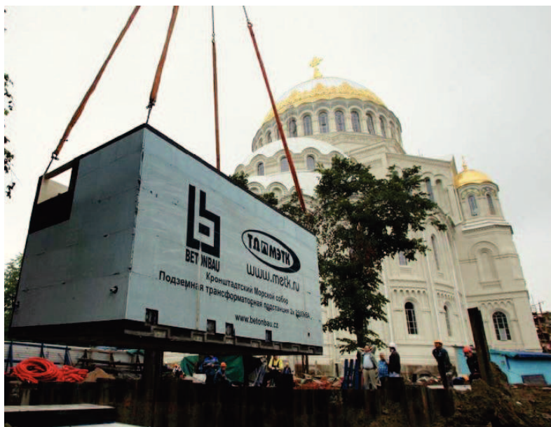
Рис 3.12 - Подземная трансформаторная подстанция
