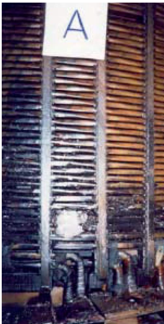
Рисунок 1.3 – Витковое замыкание в обмотке трансформатора
