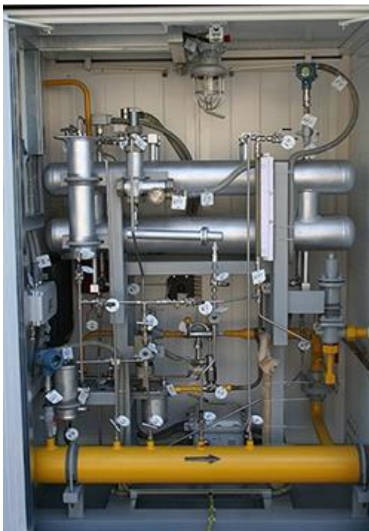
Рисунок 19 – Фото установки БАОГ смонтированной на выходном трубопроводе ГРС
