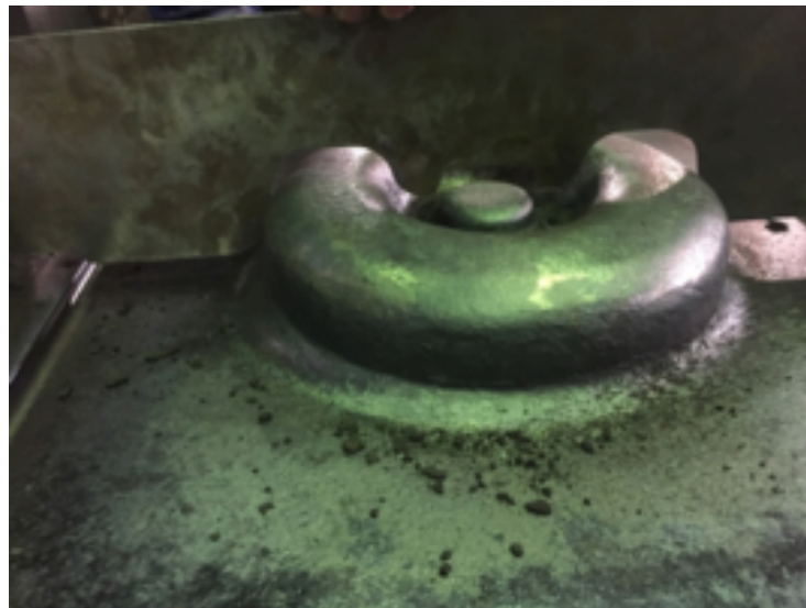
Рисунок 1.4 – Трещина в радиусном переходе хвостовика
