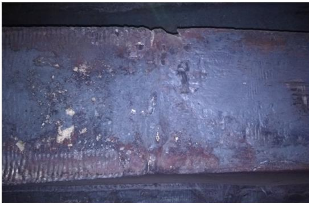
Рисунок 19 – поперечные поверхностные трещины (пояс)
