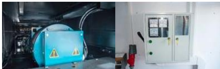
Рисунок 1.13 – Общий вид генератора и панели управления
