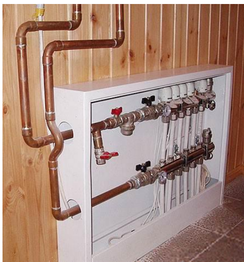
Рисунок 3.7 Коллекторный шкаф с автоматикой
