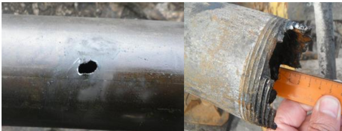
Рисунок 3.5 - Коррозионные повреждения до внедрения НКТ «ТС-3000F»
