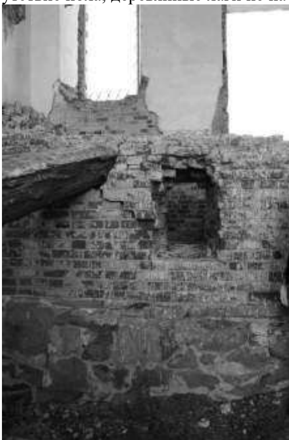
Фото 41. Косая трещина в кирпичной кладке фундамента храма, пересекающая более двух рядов кладки, остатки деревянной лаги, сколы бутового фундамента, частичное разрушение кирпичной кладки фундамента, отсутствие/разрушение штукатурного слоя
