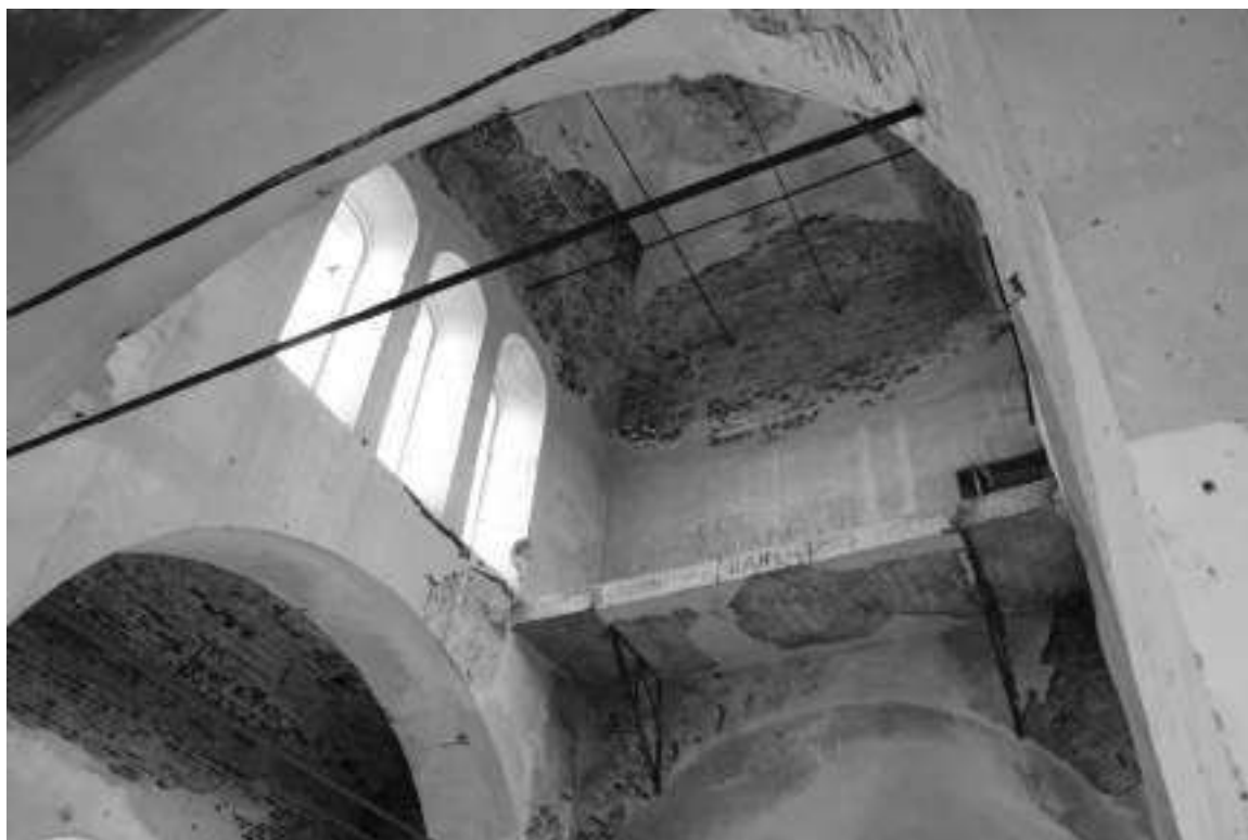
Фото 43. Разрушение, отсутствие штукатурного слоя на своде, поддерживающие хоры металлические уголки поражены ржавчиной
