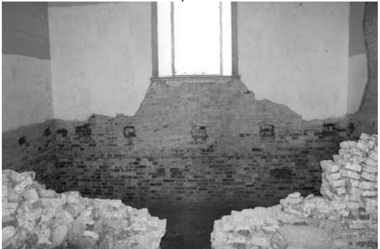
Фото 35. Локальное отсутствие, отслаивание штукатурного слоя на стенах нефы трапезной, высолы раствора, отсутствие пола, гнезда в стенах под лаги, остатки деревянного плинтуса, частичное разрушение кирпичной кладки фундамента, отсутствие оконного заполнения
