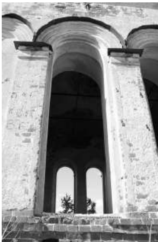
Фото 53. Выветривание штукатурного слоя, высолы раствора, выветривание кирпича подоконной части, отсутствие оконного заполнения, деформация металлического обрамления окна
