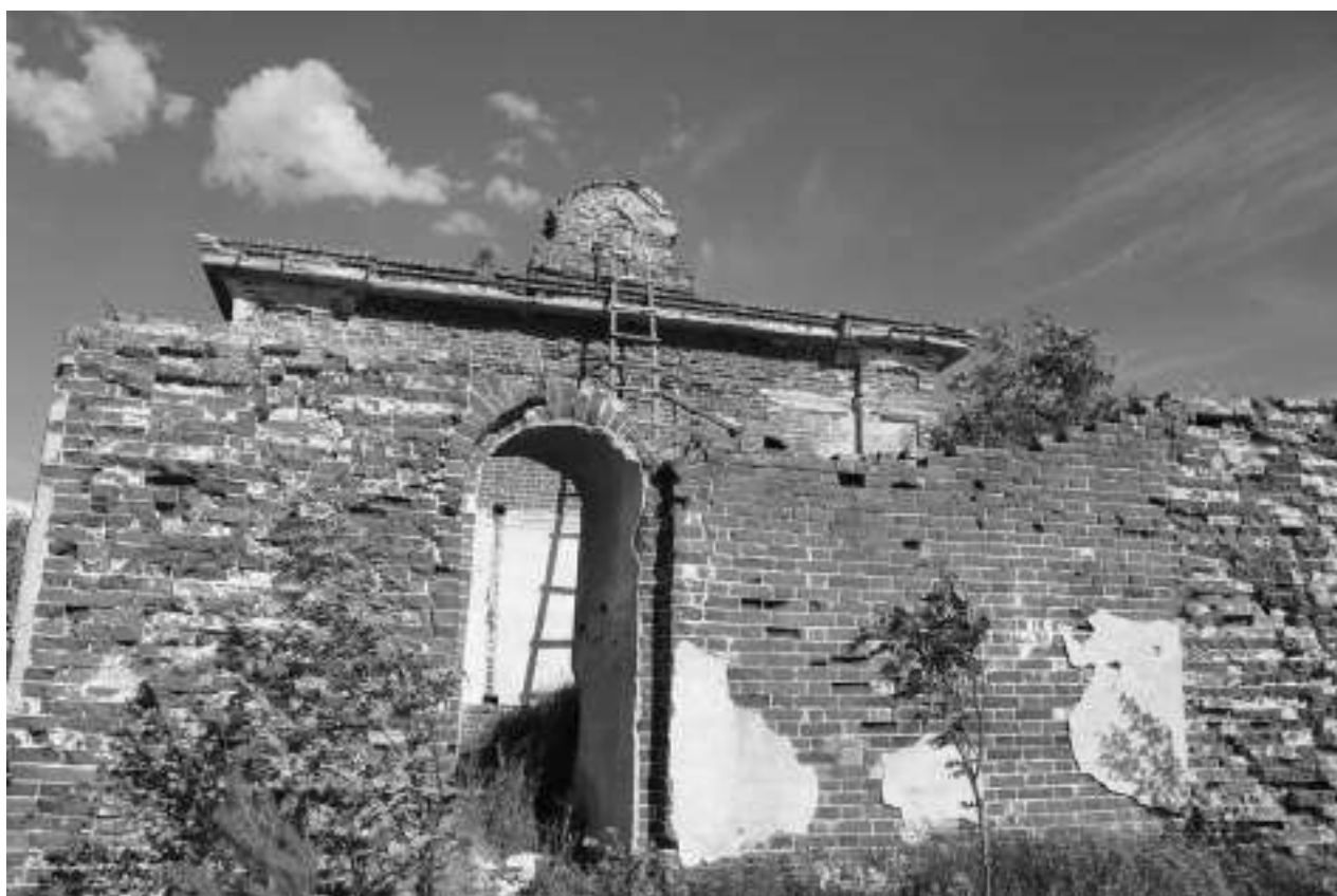
Фото 47. Отсутствие/разрушение штукатурного слоя, высолы раствора, локальное разрушение кирпичной кладки, выпадение отдельных кирпичей, поражение кирпичной кладки мхом, наличие растений на кровле, разрушение декора арочного проема, сколы карнизных плит, без изменения рабочего положения, отсутствие свода над трапезной, купола над храмом
