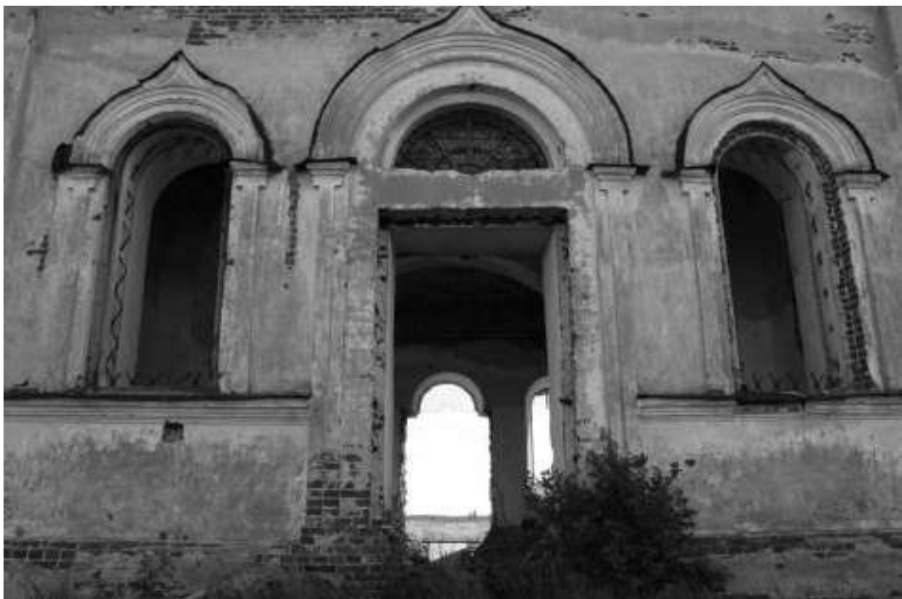
Фото 14. Отсутствие/разрушение штукатурного слоя, выщелачивание солей из раствора, повреждение оконной решетки, повреждение карниза, разрыхление подоконного пояса, выбоины в стенах, отсутствие оконного заполнения
