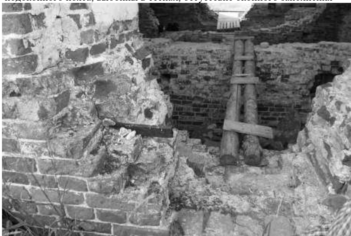
Фото 15. Разрушение кирпичной кладки, выщелачивание солей из раствора, разорванные связи северного входа в храм
