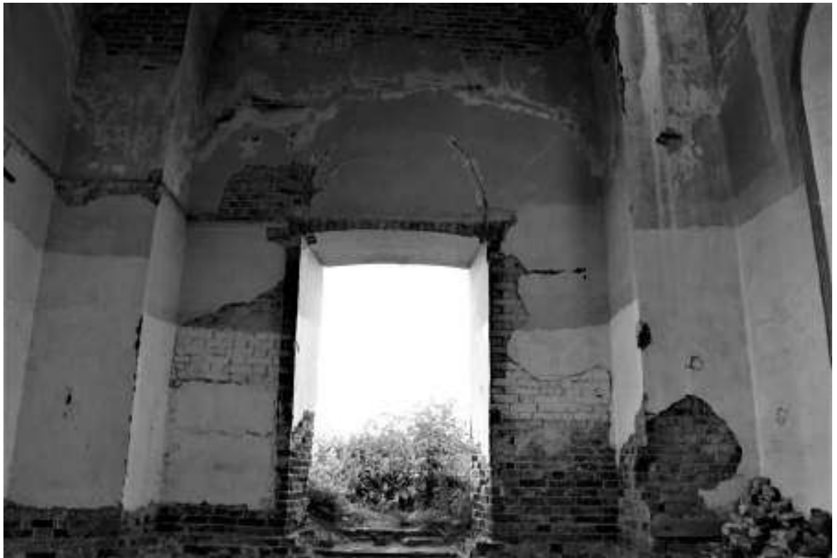
Фото 22. Разрушение штукатурного слоя, высолы раствора, выветривание, выпадение отдельных кирпичей несущей колонны притвора, волосяные трещины, выбоины, заложенная полуциркульная арка над входом
