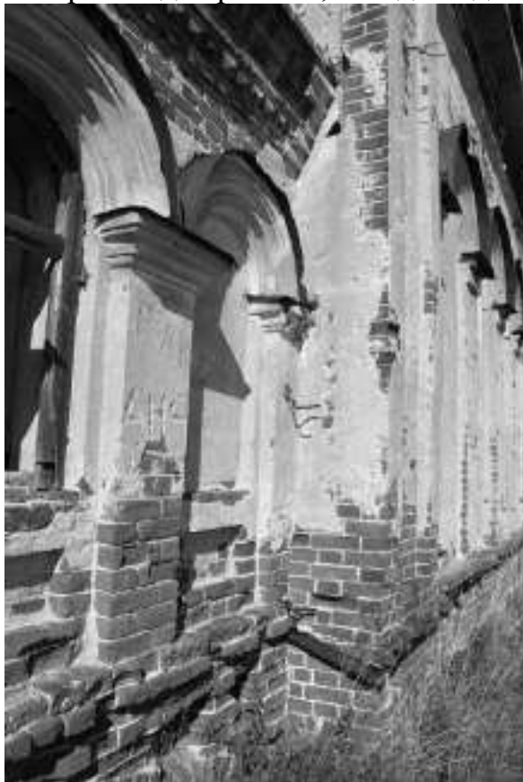
Фото 51. Отсутствие/разрушение штукатурного слоя, высолы раствора, выветривание кирпича, отсутствие водостока, повреждение подоконного карниза, деформация и локальное отсутствие металлического обрамления оконного проема
