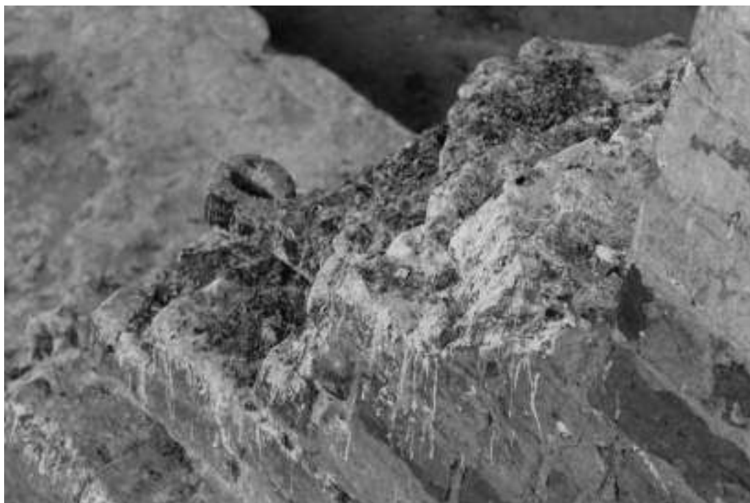
Фото 46. Оголенное порванное крепление стяжек по низу арочного прохода из храма в апсиду
