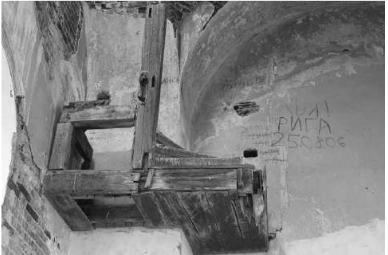
Фото 27. Остатки разрушенной деревянной лестницы притвора, сколы штукатурного слоя, гнездо в стене под перила лестницы, выцветание краски
