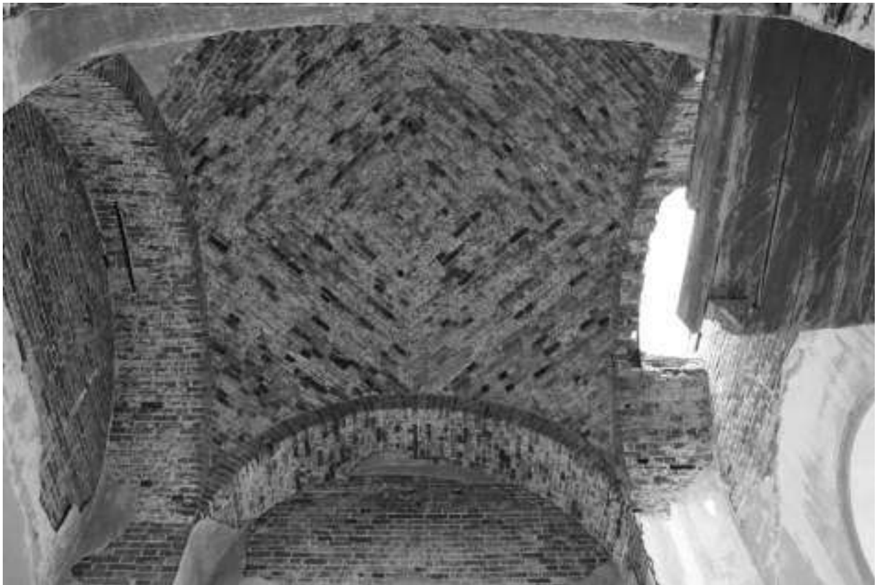
Фото 26. Отсутствие штукатурного слоя на своде, оголенная стяжка в арке, разрушение кладки проема выхода на колокольню в притворе
