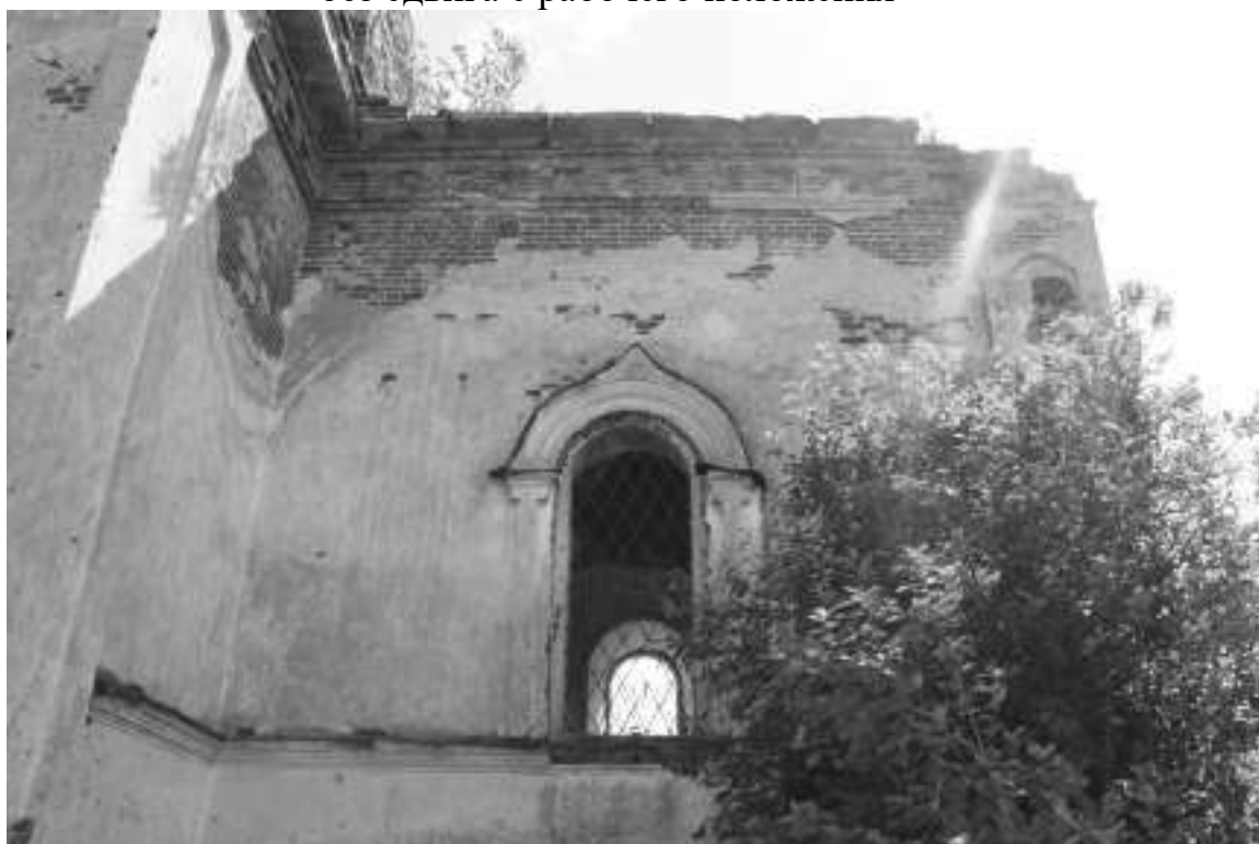
Фото 17. Отсутствие/разрушение штукатурного слоя, высолы раствора, выветривание кирпича, оголение внутренних стяжек несущей колонны притвора, повреждение оконного карниза, сколы подоконного пояса, карнизных плит
