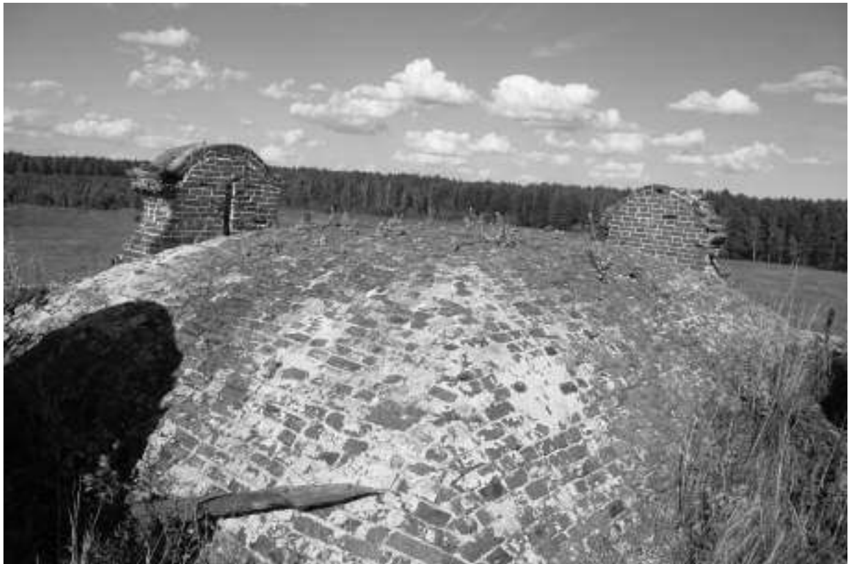
Фото 54. Высолы раствора, аттики подвержены выветриванию кирпича, поражение кирпича мхом, отсутствие купола над храмом
