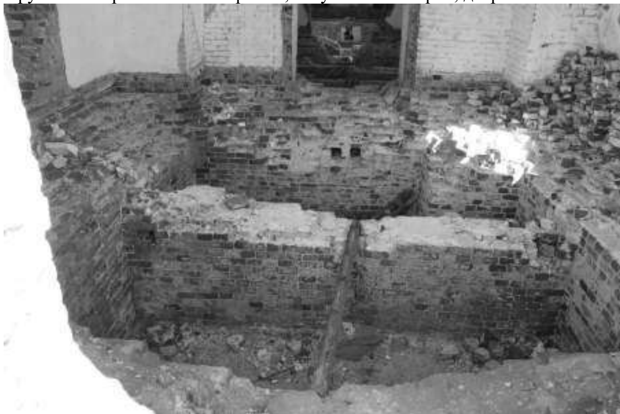
Фото 19. Разрушение штукатурного слоя, высолы раствора, выветривание и выпадение отдельных кирпичей фундамента и стен, отсутствие полов во всех частях здания, разрушенные места продухов в фундаменте
