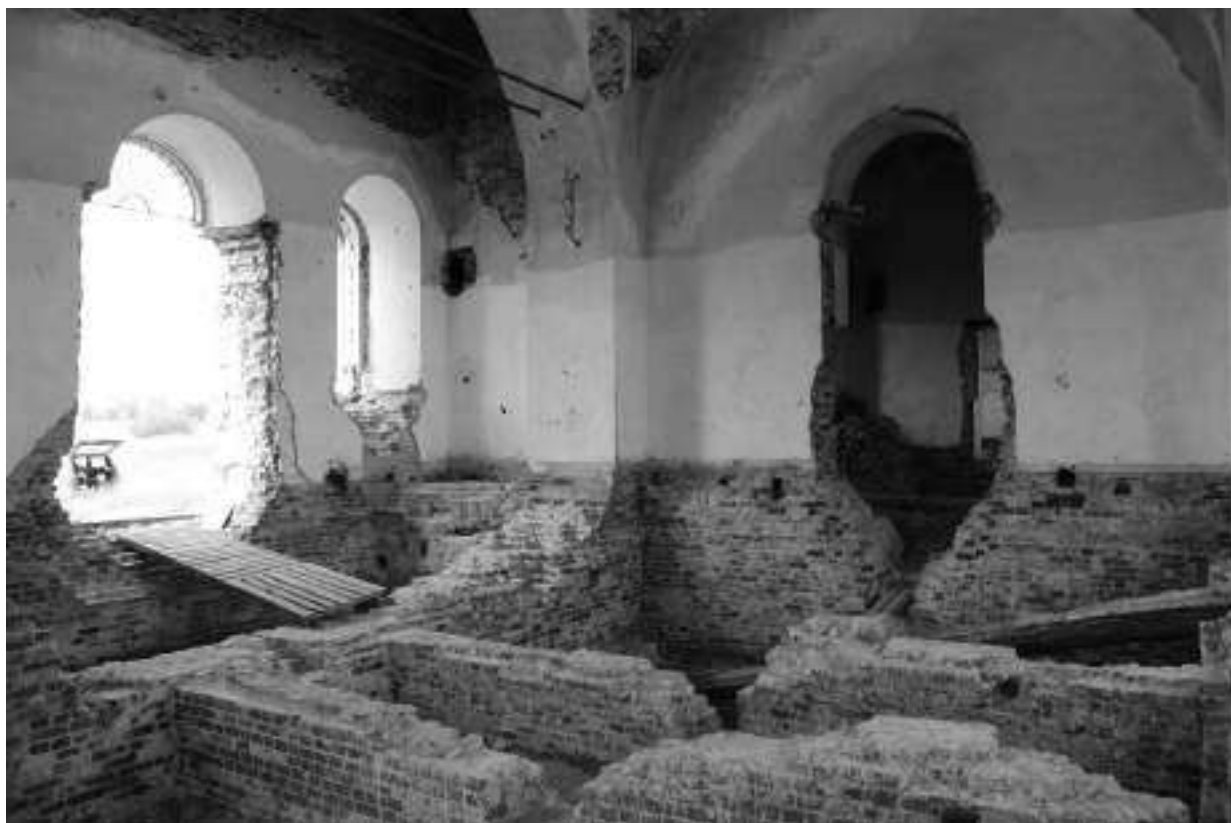
Фото 42. Отсутствие/разрушение штукатурного слоя, высолы раствора, выпадение отдельных кирпичей, разрушение кладки дверных проемов, фундамента, отсутствие пола, гнезда в стенах под лаги, разрушение декора арки дверных проемов, сохранившиеся выход печного дымохода и фундамент под печь
