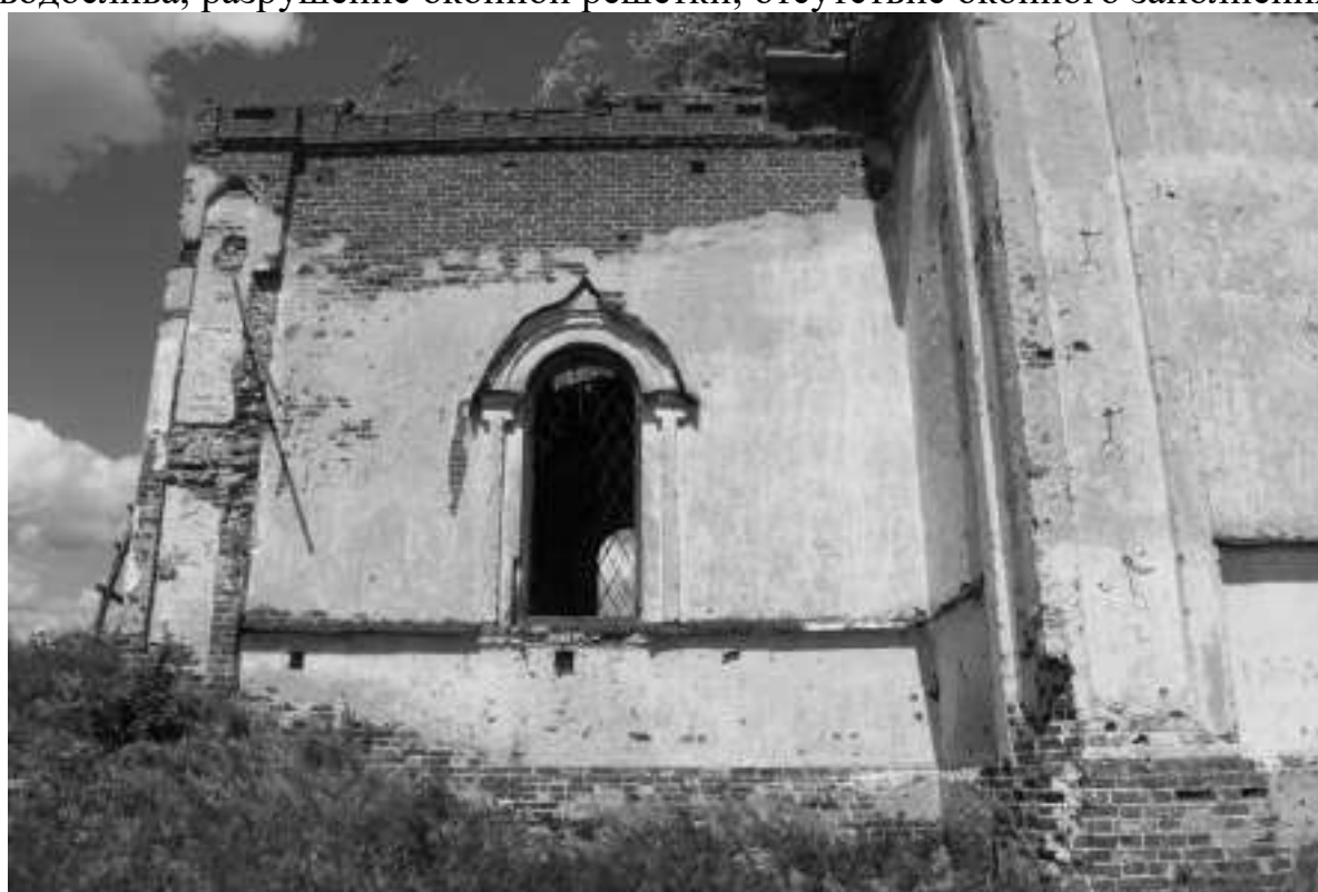
Фото 13. Отсутствие/разрушение штукатурного слоя, высолы раствора, выветривание кирпича, выпадение отдельных кирпичей, отсутствие водослива, оголение внутренних стяжек несущей колонны притвора, разрушение верхних слоев кирпича, отсутствие оконного заполнения
