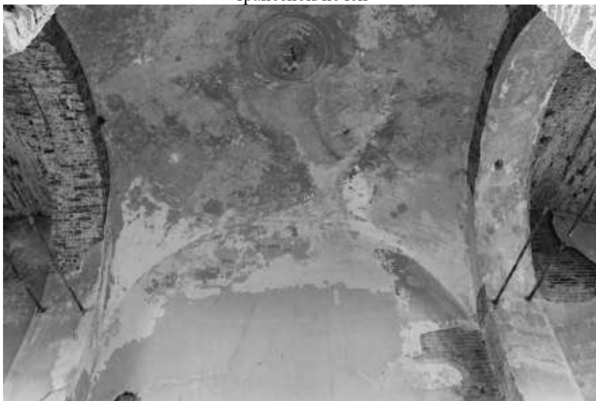
Фото 31. Поражение штукатурного слоя на своде, выцветание краски, оголенные стяжки в арочных проходах
