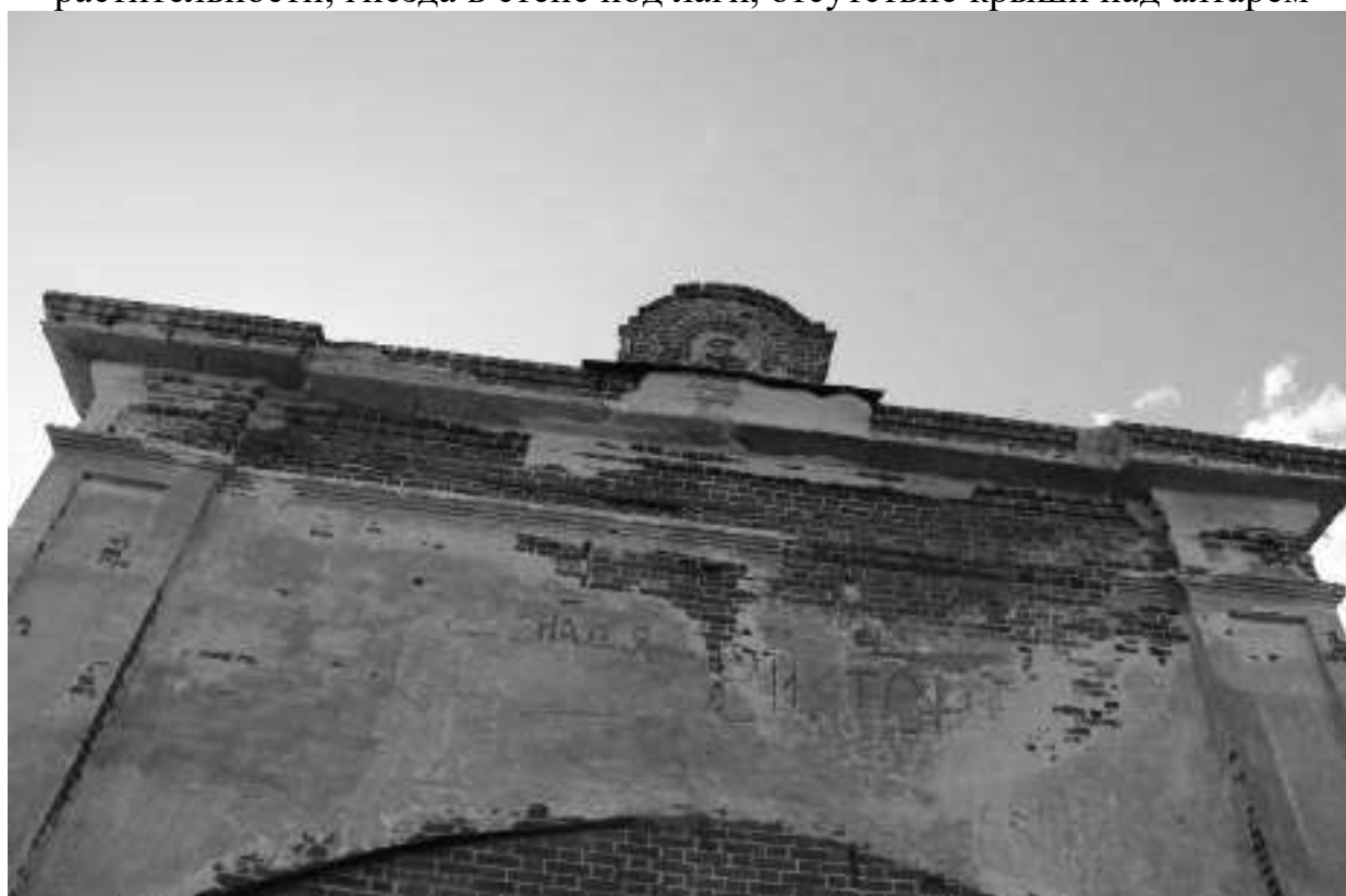
Фото 57. Отсутствие/разрушение штукатурного слоя, высолы раствора, сколы карнизных плит, рабочее положение без изменения, выветривание кирпича, выпадение отдельных кирпичей из аттика, разрушение пилястров под карнизом
