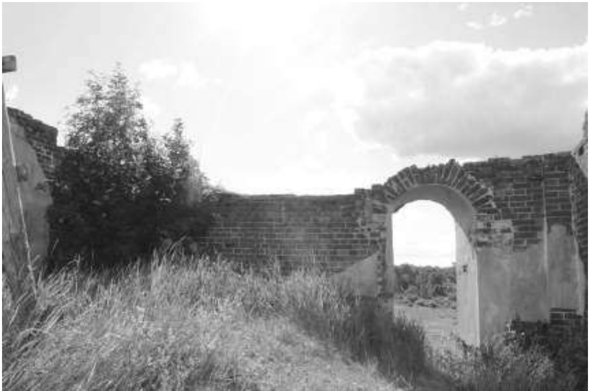
Фото 48. Отсутствие/разрушение штукатурного слоя, высолы раствора, отсутствие, выветривание кирпича в стенах на крыше второго этажа, разрушение декора арочного проема, наличие растений на втором этаже, отсутствие свода над трепезной
