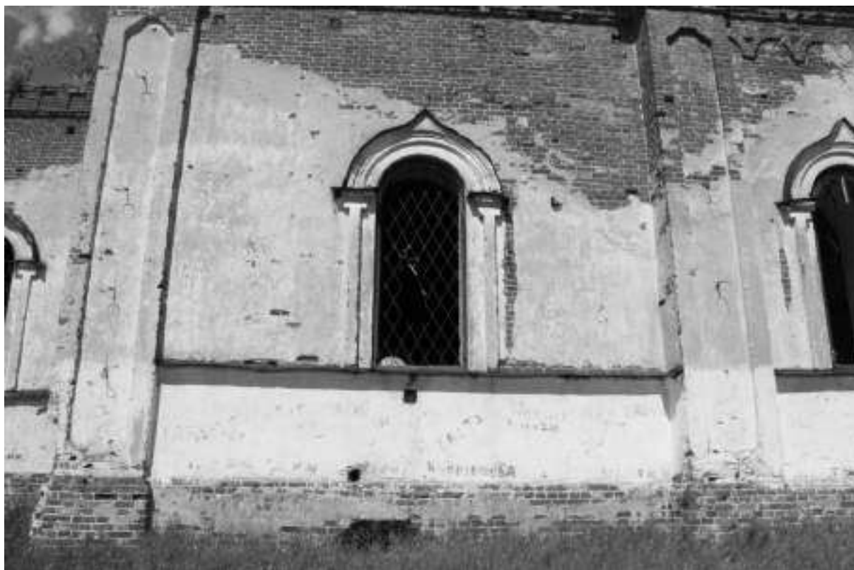
Фото 12. Отсутствие/разрушение штукатурного слоя, высолы раствора, выветривание кирпича, выпадение и выветривание кирпича, отсутствие водослива, разрушение оконной решетки, отсутствие оконного заполнения
