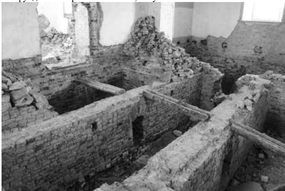
Фото 33. Отсутствие/разрушение/сколы штукатурного слоя, высолы раствора, отсутствие пола, гнезда в стенах под лаги, частичное разрушение кирпичной кладки фундамента, груда кирпича от разобранного фундамента трапезной/печей
