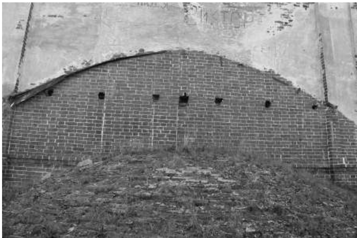
Фото 56. Выветривание штукатурного слоя, высолы раствора, наличие растительности, гнезда в стене под лаги, отсутствие крыши над алтарем
