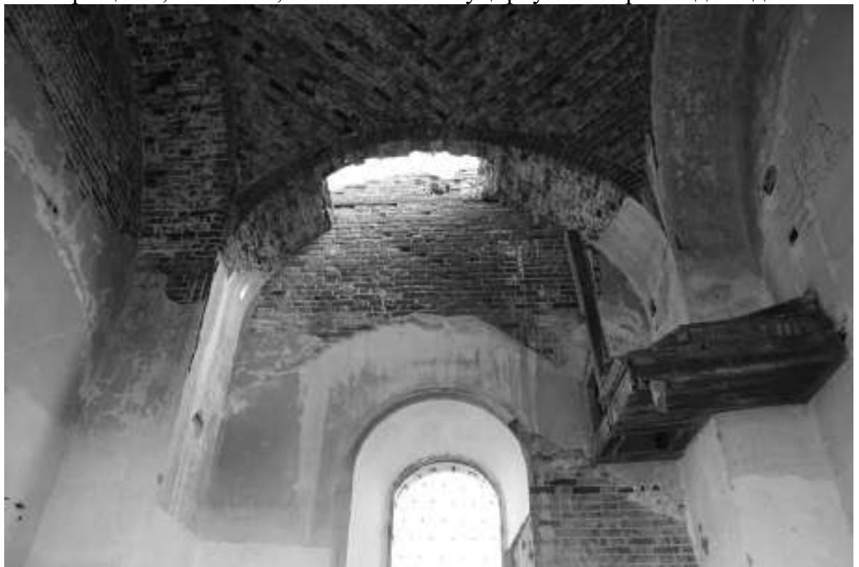
Фото 23. Отсутствие/разрушение штукатурного слоя со стен и свода, высолы раствора, остатки разобранной деревянной лестницы у северной стены притвора, разрушение кладки проема выхода на колокольню, гнезда в стене, в несущей колонне под перила деревянной лестницы
