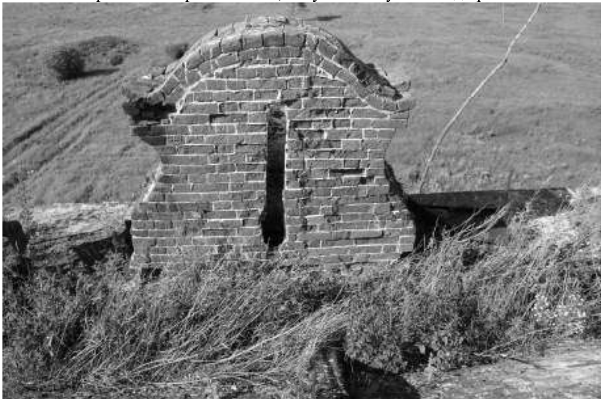
Фото 55. Отсутствие/разрушение штукатурного слоя, высолы раствора, выветривание кирпича, выпадение отдельных кирпичей из аттика, наличие растительности на втором этаже
