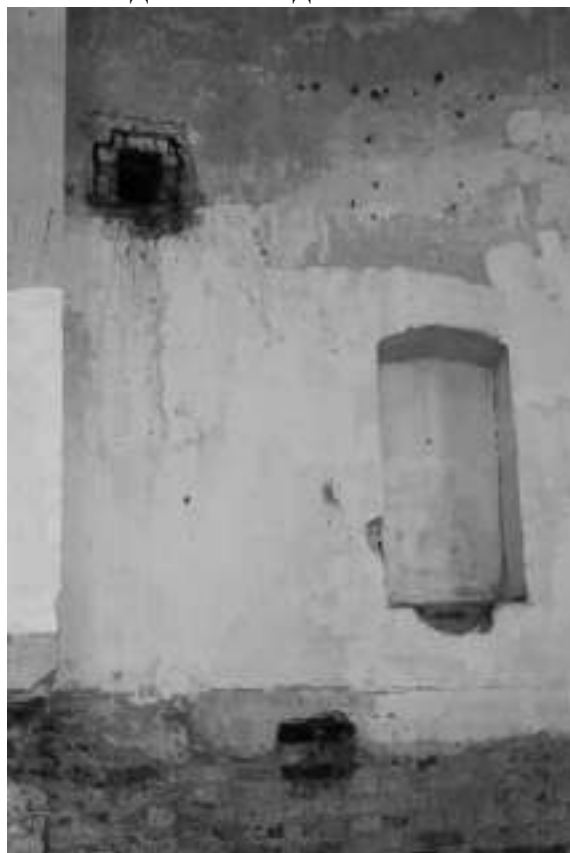
Фото 45. Отсутствие/разрушение штукатурного слоя, отверстия в стенах под лаги, сохранившийся выход печного дымохода, скол на кафельной нише
