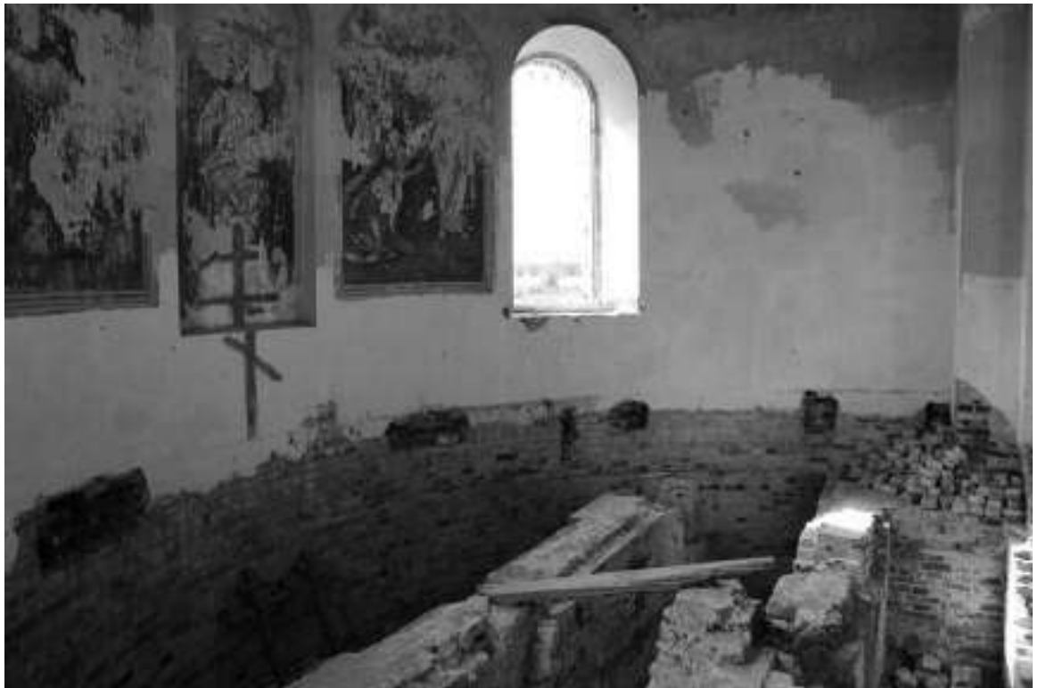
Фото 44. Отсутствие/разрушение штукатурного слоя, высолы раствора, локальное разрушение кирпичной кладки фундамента, выбоины и гнезда в стенах под лаги, отсутствие пола, оконного заполнения, трещины под окнами апсиды, отсутствие подоконной доски в оконном проеме апсиды
