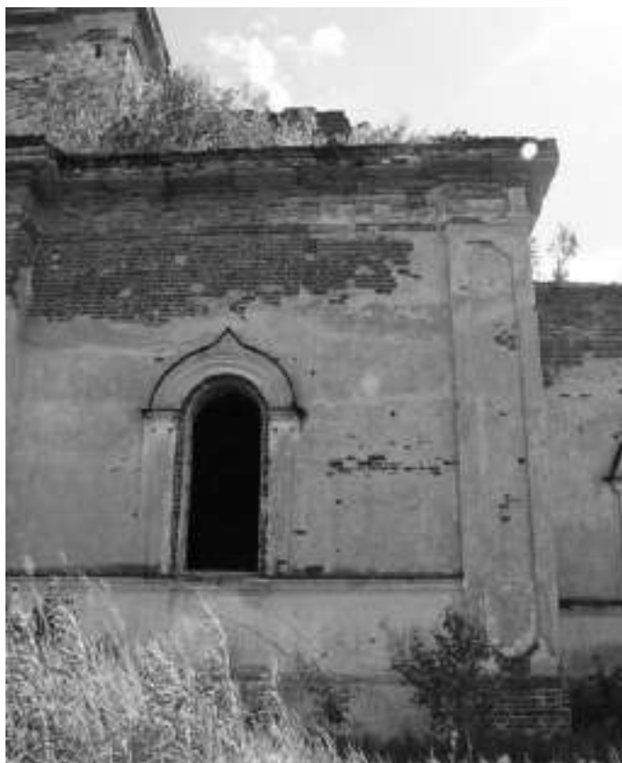
Фото 16. Отсутствие/разрушение штукатурного слоя, выщелачивание солей из раствора, отсутствие оконной решетки, карниза, разрыхление подоконного пояса, отсутствие водослива, отсутствие оконного заполнения, сколы карнизных плит, без сдвига с рабочего положения
