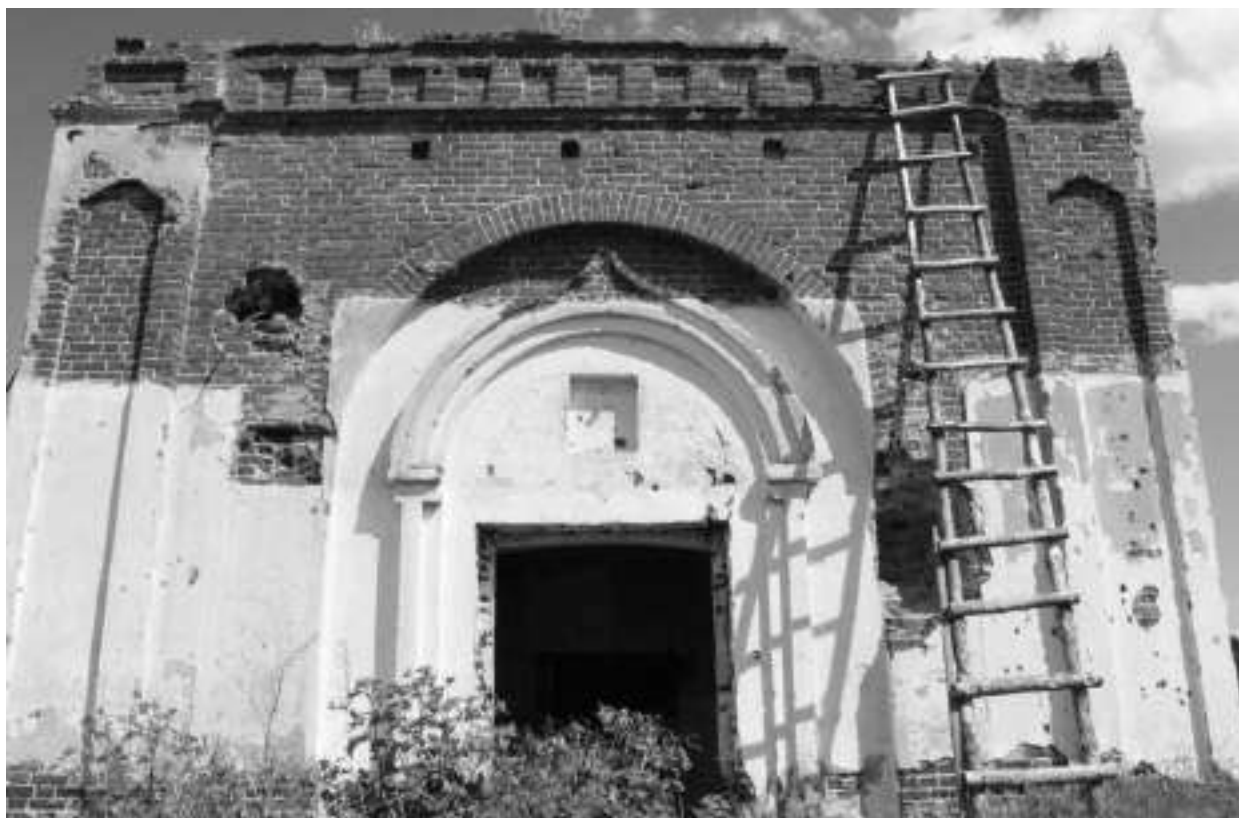
Фото 18. Отсутствие/разрушение штукатурного слоя, высолы раствора, выветривание кирпича, оголение внутренних стяжек, сколы от выстрелов, разрушение кладки дверного проема, дыра в стене, отсутствие водослива, разрушение верхних слоев кирпича, отсутствие паперти, дверного заполнения
