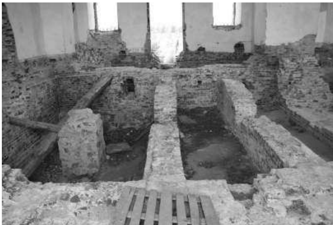
Фото 40. Отсутствие/разрушение штукатурного слоя, высолы раствора, локальное разрушение кирпичной и бутовой части фундамента, гнезда в стенах под лаги, отсутствие пола, деревянные лаги не на своих местах
