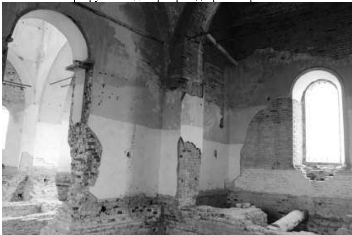
Фото 29. Отсутствие/разрушение штукатурного слоя, высолы раствора, выпадение отдельных кирпичей, разрушение кладки подоконной части и дверного проема, отсутствие пола, гнезда в стенах под лаги, деревянная доска на стяжках, разрушение декора арки дверного проема
