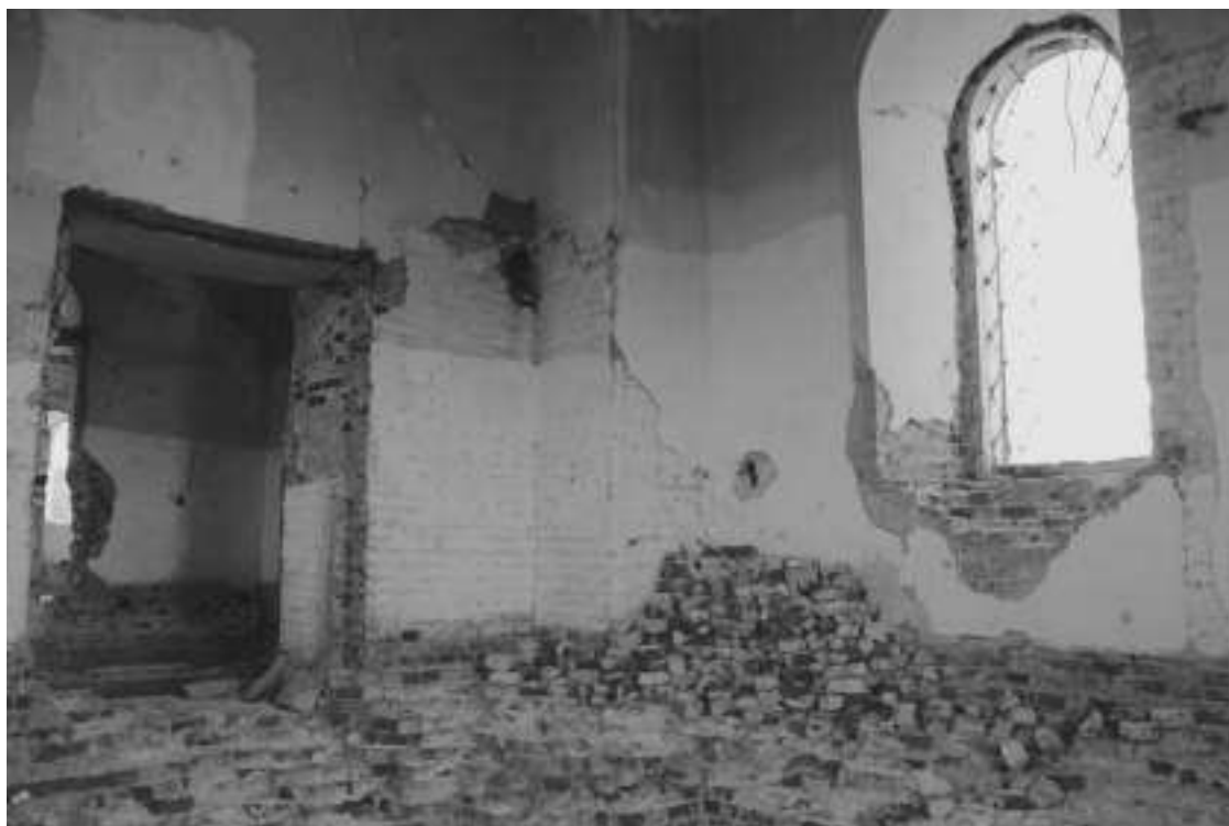
Фото 20. Разрушение/сколы штукатурного слоя, высолы раствора, выветривание и выпадение отдельных кирпичей, разрушение кладки подоконной части, дверного проема в трапезную, сохранившиеся выходы печного дымохода, отсутствие печи
