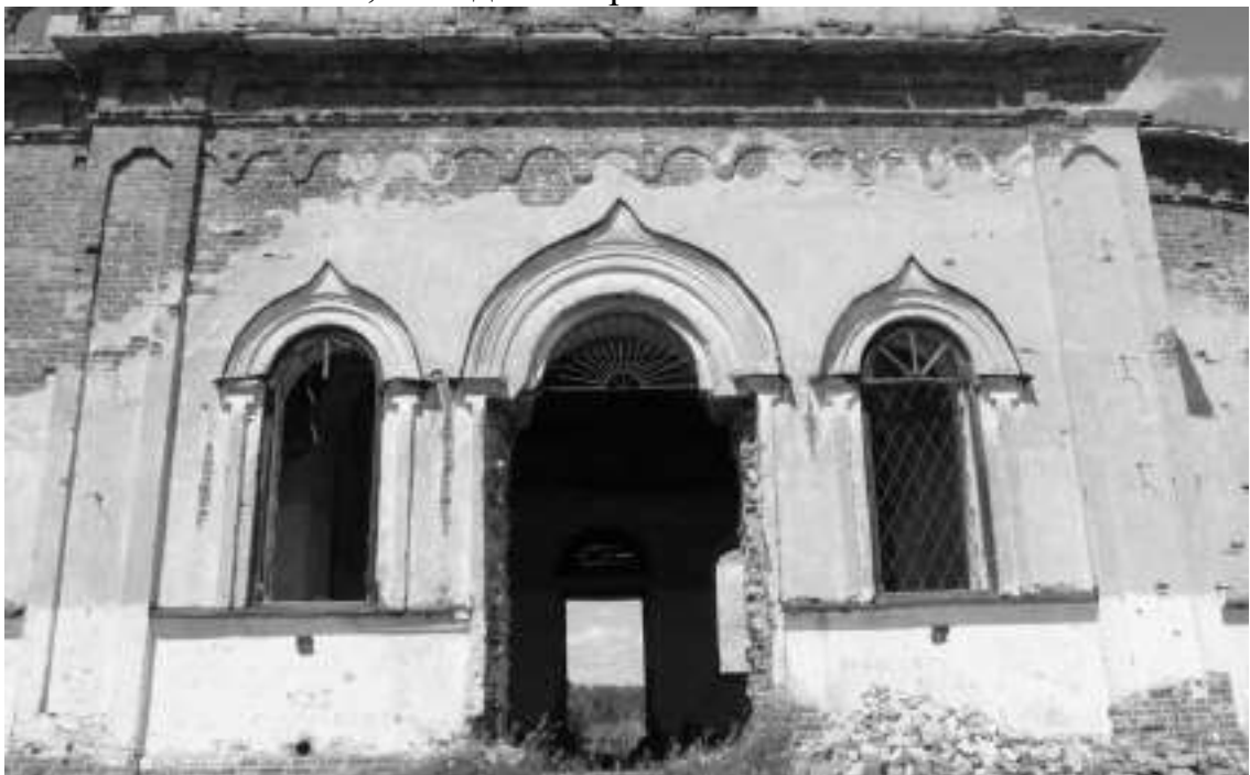
Фото 7. Отсутствие/разрушение штукатурного слоя, разрушение кирпичной кладки входа в храм с южной стороны, отсутствие дверной перемычки, выщелачивание солей из раствора, повреждение оконной решетки, разрушение декора, повреждение карниза, отсутствие водослива, отсутствие оконного заполнения
