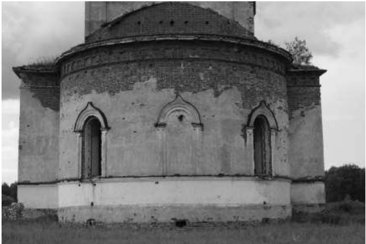
Фото 6. Отсутствие/разрушение штукатурного слоя, выветривание кирпича, выщелачивание солей из раствора, трещины под оконными проемами окон апсиды, отсутствие оконных решеток, отсутствие/разрушение карниза, выбоины в стене, отсутствие оконного заполнения, свода над апсидой, сколы карнизных плит, без сдвига с рабочего положения
