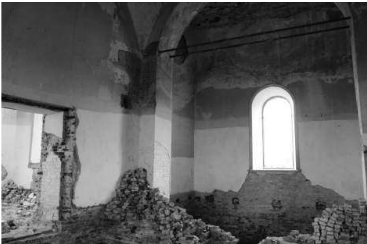
Фото 32. Отсутствие/разрушение/сколы штукатурного слоя, высолы раствора, разрушение кладки дверного проема, отсутствие пола, гнезда в стенах под лаги, сохранившейся выходы печного дымохода, груда кирпича от разобранного фундамента трапезной/печей, отсутствие оконного заполнения
