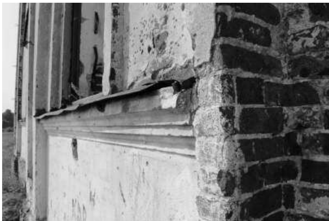
Фото 11. Отсутствие/разрушение штукатурного слоя, повреждение карниза, выветривание кирпича
