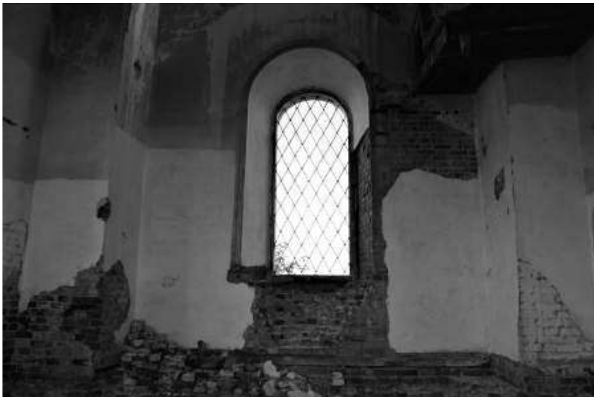
Фото 24. Разрушение/сколы штукатурного слоя, разрушение кладки подоконной части, сохранившаяся оконная решетка, остатки деревянного плинтуса, отсутствие оконного заполнения, выбоины в несущей колонне
