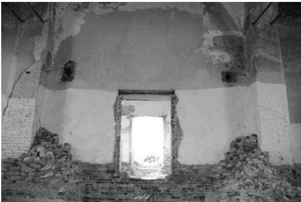
Фото 30. Сколы штукатурного слоя, высолы раствора, разрушение кладки дверного проема из трапезной в притвор, отсутствие пола, сохранившейся выходы печного дымохода, гряда кирпича от разобранныго фундамента трапезной/печей
