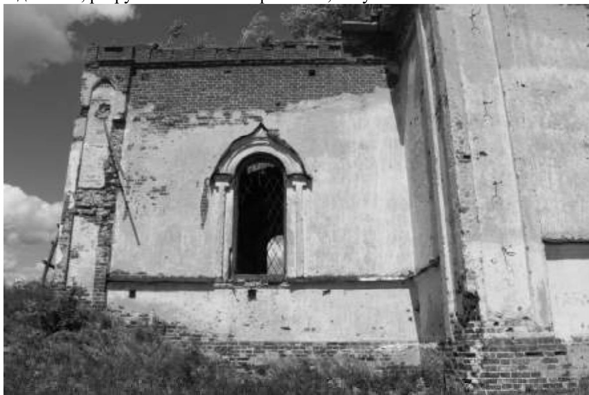
Фото 13. Отсутствие/разрушение штукатурного слоя, высолы раствора, выветривание кирпича, выпадение отдельных кирпичей, отсутствие водослива, оголение внутренних стяжек несущей колонны притвора, разрушение верхних слоев кирпича, отсутствие оконного заполнения
