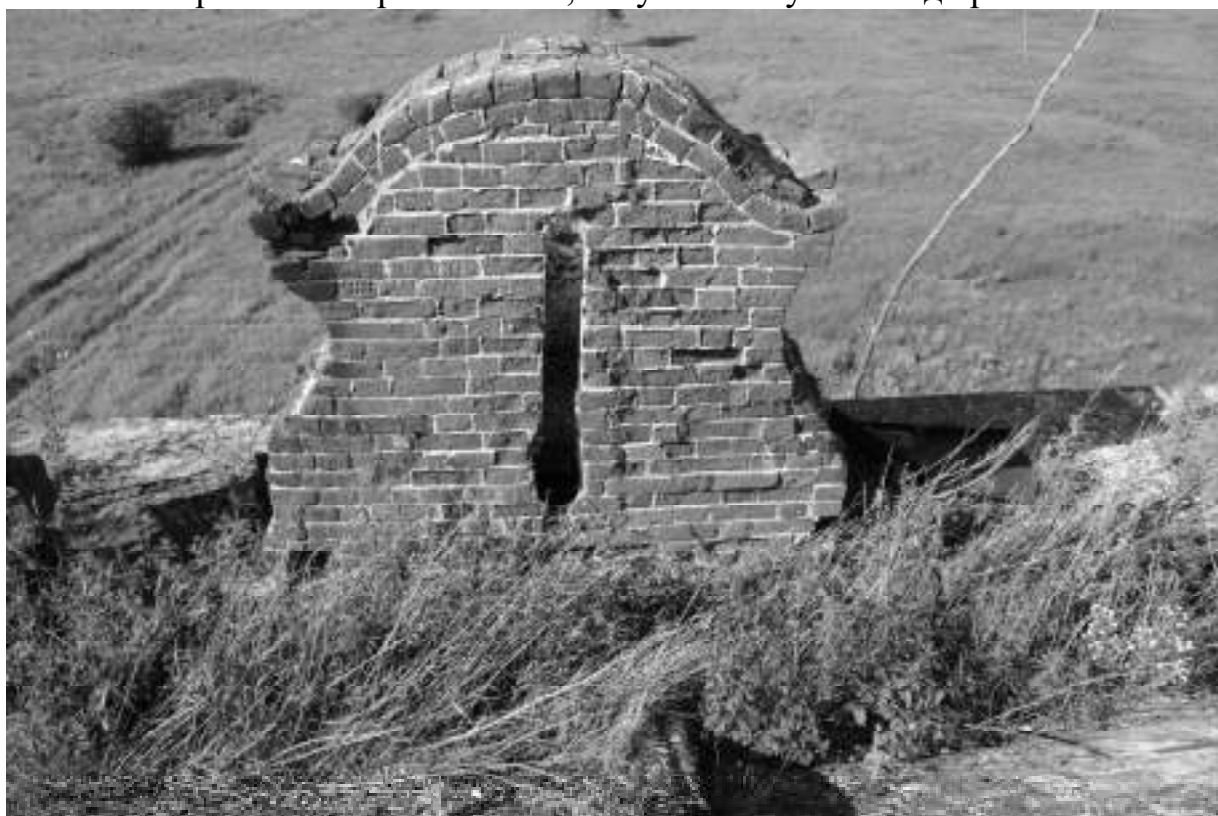
Фото 55. Отсутствие/разрушение штукатурного слоя, высолы раствора, выветривание кирпича, выпадение отдельных кирпичей из аттика, наличие растительности на втором этаже
