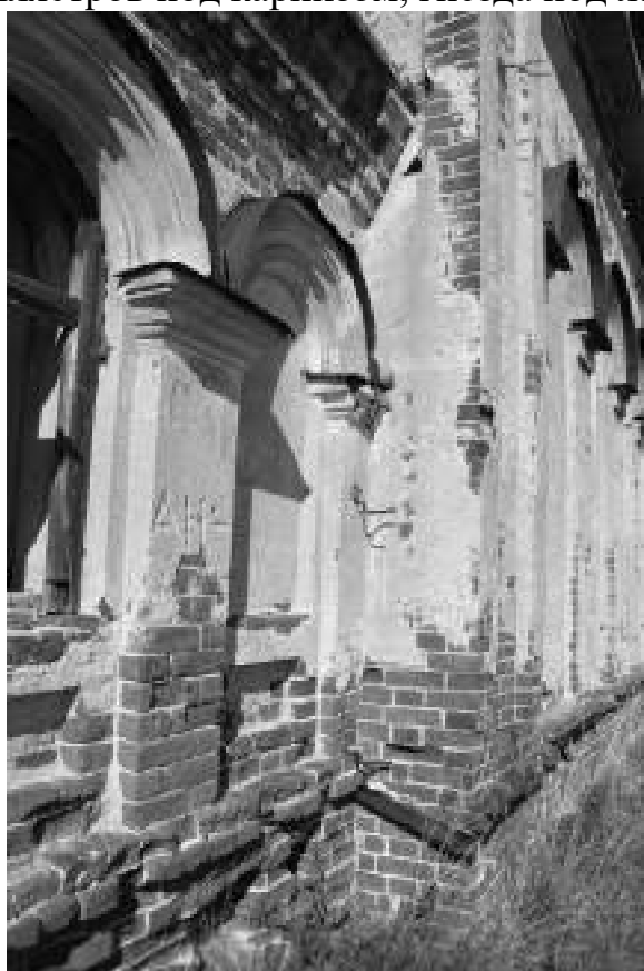
Фото 51. Отсутствие/разрушение штукатурного слоя, высолы раствора, выветривание кирпича, отсутствие водостока, повреждение подоконного карниза, деформация и локальное отсутствие металлического обрамления оконного проема
