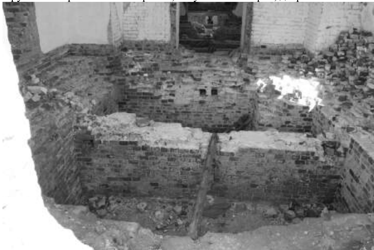
Фото 19. Разрушение штукатурного слоя, высолы раствора, выветривание и выпадение отдельных кирпичей фундамента и стен, отсутствие полов во всех частях здания, разрушенные места продухов в фундаменте
