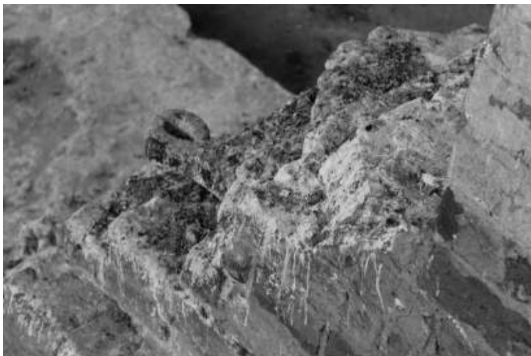
Фото 46. Оголенное порванное крепление стяжек по низу арочного прохода из храма в апсиду
