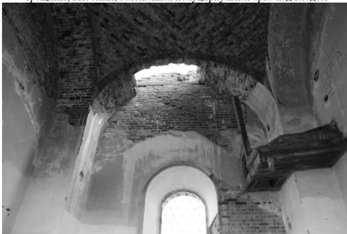
Фото 23. Отсутствие/разрушение штукатурного слоя со стен и свода, высолы раствора, остатки разобранной деревянной лестницы у северной стены притвора, разрушение кладки проема выхода на колокольню, гнезда в стене, в несущей колонне под перила деревянной лестницы
