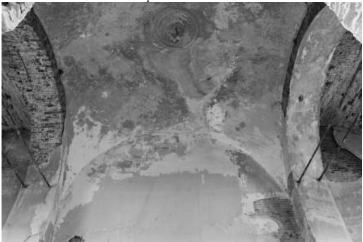
Фото 31. Поражение штукатурного слоя на своде, выцветание краски, оголенные стяжки в арочных проходах
