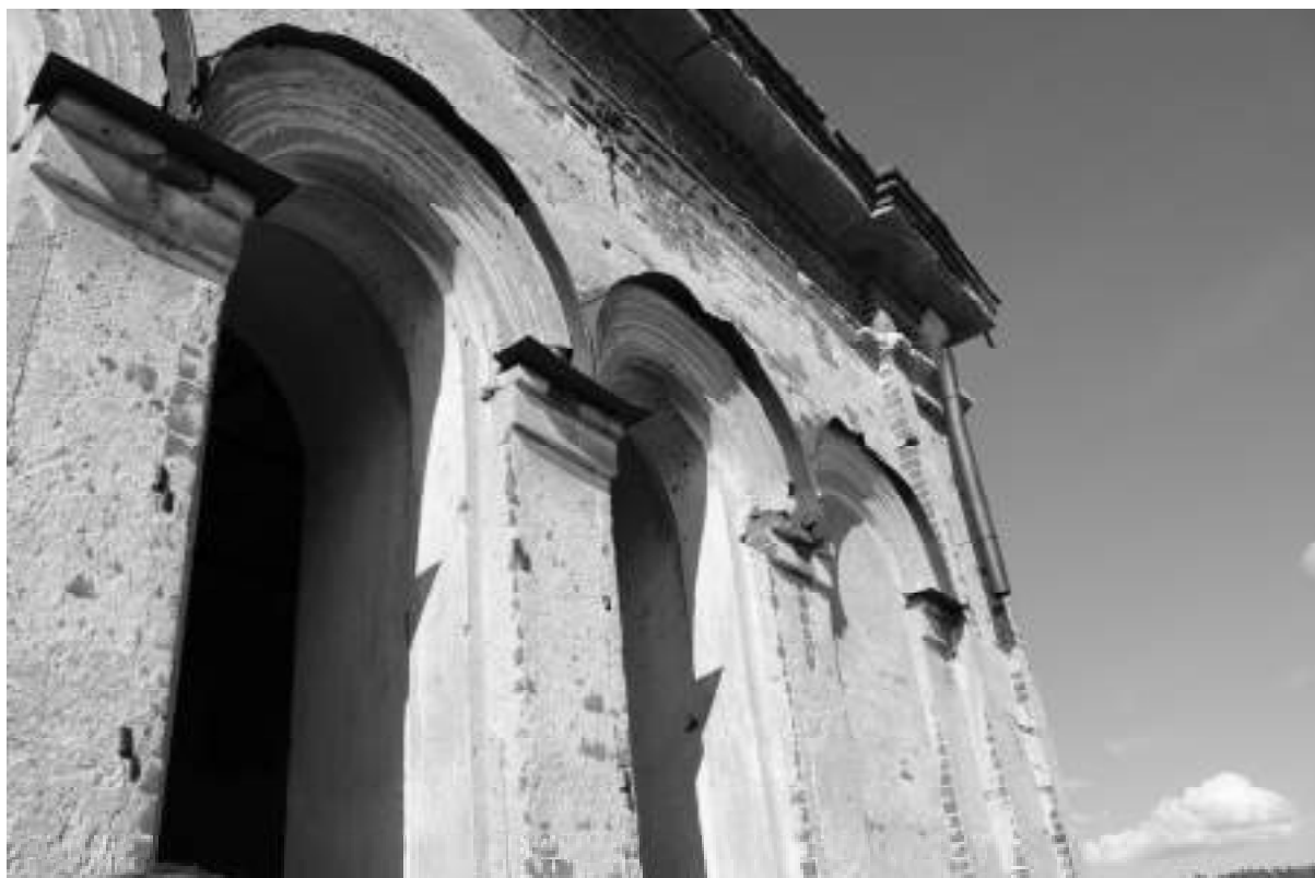
Фото 52. Отсутствие/разрушение штукатурного слоя, высолы раствора, остатки водостлива, деформация металлического обрамления оконного проема, сколы карнизных плит, повреждение пилястров под карнизом, отсутствие оконного заполнения
