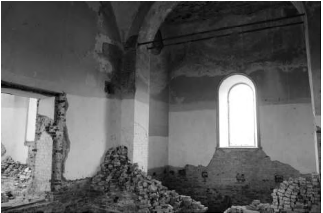
Фото 32. Отсутствие/разрушение/сколы штукатурного слоя, высолы раствора, разрушение кладки дверного проема, отсутствие пола, гнезда в стенах под лаги, сохранившийся выходы печного дымохода, груда кирпича от разобранного фундамента трапезной/печей, отсутствие оконного заполнения
