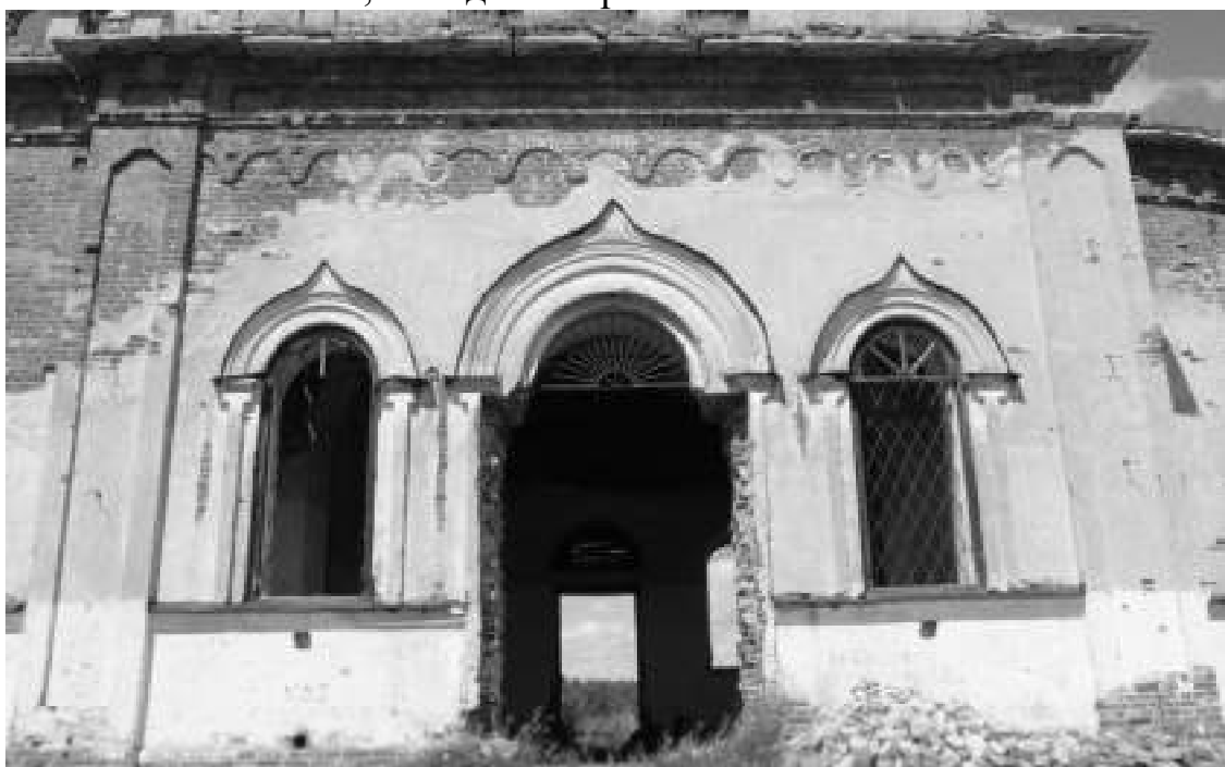
Фото 7. Отсутствие/разрушение штукатурного слоя, разрушение кирпичной кладки входа в храм с южной стороны, отсутствие дверной перемычки, выщелачивание солей из раствора, повреждение оконной решетки, разрушение декора, повреждение карниза, отсутствие водослива, отсутствие оконного заполнения
