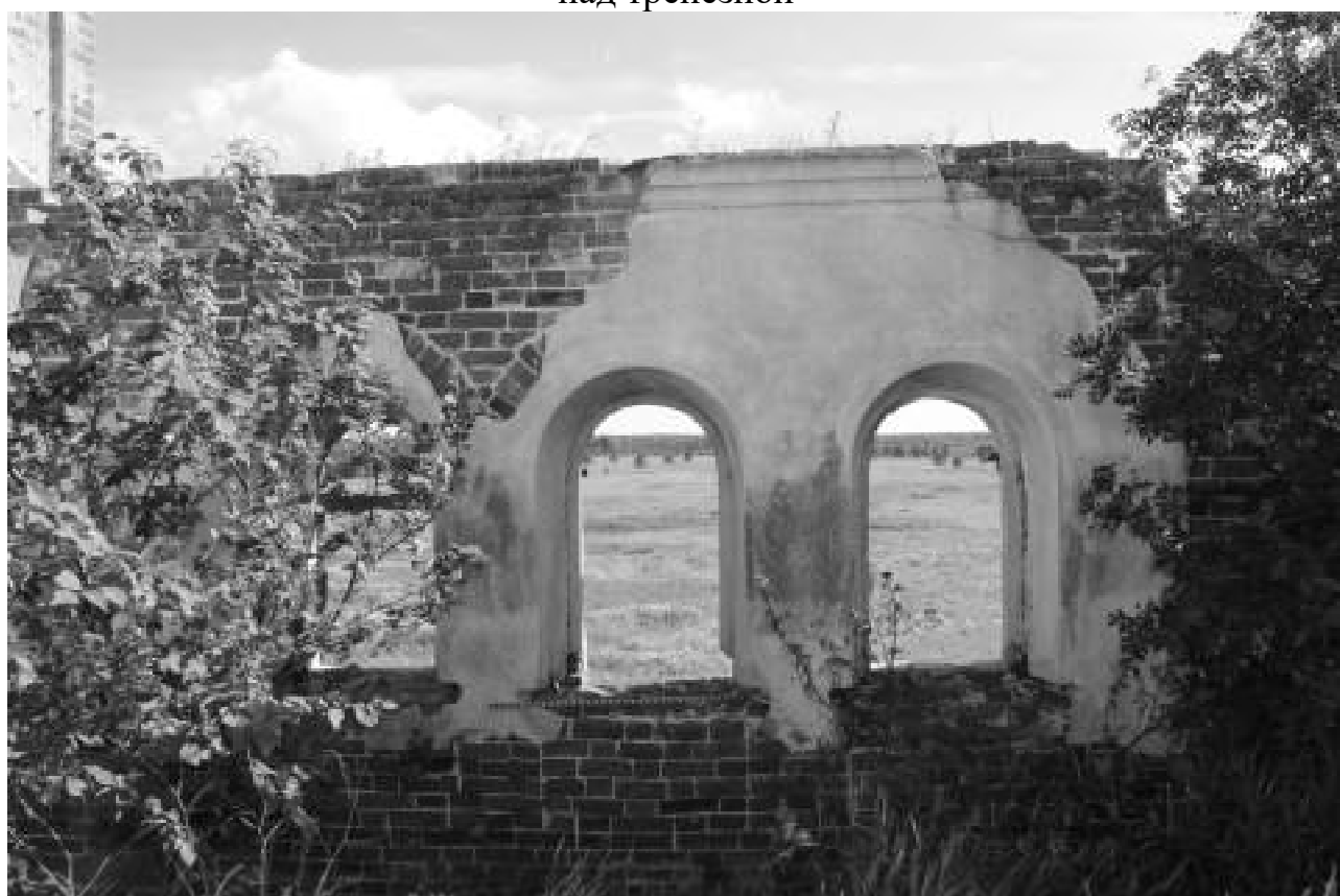
Фото 49. Отсутствие/разрушение штукатурного слоя, высолы раствора, разрушение подоконной части, наличие растений на втором этаже, разрушение верхних слоев кирпича, отсутствие оконного заполнения
