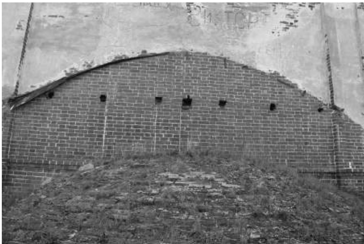
Фото 56. Выветривание штукатурного слоя, высолы раствора, наличие растительности, гнезда в стене под лаги, отсутствие крыши над алтарем
