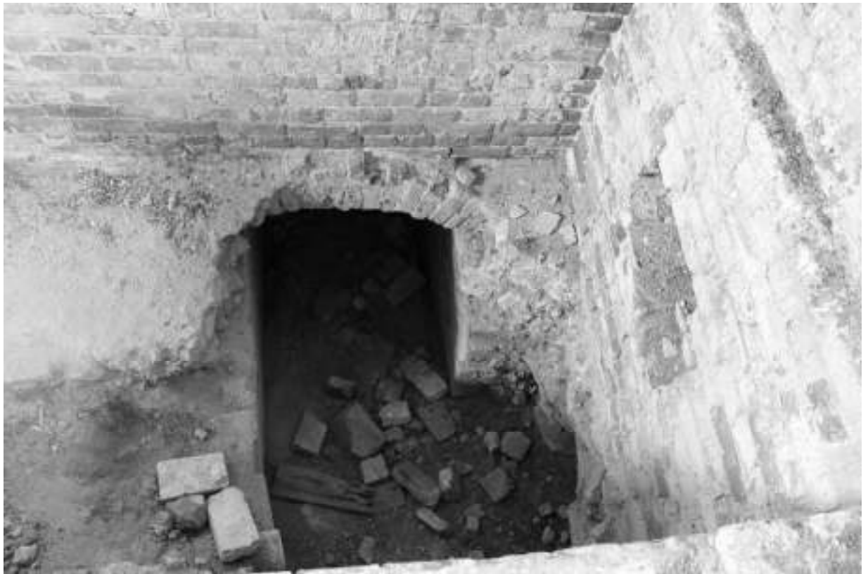
Фото 34. Разрушенный арочный проход в фундаменте трапезной, выпадение кирпича
