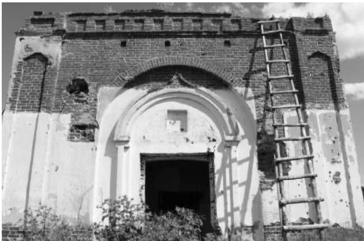
Фото 18. Отсутствие/разрушение штукатурного слоя, высолы раствора, выветривание кирпича, оголение внутренних стяжек, сколы от выстрелов, разрушение кладки дверного проема, дыра в стене, отсутствие водослива, разрушение верхних слоев кирпича, отсутствие паперти, дверного заполнения
