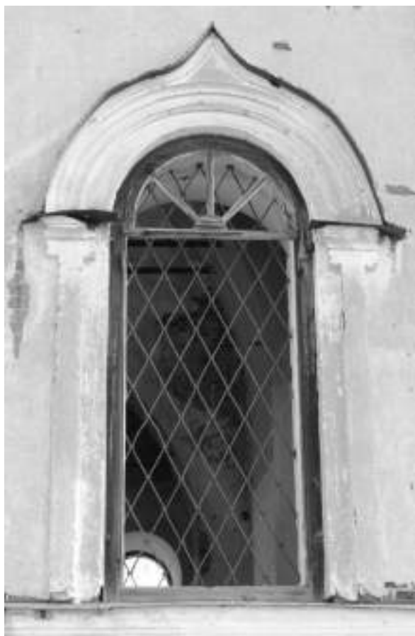
Фото 10. Сохранившаяся оконная решетка оконной рамы южного фасада, отсутствие/разрушение штукатурного слоя, отсутствие карниза, повреждение железного обрамления окна, небольшие сколы на наличниках, отсутствие оконного заполнения
