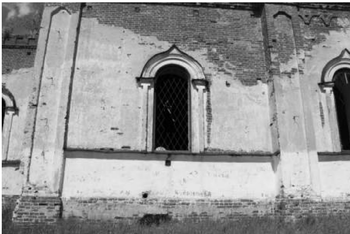
Фото 12. Отсутствие/разрушение штукатурного слоя, высолы раствора, выветривание кирпича, выпадение и выветривание кирпича, отсутствие водослива, разрушение оконной решетки, отсутствие оконного заполнения
