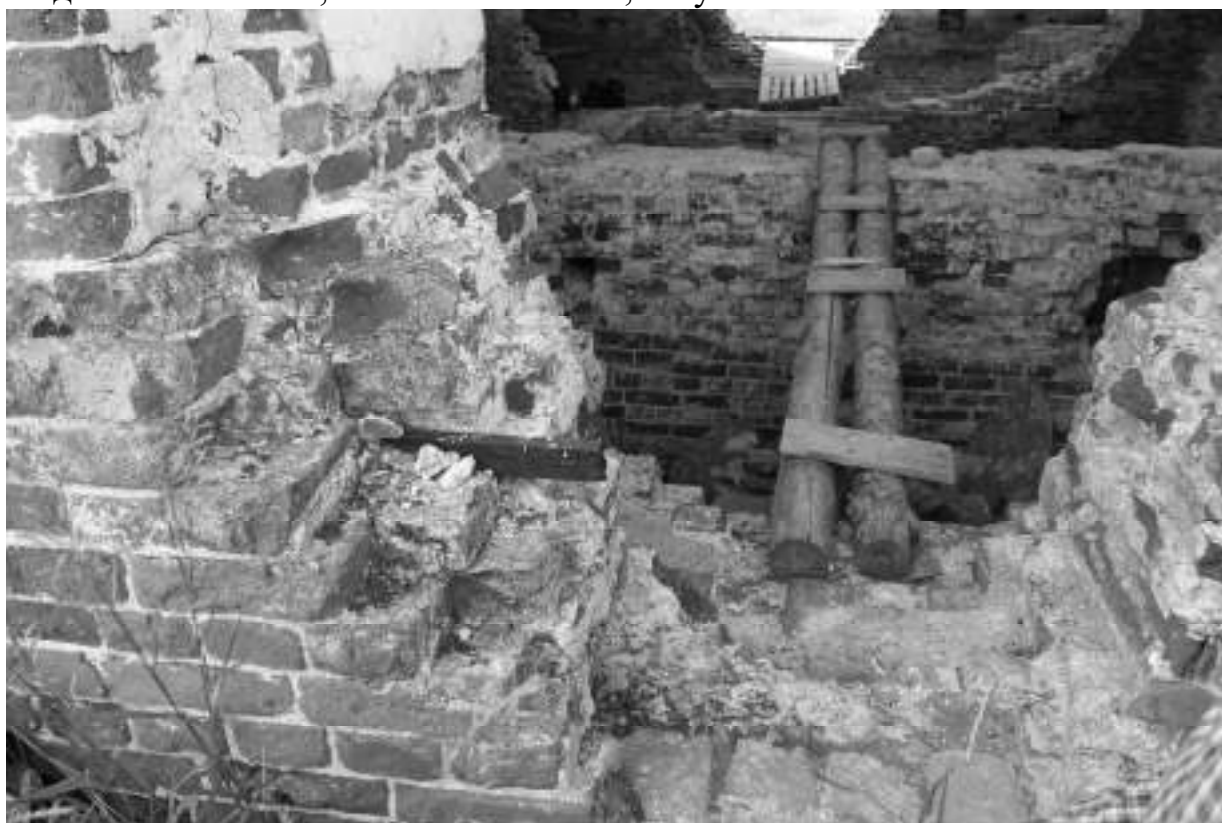
Фото 15. Разрушение кирпичной кладки, выщелачивание солей из раствора, разорванные связи северного входа в храм
