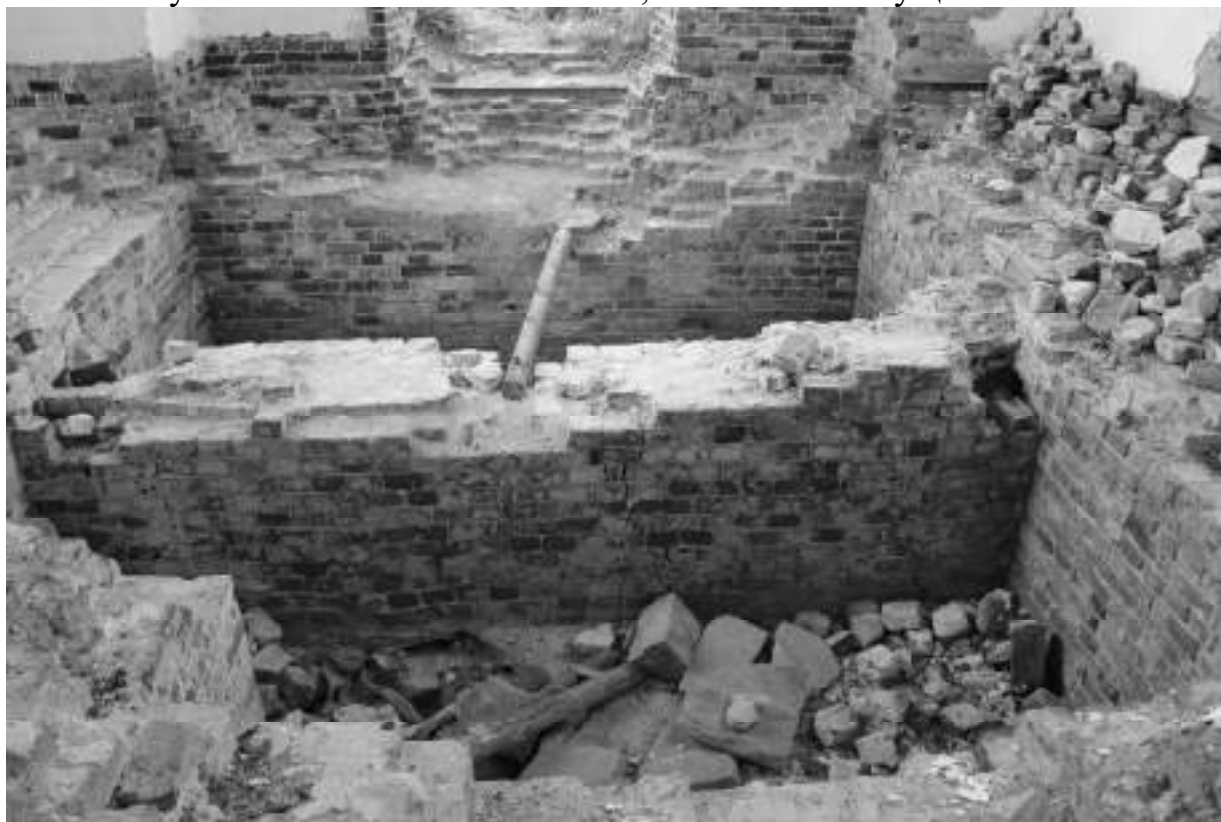
Фото 25. Отсутствие/разрушение штукатурного слоя, высолы раствора, выветривание и выпадение отдельных кирпичей фундамента и стен притвора, отсутствие полов во всех частях здания, остатки деревянного плинтуса, оголенные связи входа в притвор
