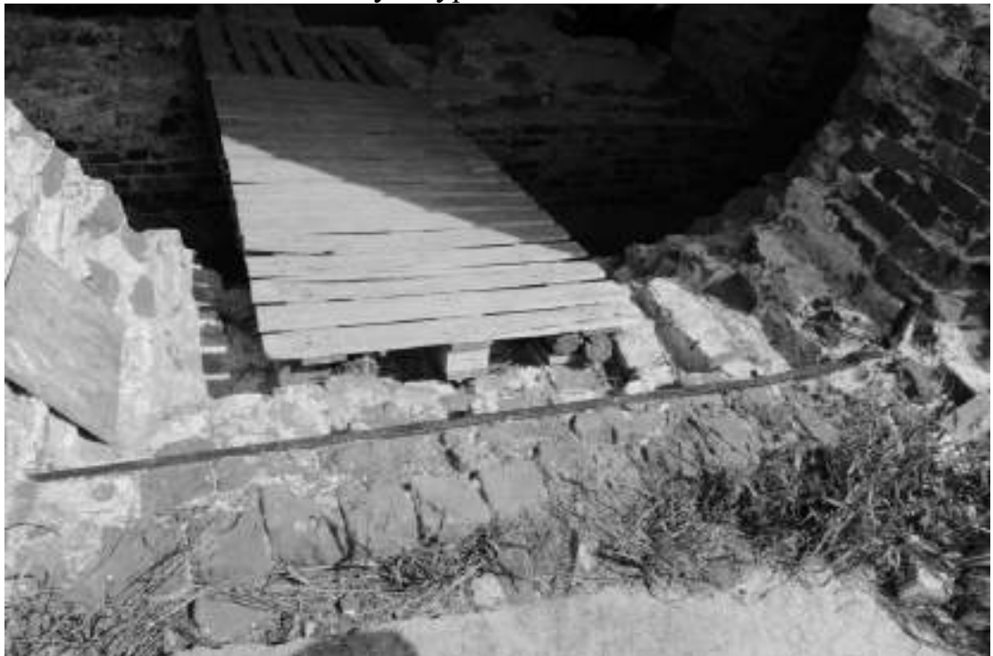
Фото 9. Отсутствие нижнего кирпича в южном дверном проходе в храм, растесанный проем, выветривание кирпича, высолы раствора, оголение стяжки
