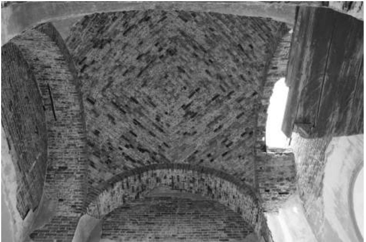
Фото 26. Отсутствие штукатурного слоя на своде, оголенная стяжка в арке, разрушение кладки проема выхода на колокольню в притворе
