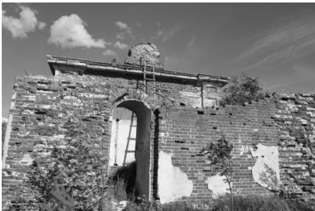
Фото 47. Отсутствие/разрушение штукатурного слоя, высолы раствора, локальное разрушение кирпичной кладки, выпадение отдельных кирпичей, поражение кирпичной кладки мхом, наличие растений на кровле, разрушение декора арочного проема, сколы карнизных плит, без изменения рабочего положения, отсутствие свода над трапезной, купола над храмом
