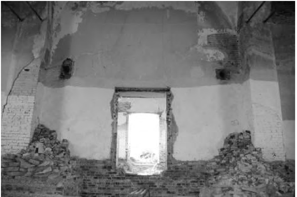
Фото 30. Сколы штукатурного слоя, высолы раствора, разрушение кладки дверного проема из трапезной в притвор, отсутствие пола, сохранившейся выходы печного дымохода, гряда кирпича от разобранного фундамента трапезной/печей
