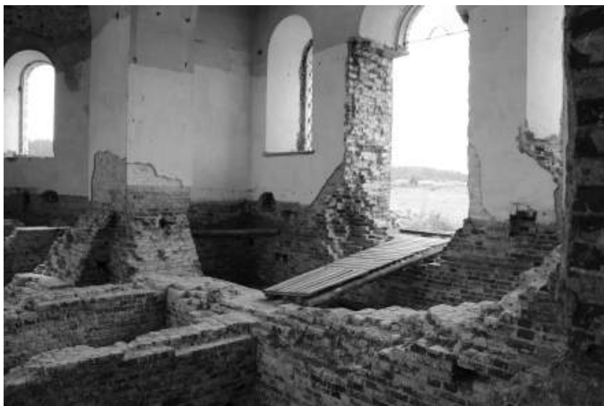
Фото 38. Отсутствие/разрушение штукатурного слоя, высолы раствора, выпадение отдельных кирпичей, выбоины в стенах, разрушение кладки дверного проема, фундамента, отсутствие пола, гнезда в стенах под лаги, разрушение декора арки дверного проема
