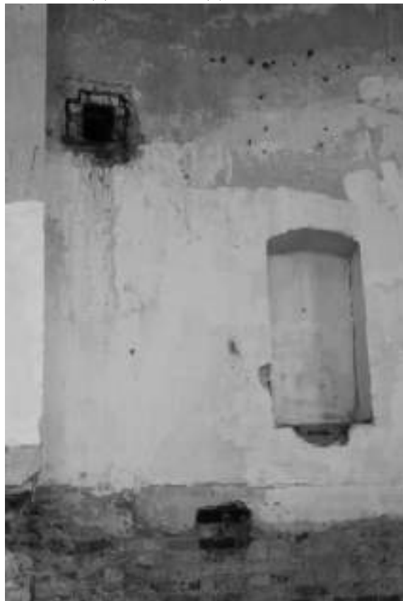
Фото 45. Отсутствие/разрушение штукатурного слоя, отверстия в стенах под лаги, сохранившийся выход печного дымохода, скол на кафельной нише
