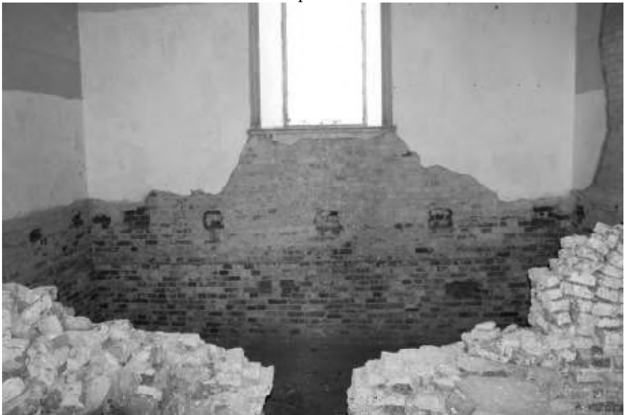
Фото 35. Локальное отсутствие, отслаивание штукатурного слоя на стенах нефы трапезной, высолы раствора, отсутствие пола, гнезда в стенах под лаги, остатки деревянного плинтуса, частичное разрушение кирпичной кладки фундамента, отсутствие оконного заполнения
