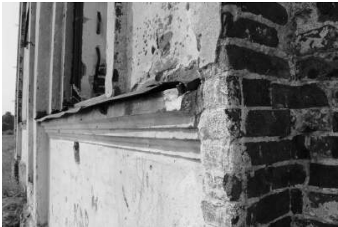
Фото 11. Отсутствие/разрушение штукатурного слоя, повреждение карниза, выветривание кирпича
