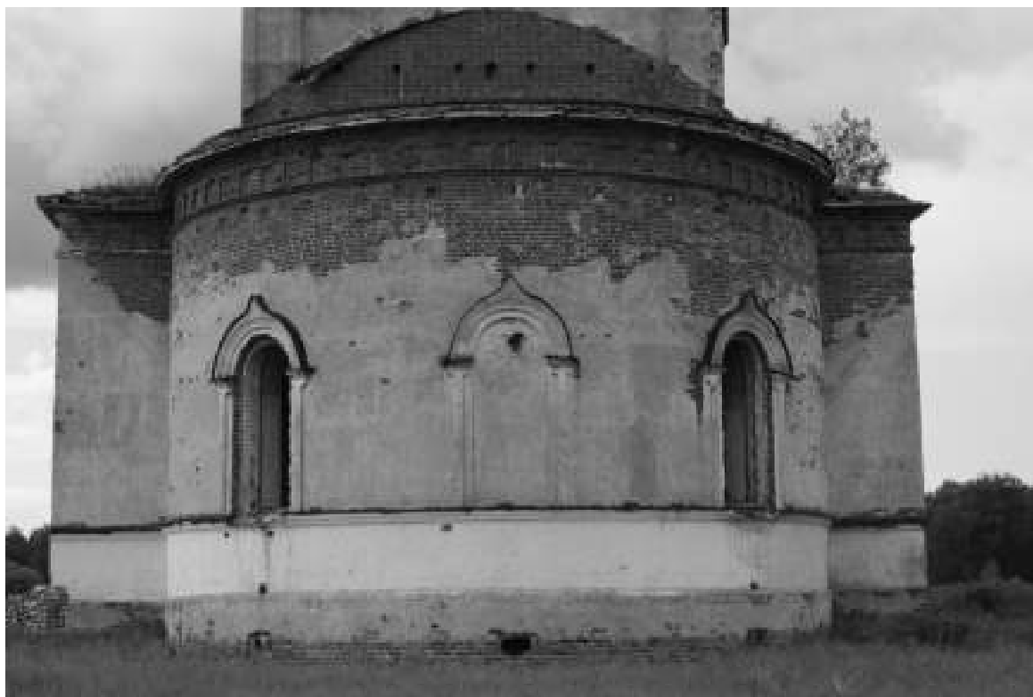
Фото 6. Отсутствие/разрушение штукатурного слоя, выветривание кирпича, выщелачивание солей из раствора, трещины под оконными проемами окон апсиды, отсутствие оконных решеток, отсутствие/разрушение карниза, выбоины в стене, отсутствие оконного заполнения, свода над апсидой, сколы карнизных плит, без сдвига с рабочего положения
