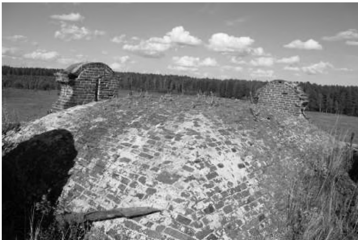
Фото 54. Высолы раствора, аттики подвержены выветриванию кирпича, поражение кирпича мхом, отсутствие купола над храмом
