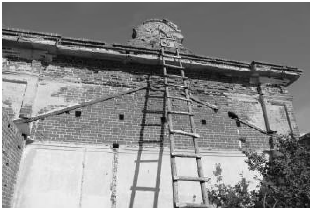
Фото 50. Отсутствие/разрушение штукатурного слоя, высолы раствора, наличие растений на втором этаже, сколы карнизных плит, без изменения рабочего положения, аттик и стены подвержены выветриванию кирпича, разрушение пилястров под карнизом, гнезда под лаги
