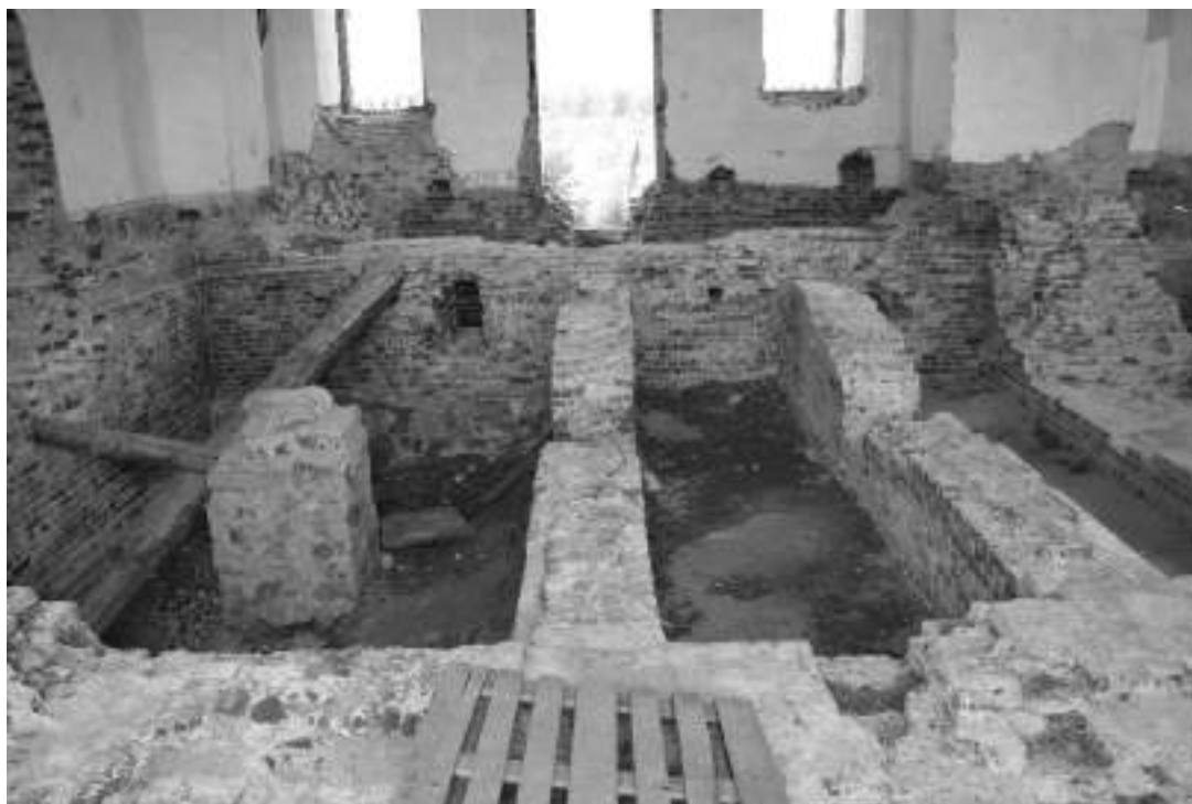
Фото 40. Отсутствие/разрушение штукатурного слоя, высолы раствора, локальное разрушение кирпичной и бутовой части фундамента, гнезда в стенах под лаги, отсутствие пола, деревянные лаги не на своих местах
