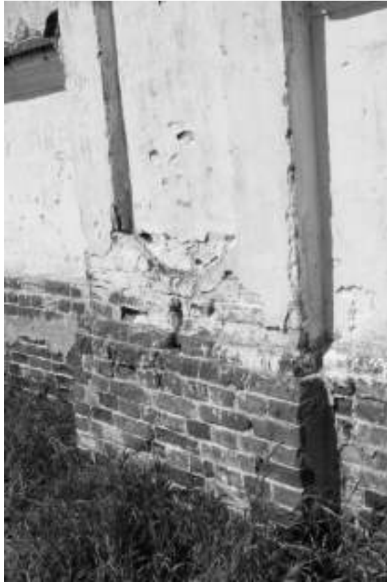
Фото 8. Выбоены, выдавливание кирпича в пилястре, отсутствие штукатурного слоя, выветривание кирпичей, отсутствие/разрушение штукатурного слоя
