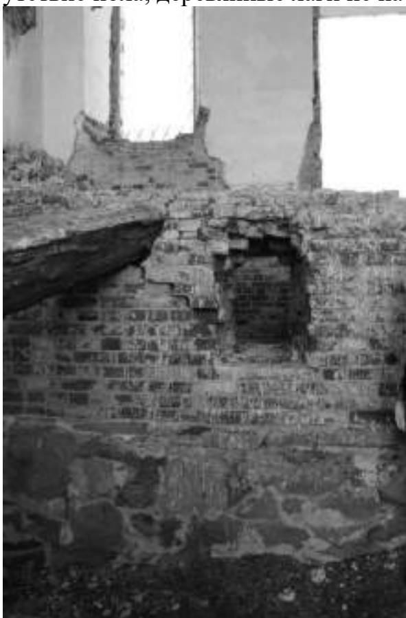
Фото 41. Косая трещина в кирпичной кладке фундамента храма, пересекающая более двух рядов кладки, остатки деревянной лаги, сколы бутового фундамента, частичное разрушение кирпичной кладки фундамента, отсутствие/разрушение штукатурного слоя
