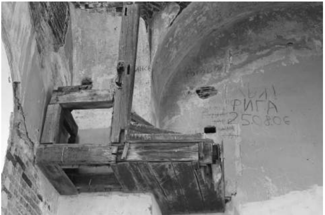
Фото 27. Остатки разрушенной деревянной лестницы притвора, сколы штукатурного слоя, гнездо в стене под перила лестницы, выцветание краски
