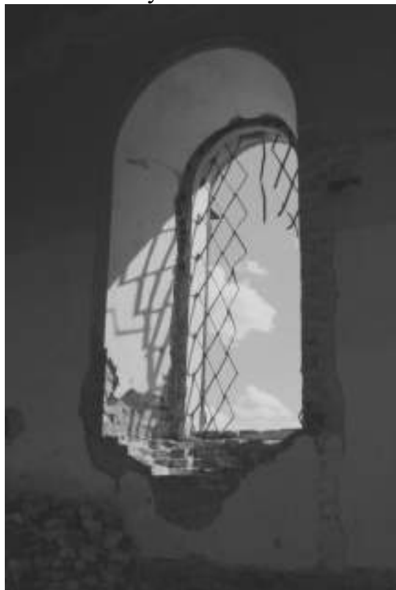
Фото 21. Отсутствие/разрушение штукатурного слоя, разрушение кладки подоконной части, разрушение оконной решетки, отсутствие оконного заполнения
