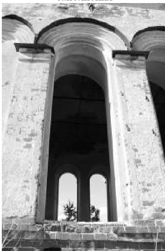
Фото 53. Выветривание штукатурного слоя, высолы раствора, выветривание кирпича подоконной части, отсутствие оконного заполнения, деформация металлического обрамления окна
