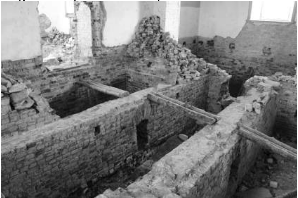
Фото 33. Отсутствие/разрушение/сколы штукатурного слоя, высолы раствора, отсутствие пола, гнезда в стенах под лаги, частичное разрушение кирпичной кладки фундамента, груда кирпича от разобранного фундамента трапезной/печей
