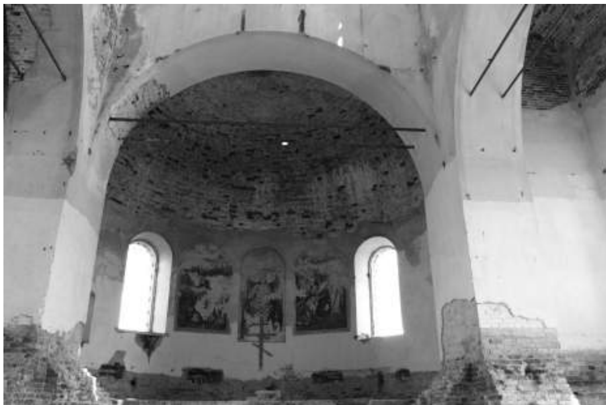
Фото 36. Отсутствие/разрушение штукатурного слоя, высолы раствора, выпадение отдельных кирпичей несущих колонн храма, выбоины в колоннах, гнезда под лаги в алтарной части
