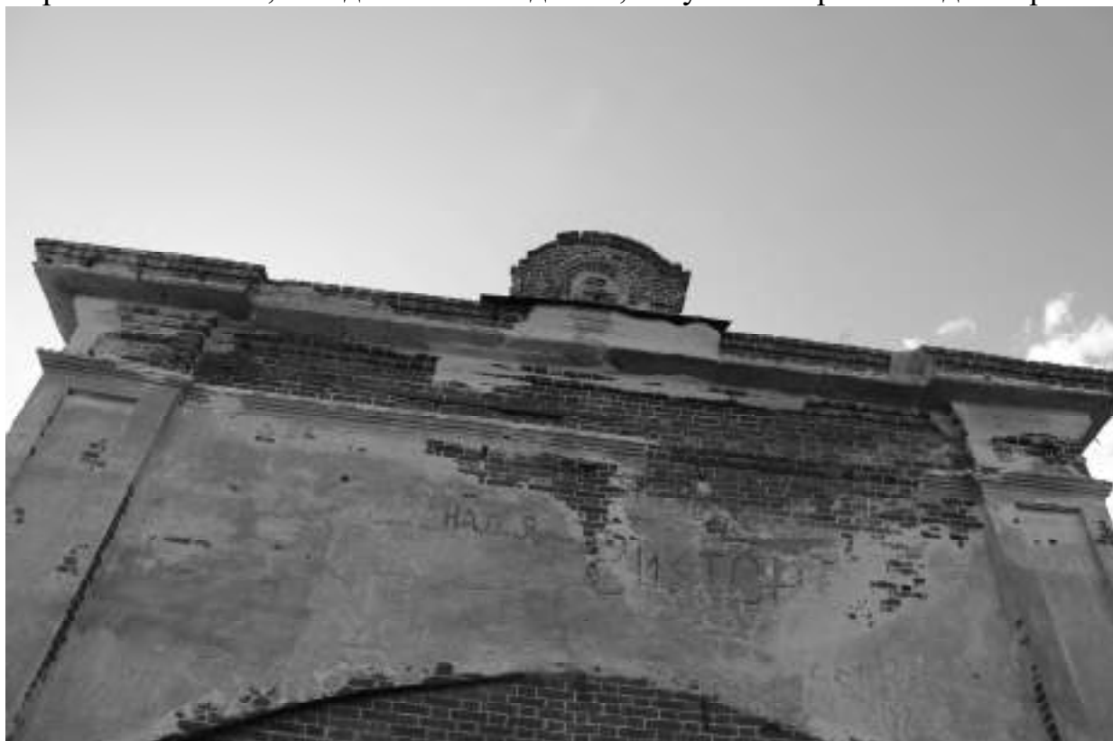
Фото 57. Отсутствие/разрушение штукатурного слоя, высолы раствора, сколы карнизных плит, рабочее положение без изменения, выветривание кирпича, выпадение отдельных кирпичей из аттика, разрушение пилястров под карнизом
