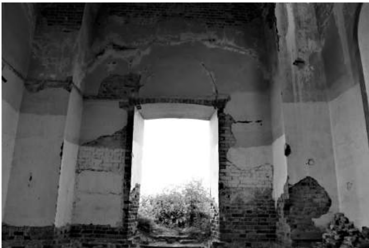
Фото 22. Разрушение штукатурного слоя, высолы раствора, выветривание, выпадение отдельных кирпичей несущей колонны притвора, волосяные трещины, выбоины, заложенная полуциркульная арка над входом
