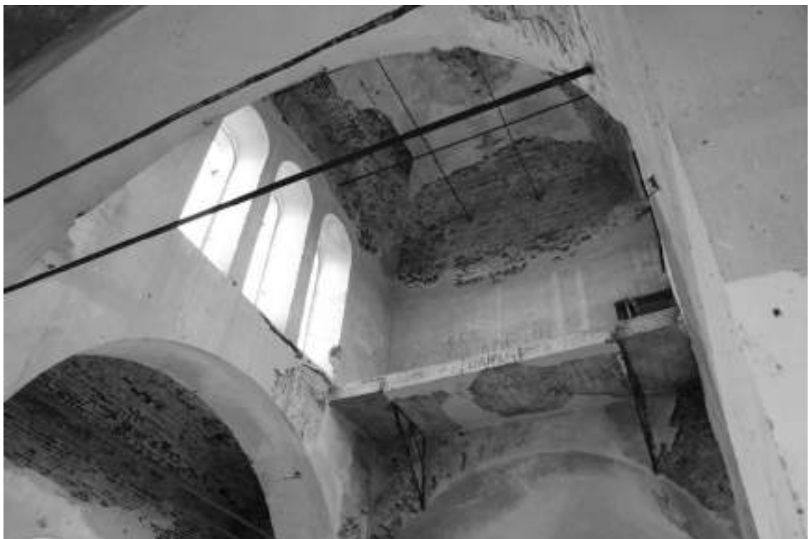
Фото 43. Разрушение, отсутствие штукатурного слоя на своде, поддерживающие хоры металлические уголки поражены ржавчиной
