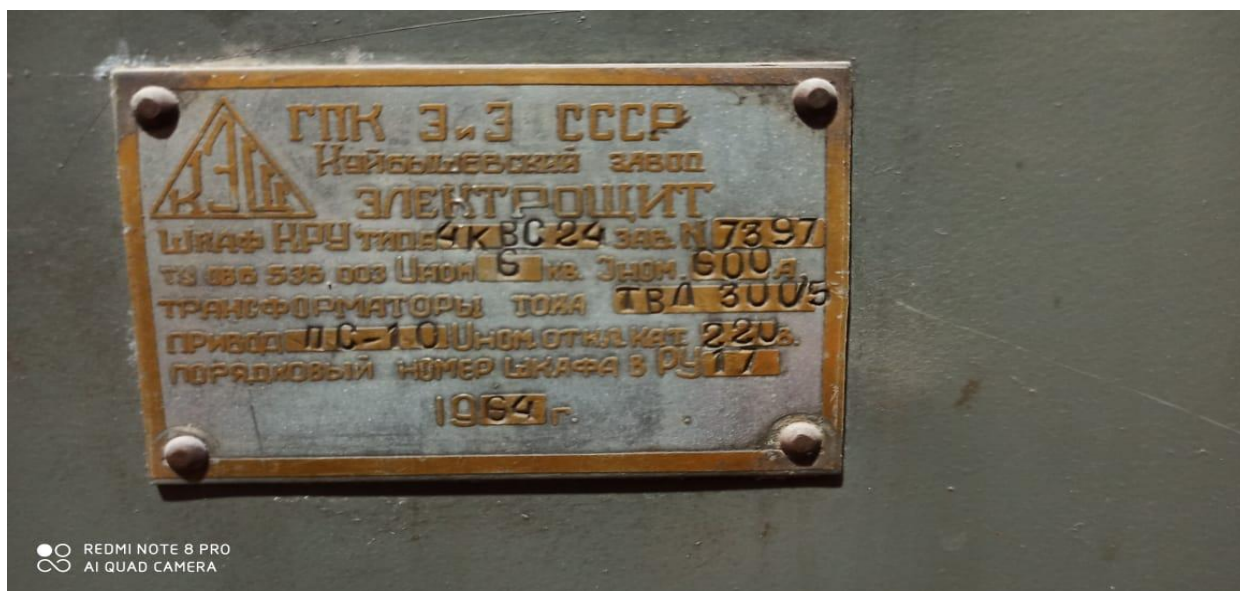
Рисунок 1 – Вид маркировки на камере КРУ-6 кВ
