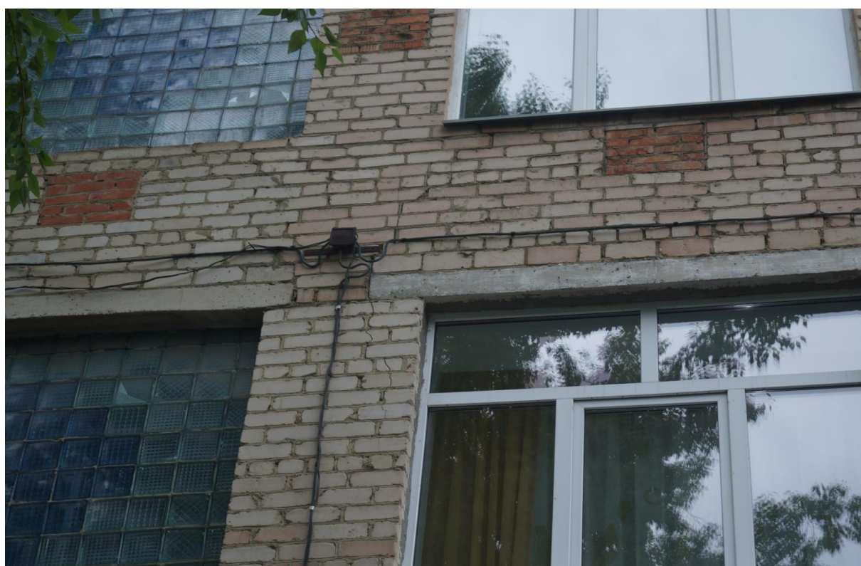
Рисунок 2 – трещина на фасаде по оси 15
