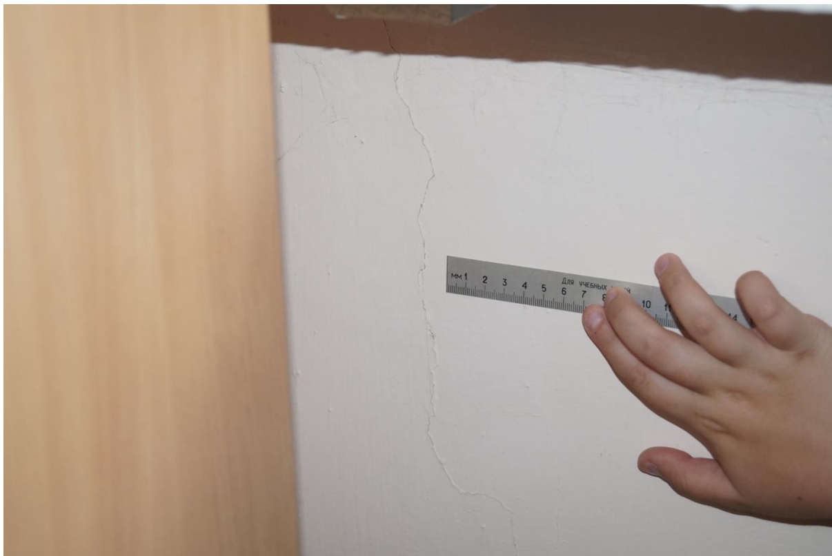
Рисунок 5 – трещина внутри на втором этаже
