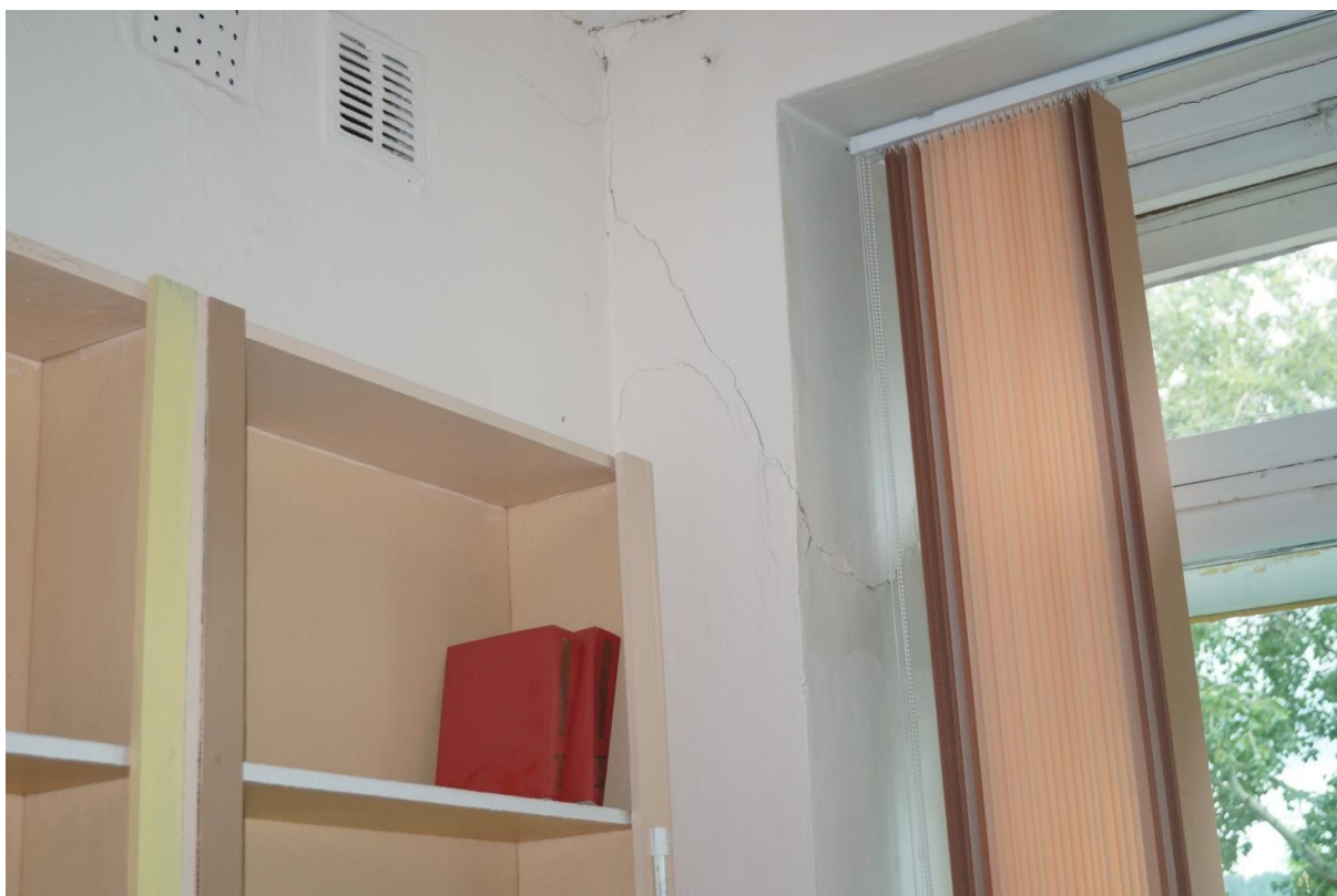
Рисунок 6 – трещина внутри третий этаж
