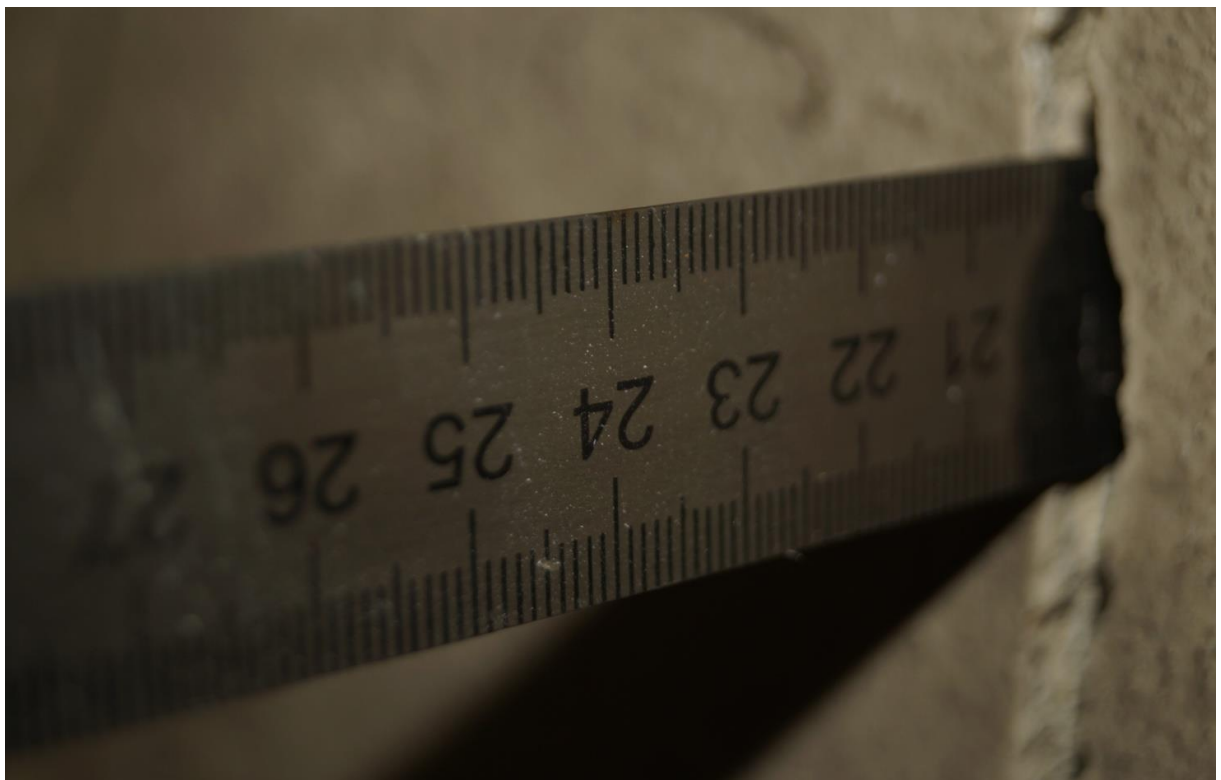
Рисунок 4 – глубина трещины внутри на первом этаже
