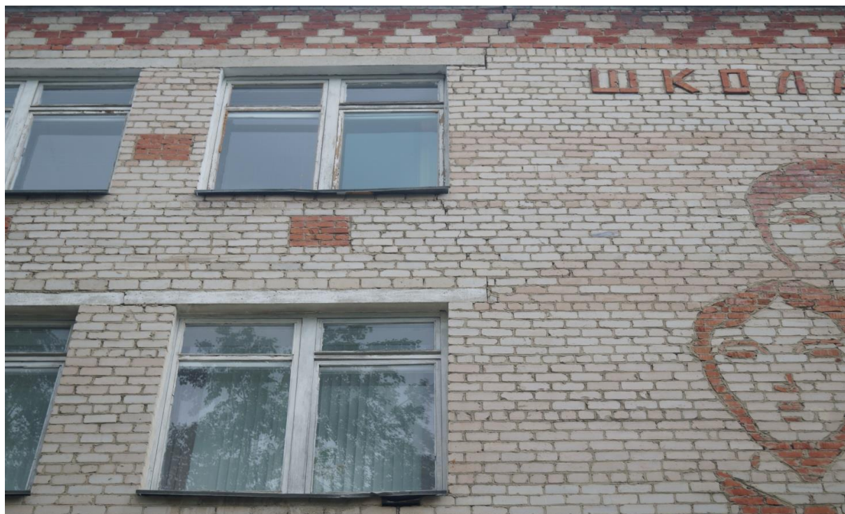
Рисунок 1 – трещина на фасаде по оси X
