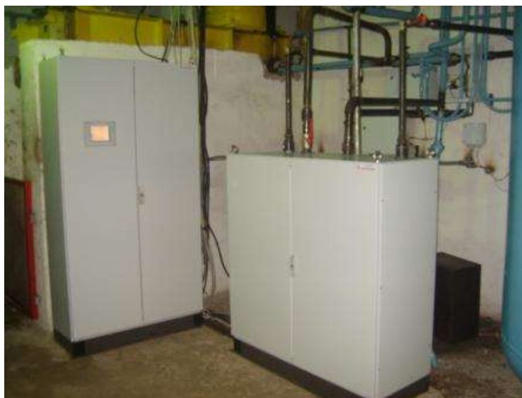
Рисунок 2.10 – Общий вид шкафов панели тормоза и блока управления тормозом
