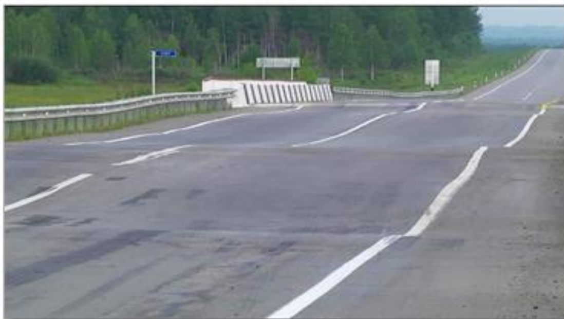
Рисунок 9 – Поперечные деформации покрытия дорожной одежды
