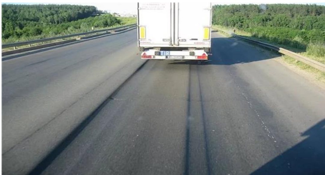
Рисунок 20 – Прогиб дорожного полотна от тяжелых транспортных средств
