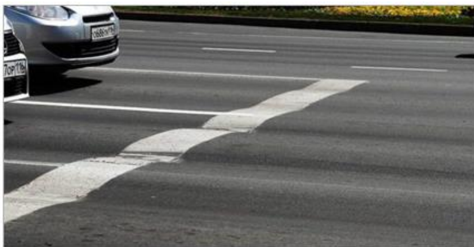
Рисунок 8 – Фотография колеи на покрытии дорожной одежды
