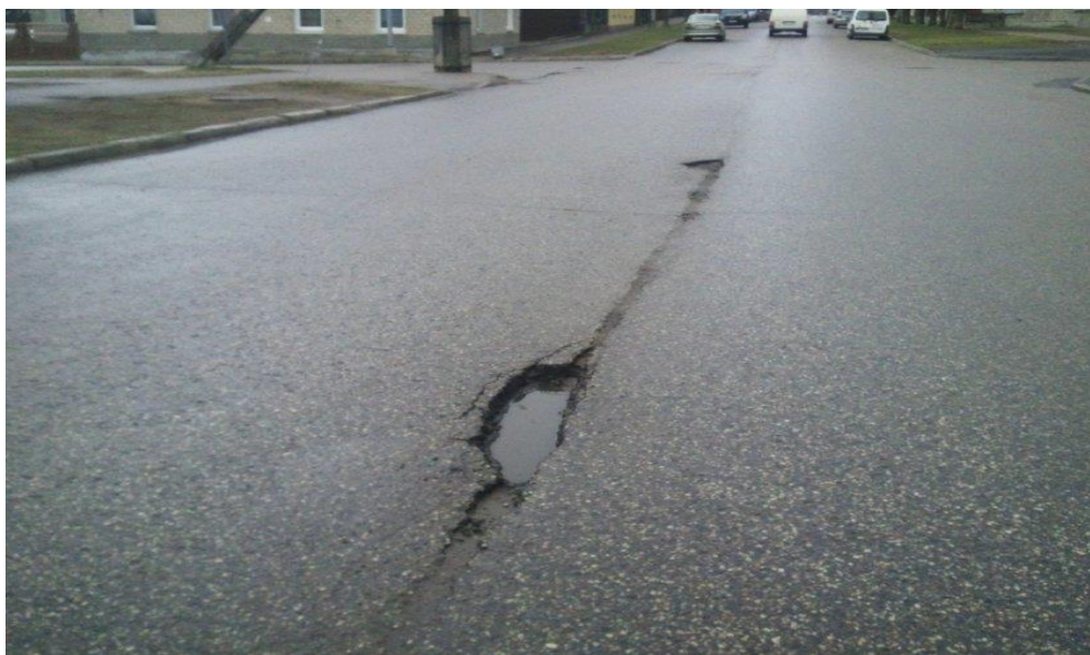
Рисунок 10 – Пример перехода трещин или раковин в выбоины
