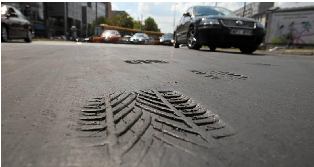
Рисунок 16 – Появление дефектов при высокой температуре воздуха
