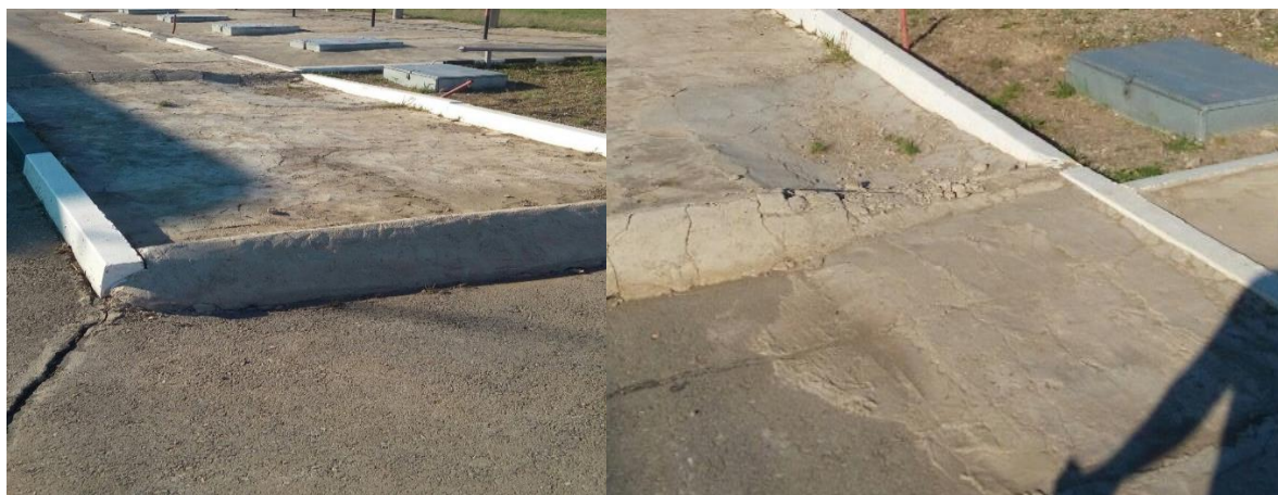
Рисунок 6 – Состояние отбортовки на площадке для АЦ
