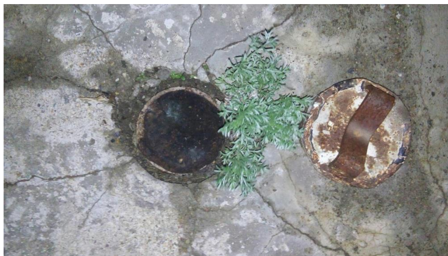
Рисунок 7 – Неисправный трубопровод аварийного слива
