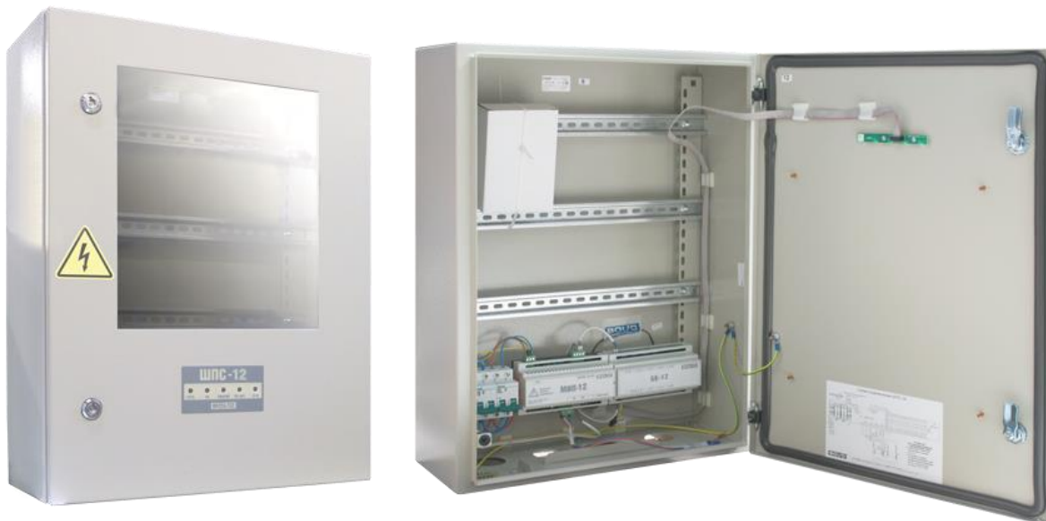
Рисунок 14 – Шкаф управления пожарной сигнализацией ШПС–12
