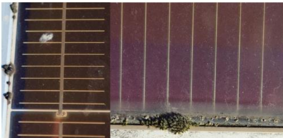
Рис.5.14. Пример птичьего помета (слева) и мха (справа) на фотоэлектрическом модуле.
