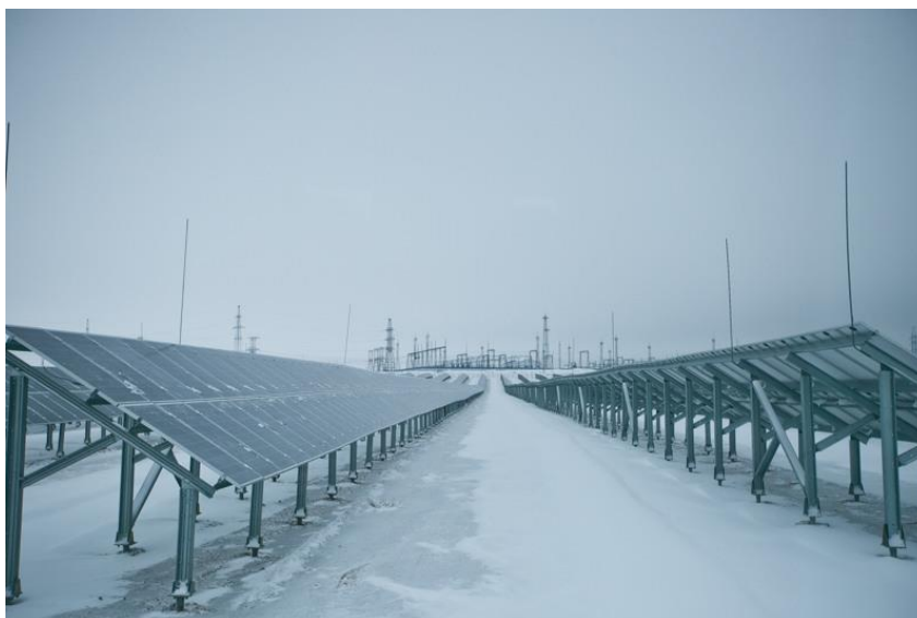
Рисунок 3.3 – Орская солнечная фотоэлектрическая станция имени Александра Влазнева
