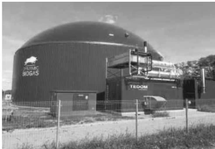
Рисунок 4.5 – Применение когенерационной установки Cento, установленная на биогазовой станции Przybroda Польша
