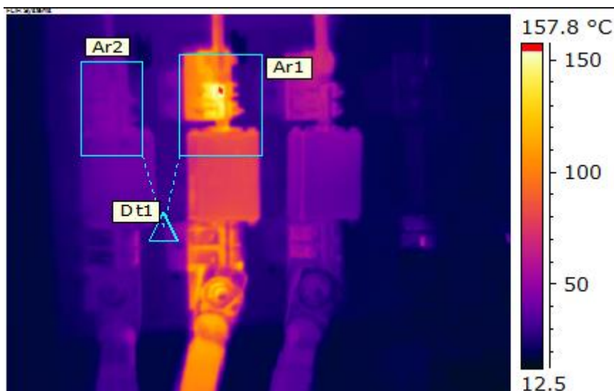
Рисунок 11. Термограмма оборудования ТП-1143 РУ 0,4кВ 1С гр.2 ПН 0,4кВ фазы «В».
