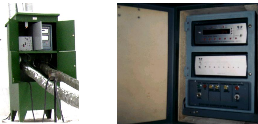
Рис. 3. Автоматизированная система контроля и управления параметрами воздуха (АСКУ – ТЛГХ)
