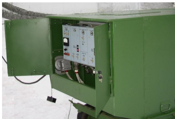
Рис. 2. Высоконапорная установка осушения воздуха (ВУОВ – ТЛГХ)
